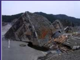
転倒した堤防
