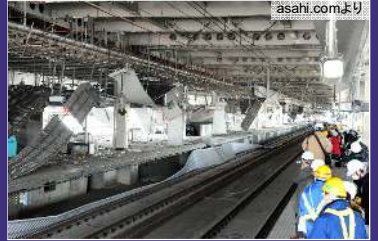
天井材の落下
