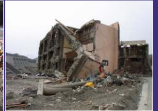
転倒したCB造住宅
