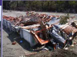
崩壊した鉄骨造体育館
