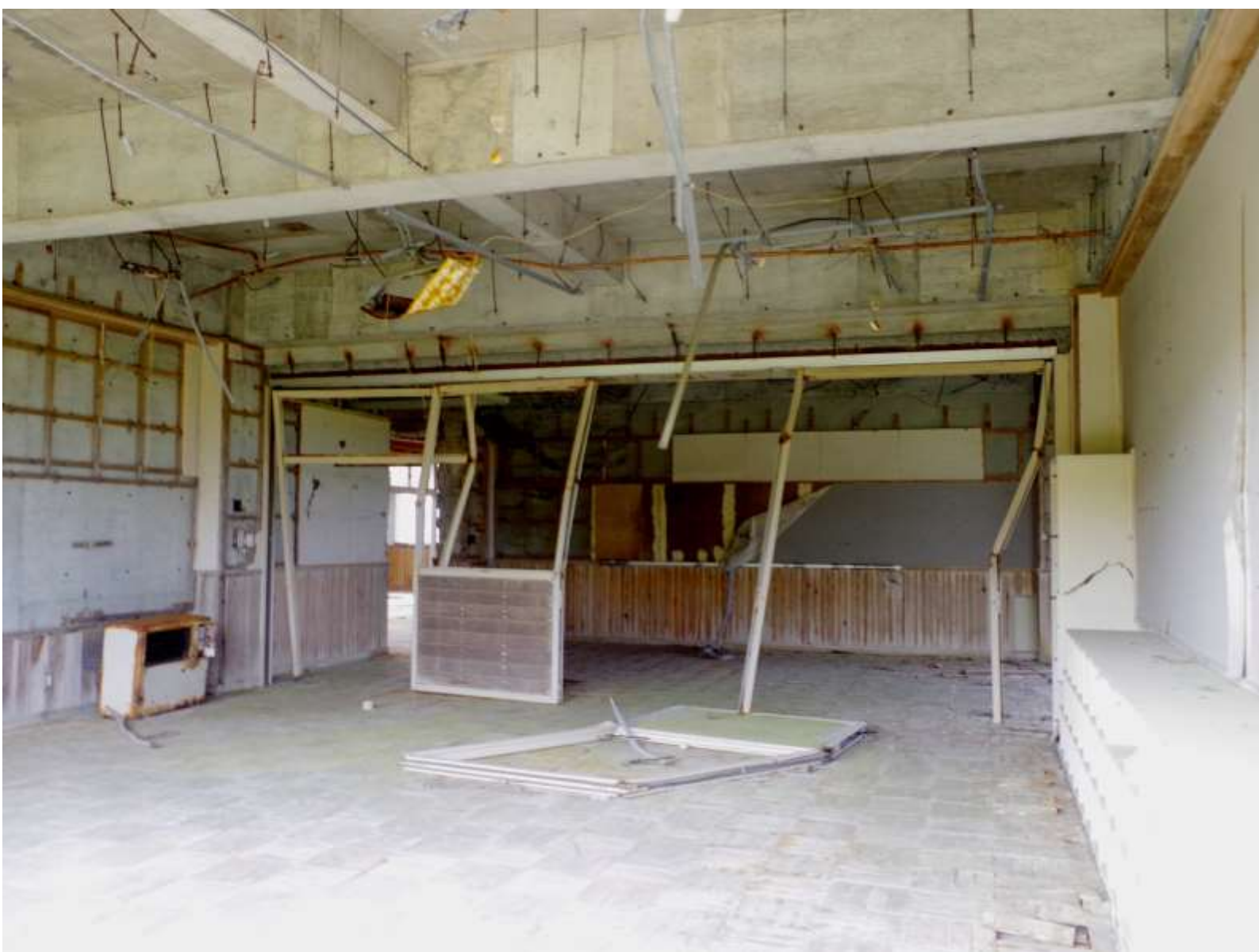
被害の小さい構造体と被害の大きい非構造部材 (宮城県 中浜小学校)
