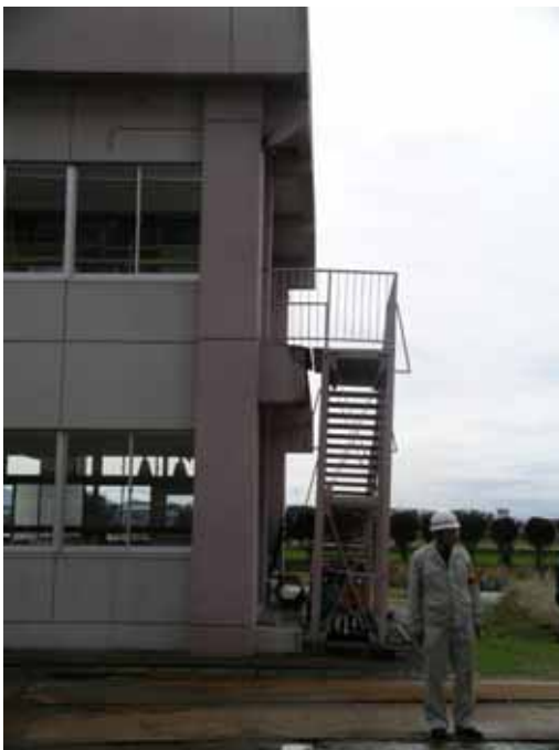
普通教室棟の S 造外部階段の傾斜
