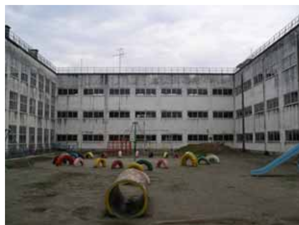
普通教室棟間の中庭（右棟柱に若干の被害）
