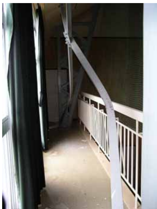
ブレースの座屈
