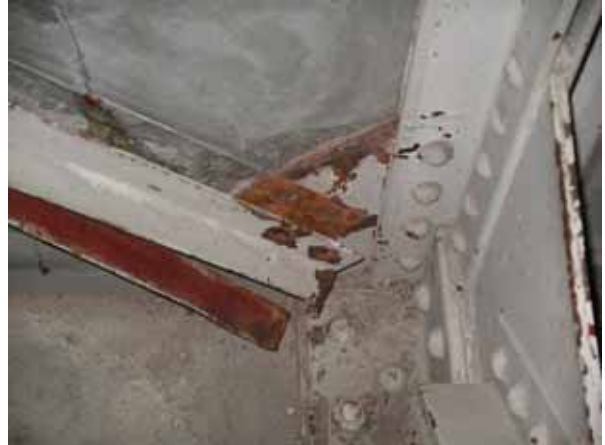
ブレースボルト破断
