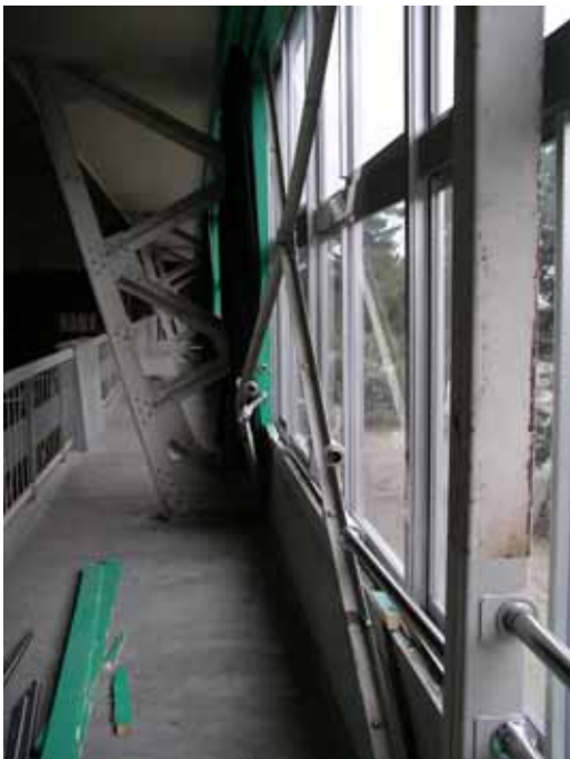
ブレースの座屈
