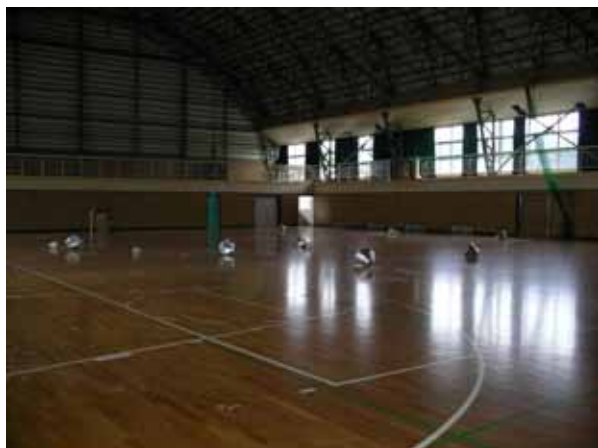
照明器具の落下（10/27の余震でさらに被害）
