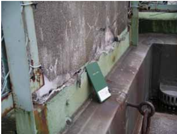
煙突が外側にずれる
