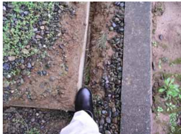
渡り廊下棟周辺の地盤変状の状況
