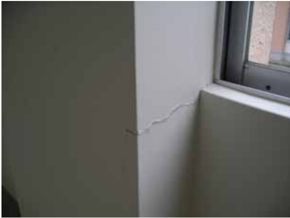
補強ブレースの直上階の柱には若干ひび割れが生じている
