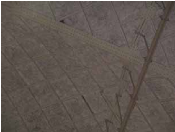
天井材の若干のずれが見られる
