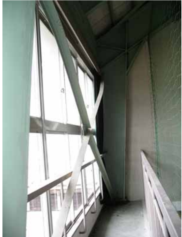
ブレースの座屈
