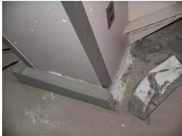
屋内運動場 ( S3 ) ( 中央部の柱周辺モルタルの被害 / この種の被害は中央部分のみ )
