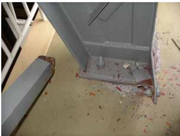
ブレースの破断
