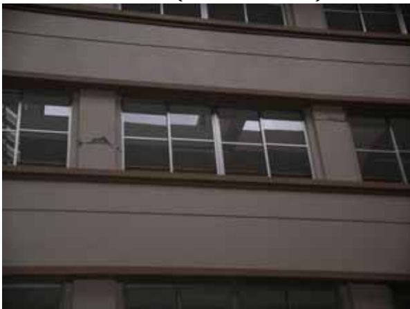
普通教室側3階柱の被害（アトリウムから）
