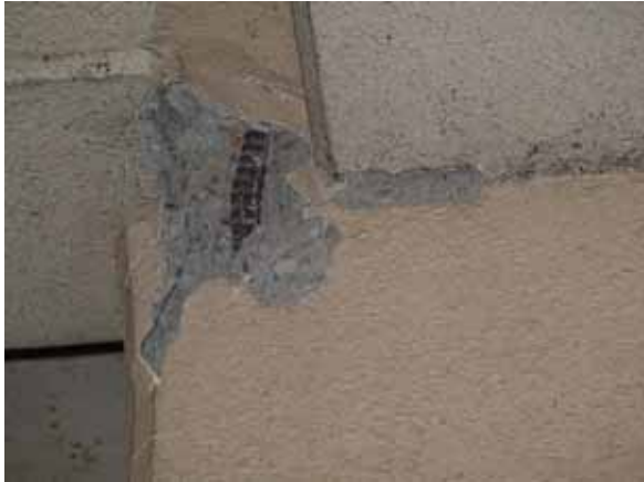
柱頭で損傷度
