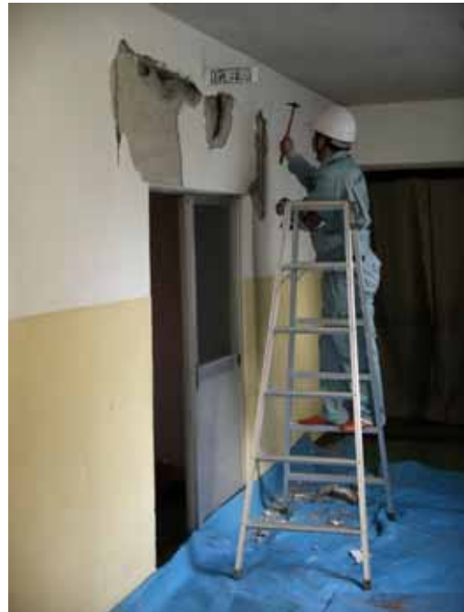
渡り廊下便所入り口の梁の損傷
