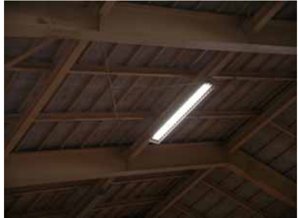
天井ブレースの垂れ下がり
