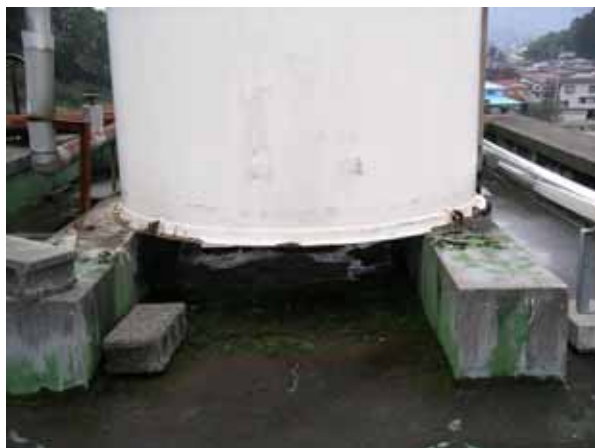
高架水槽の被害
