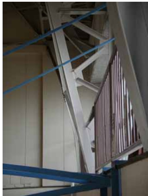
屋内運動場のブレースの座屈
