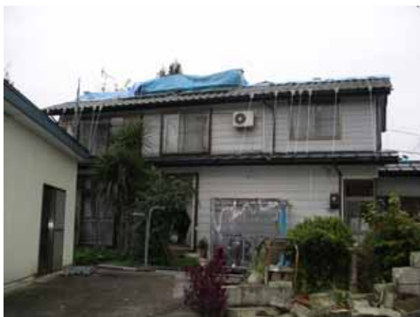
周辺民家の被害
