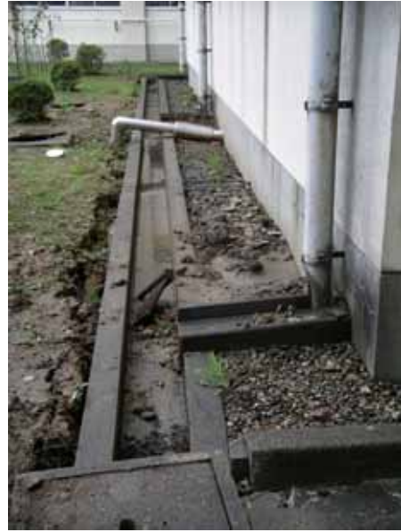
西側構面の沈下跡（配管が沈下により傾斜）
