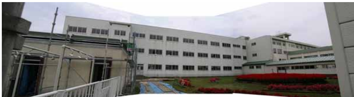
管理教室棟～屋内運動場の中庭（管理教室棟の1階柱にせん断ひび割れ）
