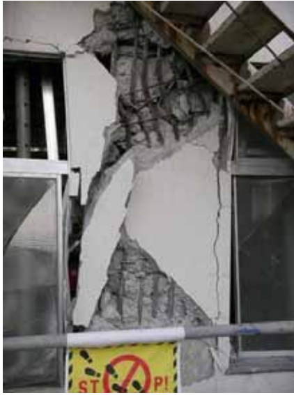
写真 13-3 柱主筋の座屈
