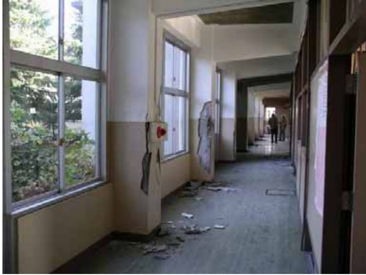
写真 12-7 大破した校舎の内部
