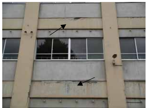
経年劣化による仕上げモルタルの浮き上がり が地震により拡大したと思われる
