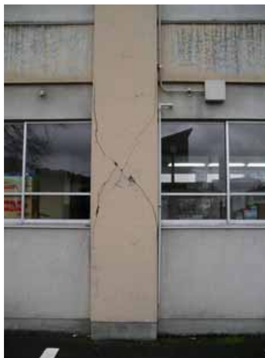
内観調査では、損傷度 （内観：写真 3-4）
