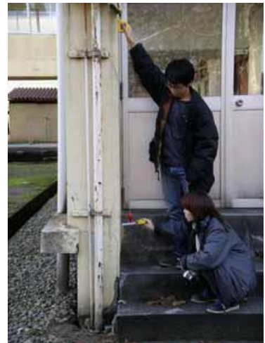
写真 11-6 校舎の傾きの計測
