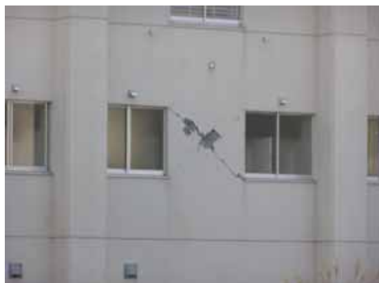
写真 6-3 2階雑壁に被害
