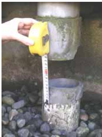
写真 11-12 校舎の回転により切断されたドレイン
