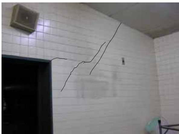
ひび割れ状況を加筆により強調表示 武道場 1 階 厨房西面 写真 1-6 柱なし壁 ( 損傷度 )
