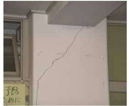
(c) 損傷度 仕上げひび割れ幅：1.5mm、
