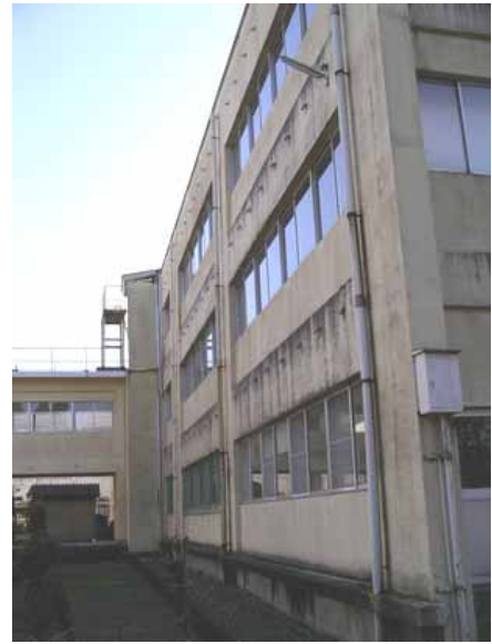
写真 11-4 基礎に被害が生じた校舎
