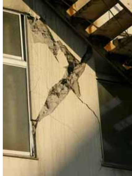
写真 13-6 2階の柱の被害
