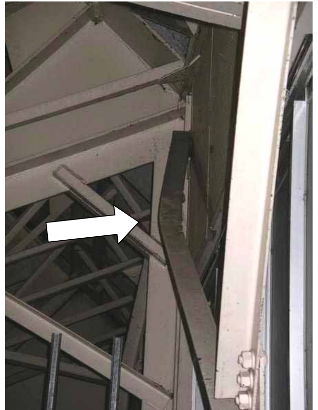
写真 2-6 ブレースの座屈
