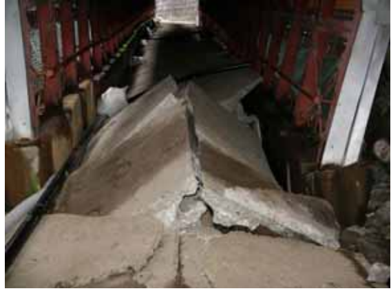
右：線路下のトンネル路面の被害
