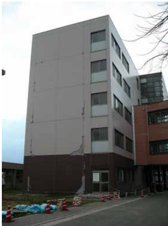
左奥の斜面側が沈下 写真 9-3 6号館テクノセンター
