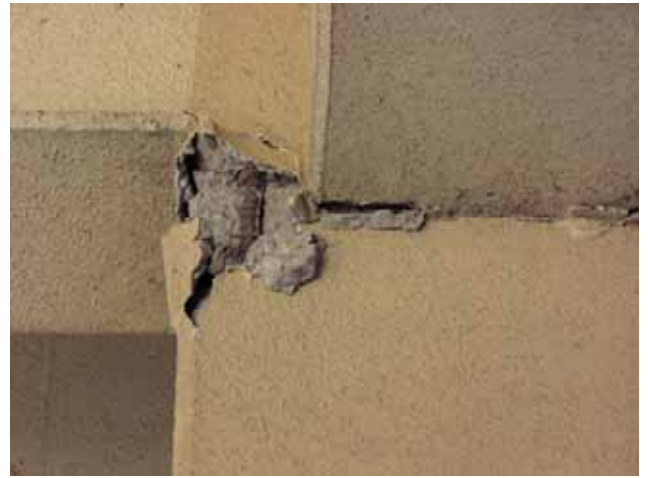
クローズアップ(主筋の座屈)
