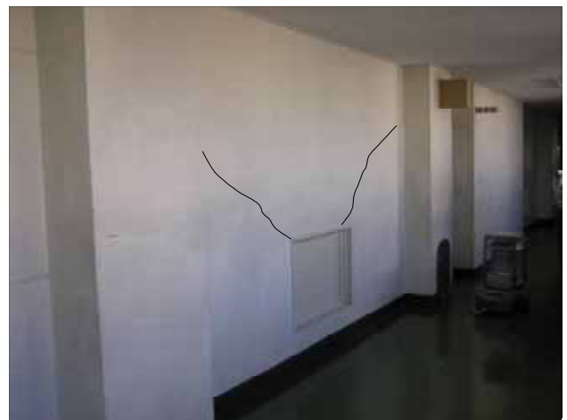
ひび割れ状況を加筆により強調表示 写真 5-4 3階中構面 両側柱付壁 ( 損傷度 )
