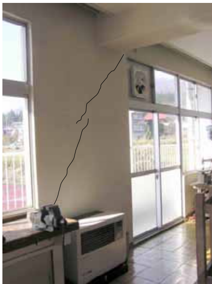
ひび割れ状況を加筆により強調表示 写真 5-3 2階柱型付壁 ( 損傷度 )
