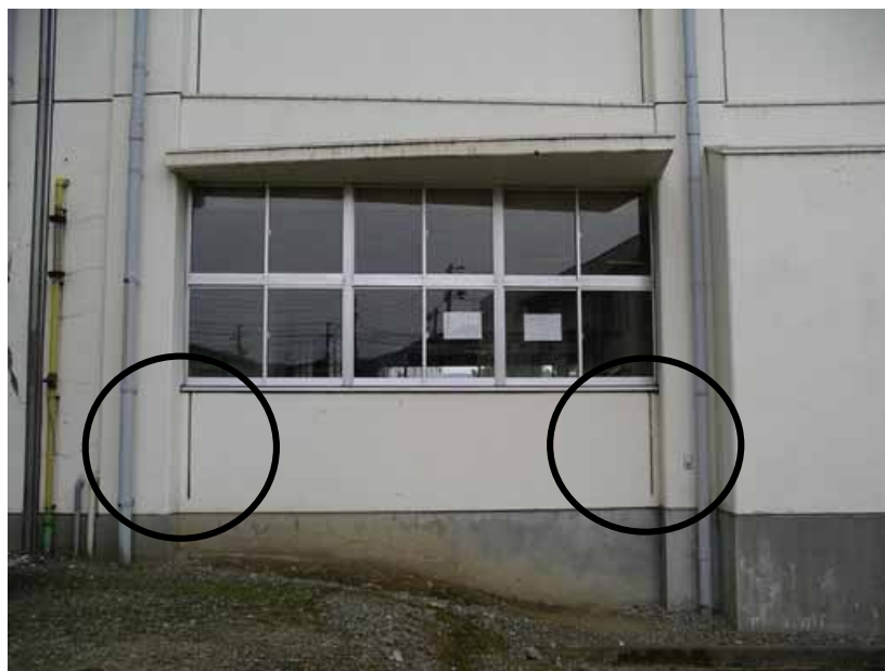
写真 4-2 管理・普通教室棟の構造スリット
