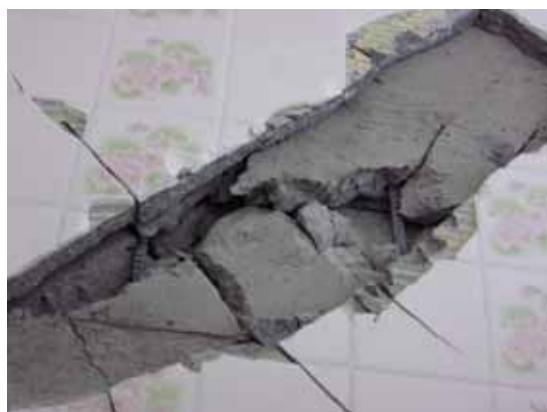
写真 6-4 写真 6-3 内観 (損傷度 )
