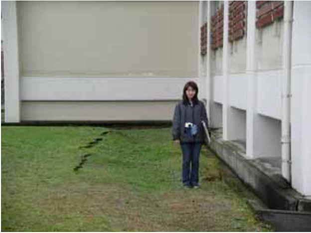
地盤が大きく陥没
