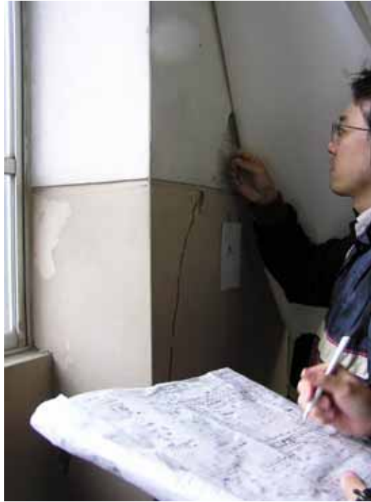
計測したひび割れ幅は 5 mm 超
