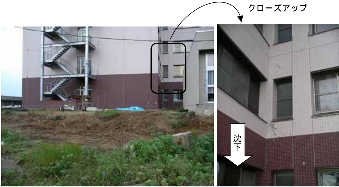
左ブロックの沈下による梁のせん断ひび割れ 写真 9-4 6号館テクノセンター
