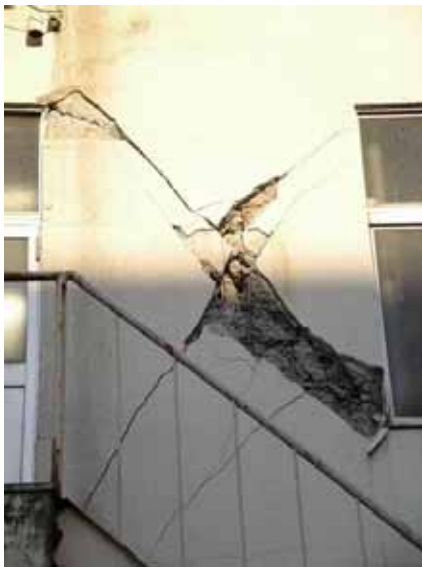
写真 13-5 2階の柱も被害
