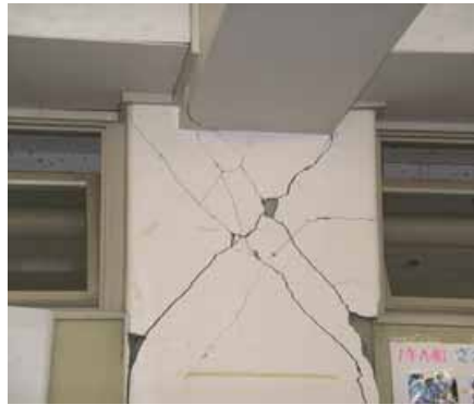
(b) 損傷度 躯体ひび割れ幅 2.0mm
