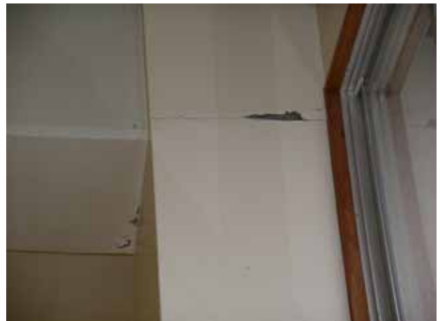
写真 6-7 打ち継ぎと PS の影響と思われるひび割れ
