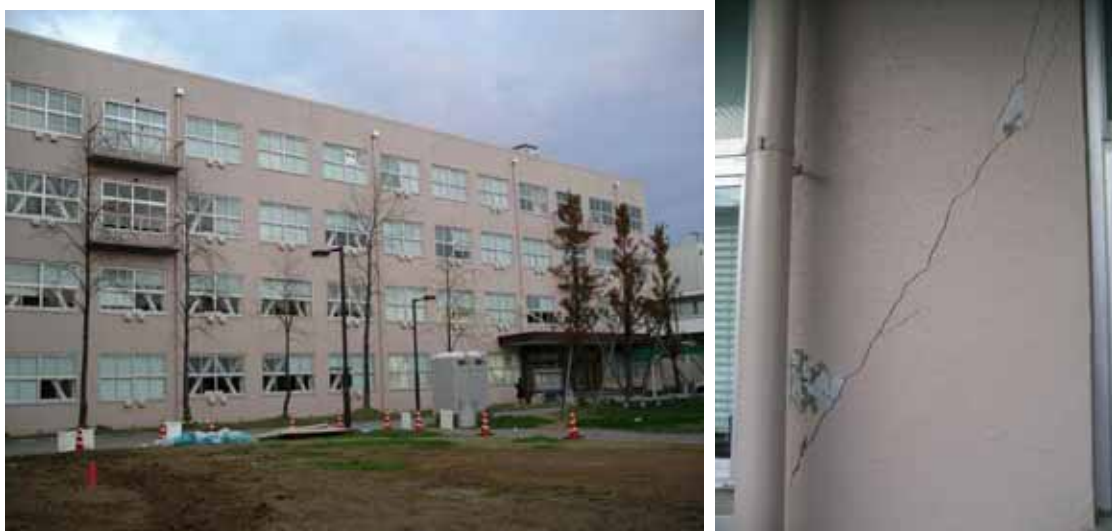
正面玄関右側の柱に明瞭なせん断ひび割れ
