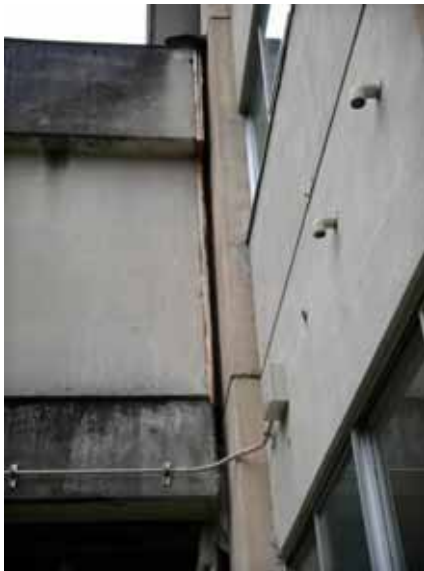
写真 3-10 経年劣化による損傷の拡大
