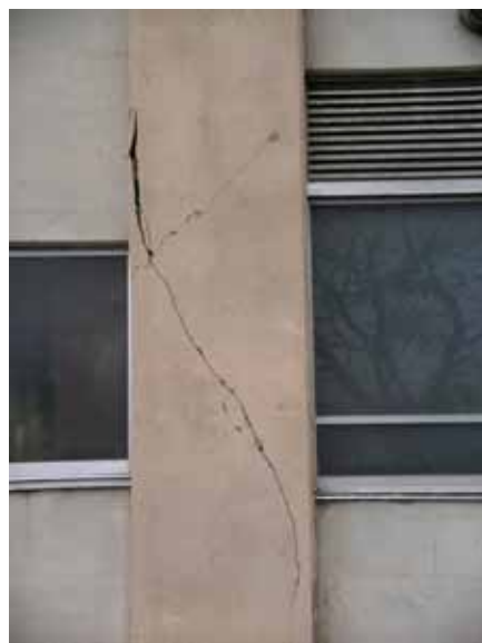
内観調査では、損傷度 写真 3-8 柱の短柱化(外観:損傷度)
