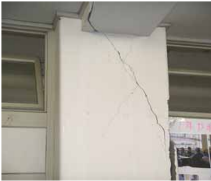
(a) 損傷度 躯体ひび割れ幅 1.5mm
