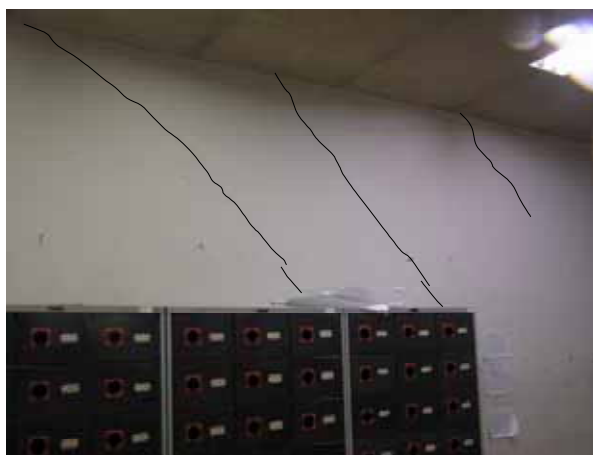
ひび割れ状況を加筆により強調表示 武道場 1 階 食堂 写真 1-4 両端柱付壁 ( 損傷度 )
