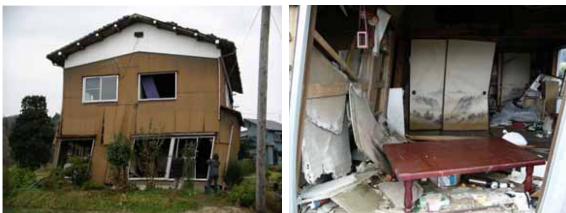
写真 8-2 傾斜した住家の内部の被害
