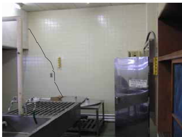
ひび割れ状況を加筆により強調表示 武道場 1 階 厨房東面 写真 1-5 片側柱付壁 ( 損傷度 )
