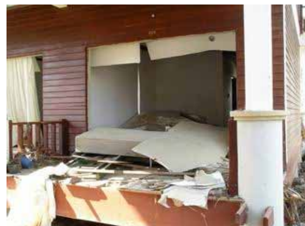
写真 5.7-4 : 1 階の被害（建物群 ）
