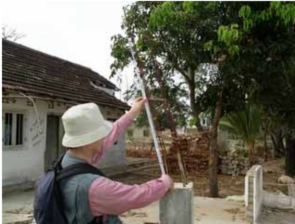
写真 4.1-4：住家の門柱（露出主筋が津波で湾曲）
