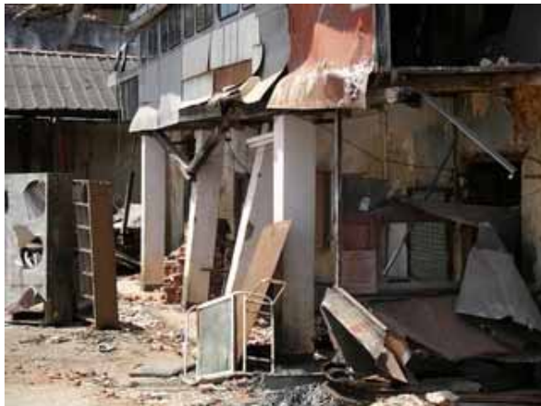
写真 4.6-1：損傷した柱（中央 2 本）
