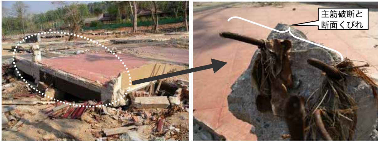
写真 5.7-8：主筋破断を伴う柱の曲げ破壊
