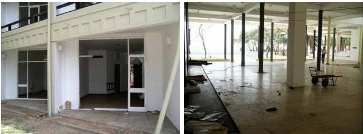
写真 4.24-1：ロビーおよび客室の被害
