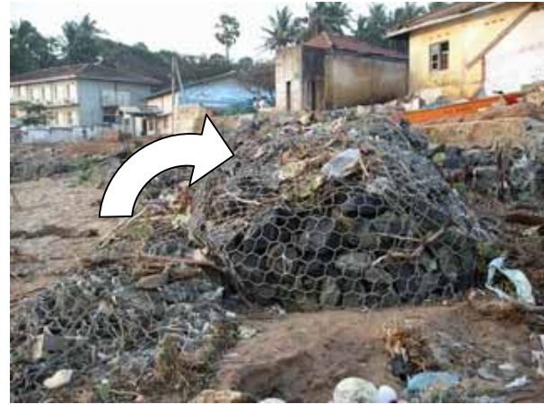
写真 4.14-4：海岸側の石積み堤防の被害
