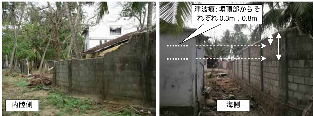
写真 4.7-2：ブロックの被害の詳細（上3段のみが破壊している箇所も見られる）
