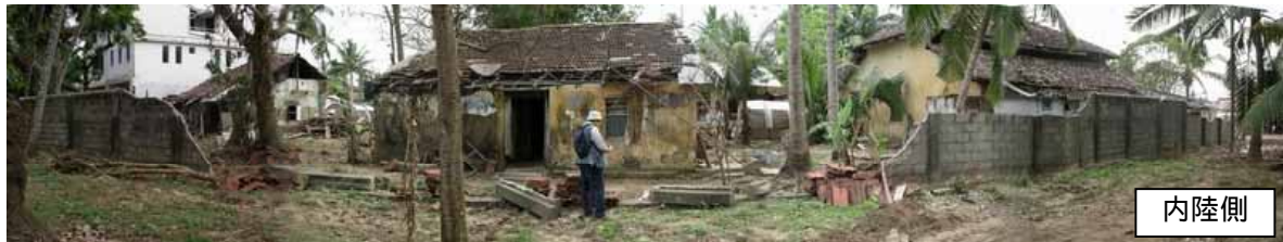
写真 4.7-1：6 スパンが倒壊した隣地境界塀
