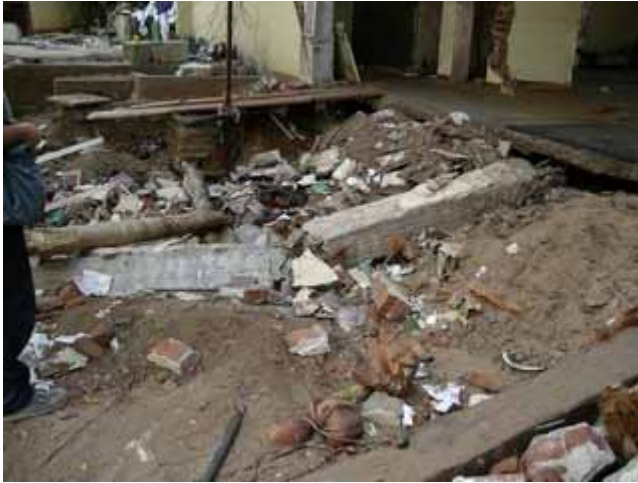
写真 4.16-7：写真 4.16-6 の柱（中央で折損）
