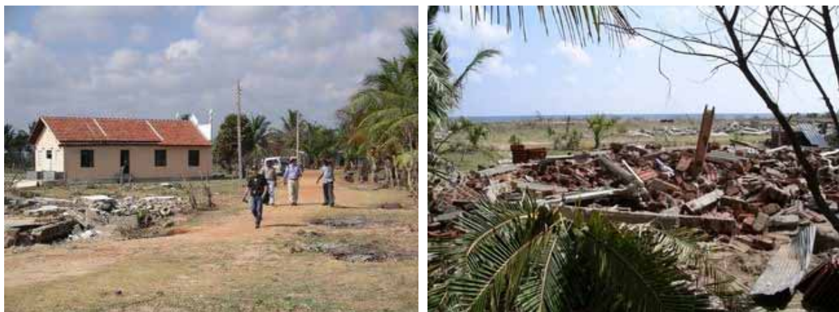
写真 4.3-2 : 津波で屋根が被害を受けたイスラム教会
