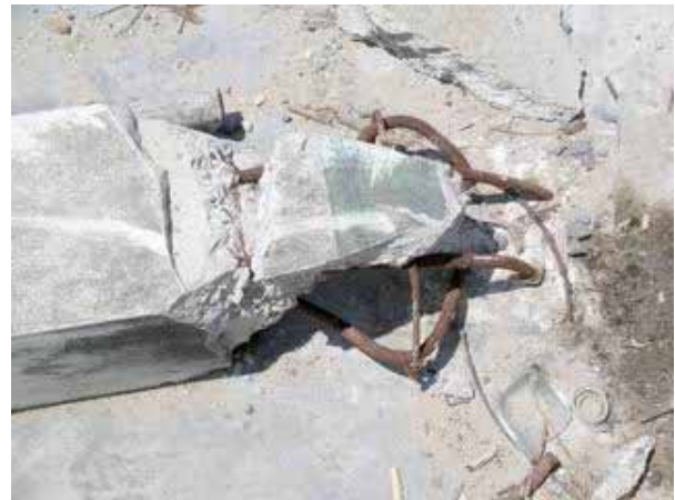
写真 5.6-2：倒壊した柱のクローズアップ
