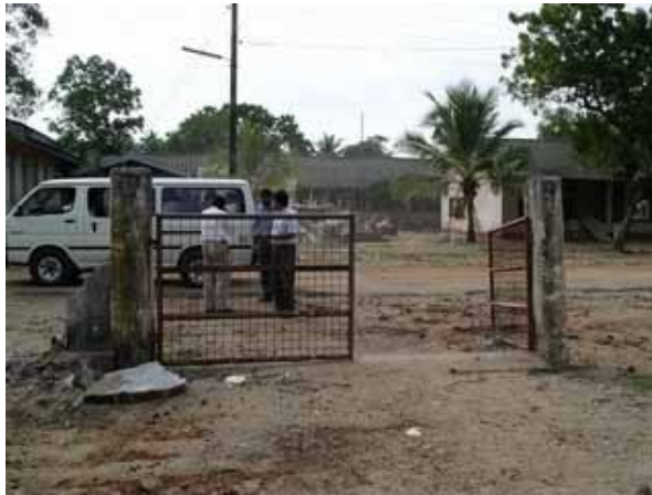
写真 4.1-1：門柱2本 / 左は健全，右は傾斜
