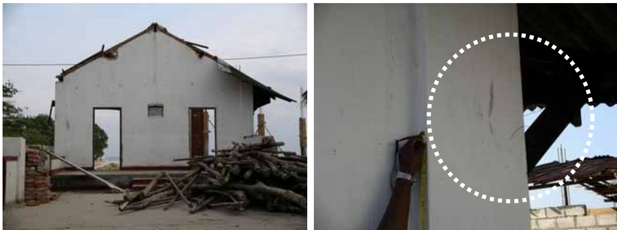
写真 4.8-3：海岸線と平行する壁と柱型上部の衝突痕
