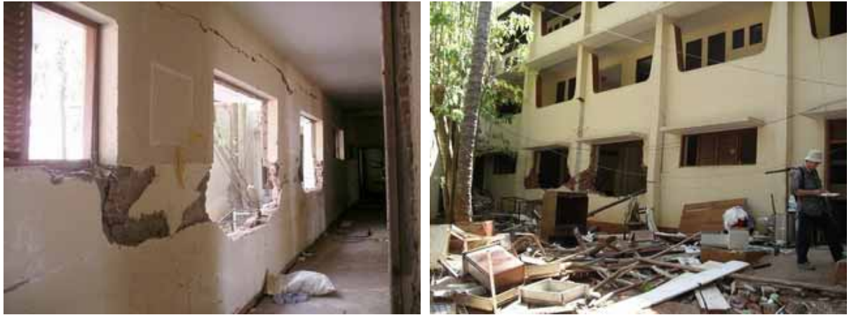
写真 4.16-5：建物西側廊下側レンガ壁（4スパン）の被害（左：内観／右：外観）
