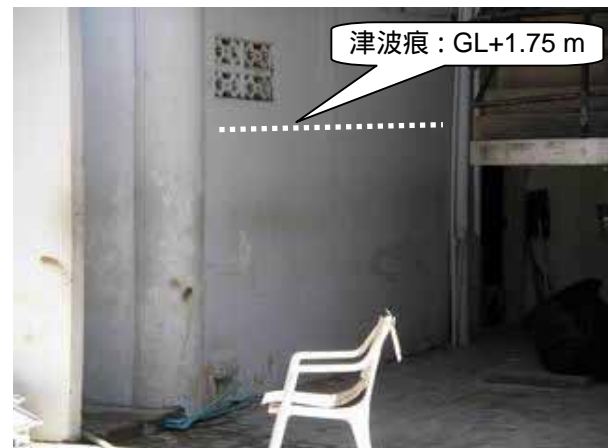
写真 5.1-3 : 隣接建物の壁の津波痕(1.75m)
