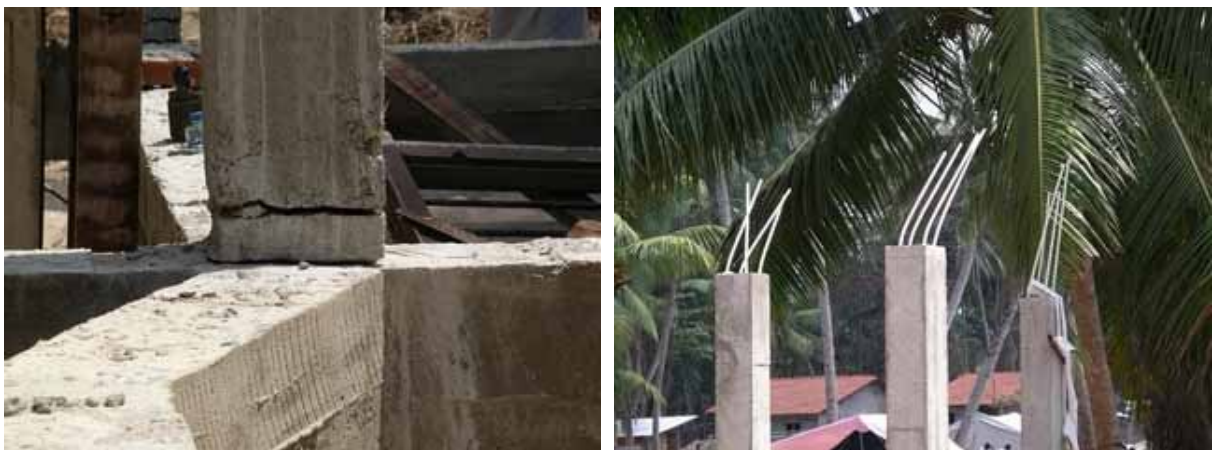
写真 4.23-5：転倒していない柱でも大きな曲げひび割れ，露出主筋の湾曲が見られる
