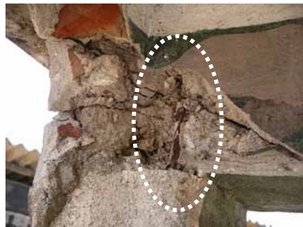
写真 4.13-3 : RC 造柱における鉄筋の露出
