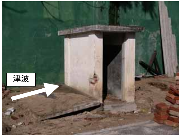
写真 4.10-1：屋外トイレ（開口部に衝突痕）
