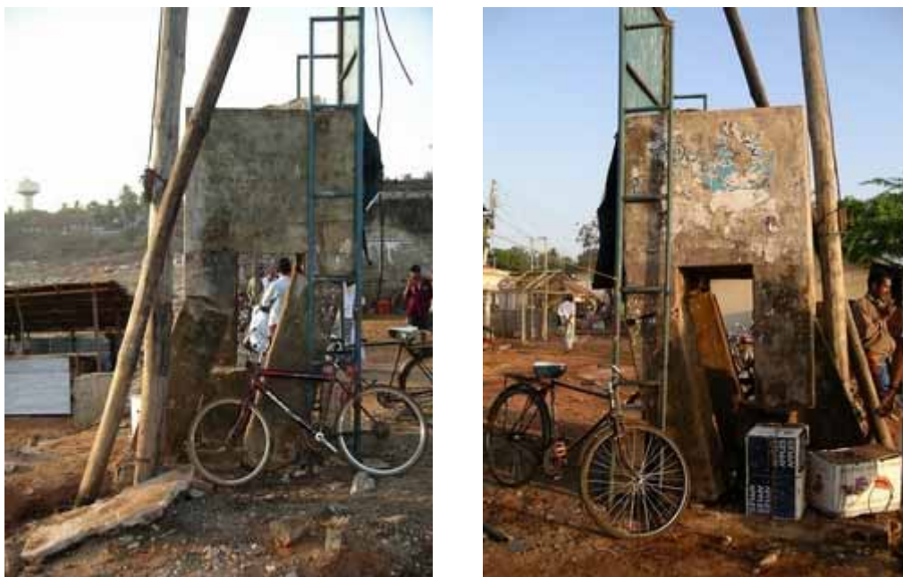
写真 4.14-2 : 柱の折損状況
