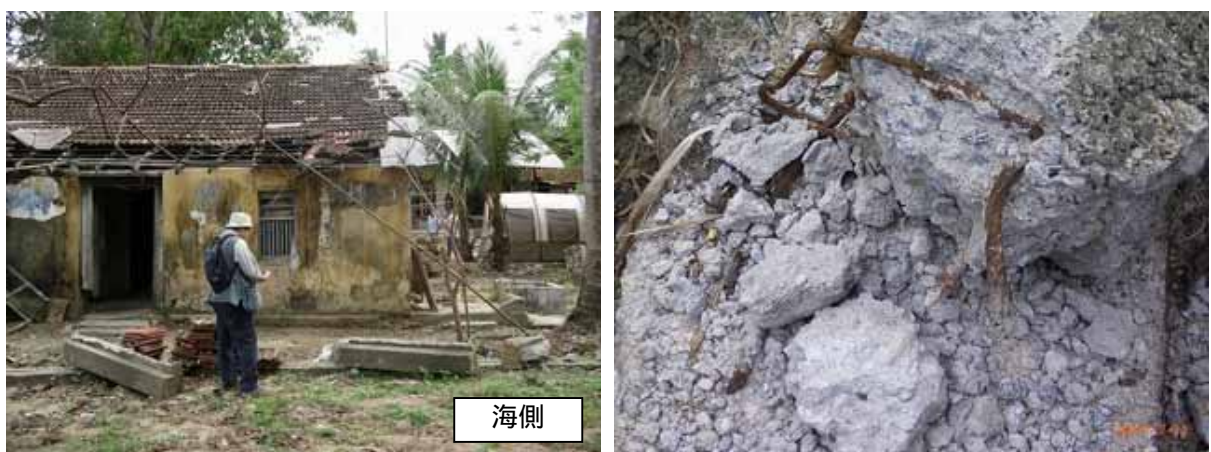
写真 4.7-3：倒壊した RC 造柱と損傷断面（鉄筋の破断と断面のくびれを確認）
