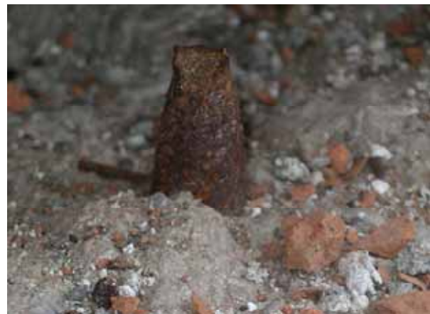
写真 4.6-2：鉄筋の破断面（くびれが確認）
