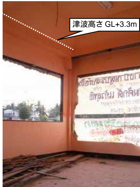
写真 5.9-3：津波高さの計測（GL+3.3m）
