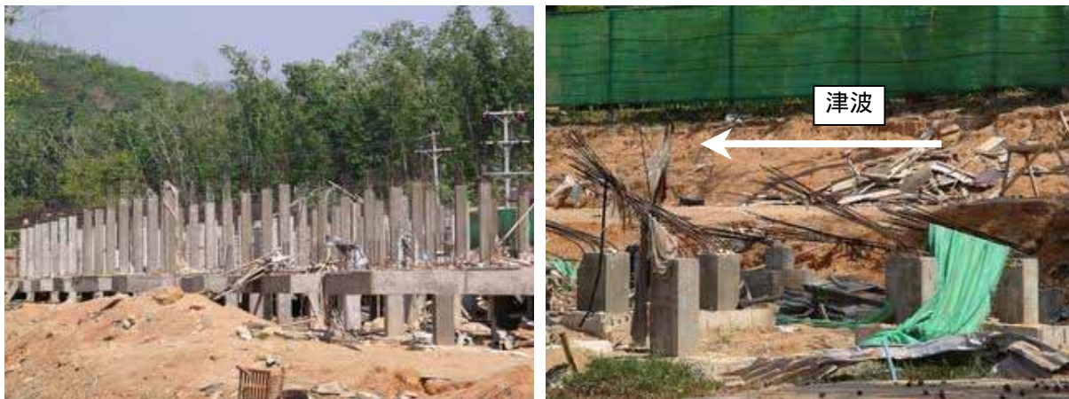
写真 5.7-9：建設途中の建物（露出した主筋が津波で湾曲している）
