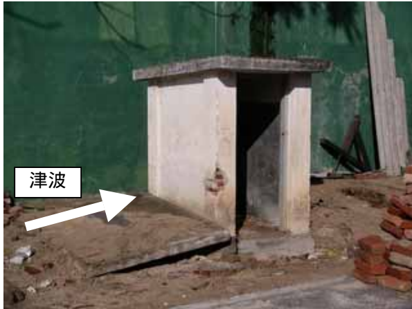
写真 4.10-1：屋外トイレ（開口部に衝突痕）
