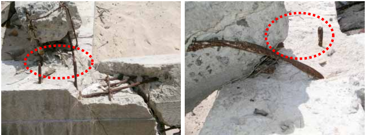
写真 4.23-4：破断した主筋（くびれが確認された）
