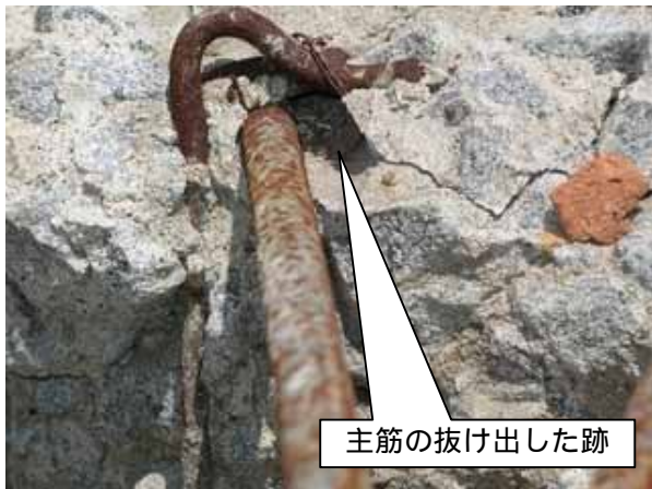
写真 4.5-3：鉄筋の抜け出し痕
