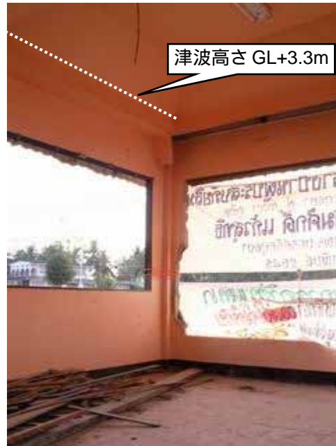
写真 5.9-3 : 津波高さの計測 (GL+3.3m)
