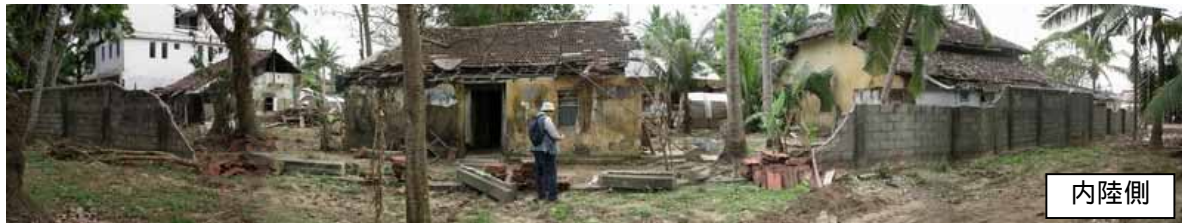
写真 4.7-1：6 スパンが倒壊した隣地境界塀
