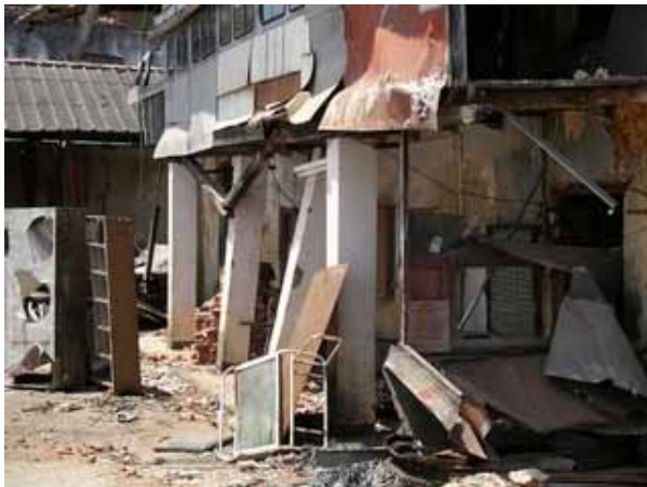
写真 4.6-1：損傷した柱（中央 2 本）
