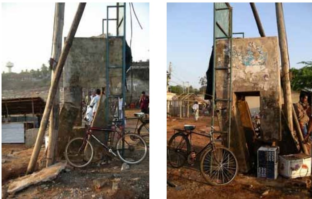
写真 4.14-2 : 柱の折損状況
