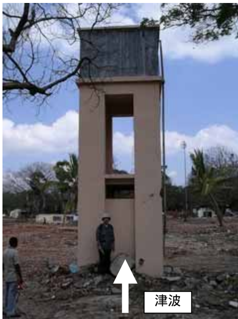
写真 4.17-1：水運河口付近の高架水槽
