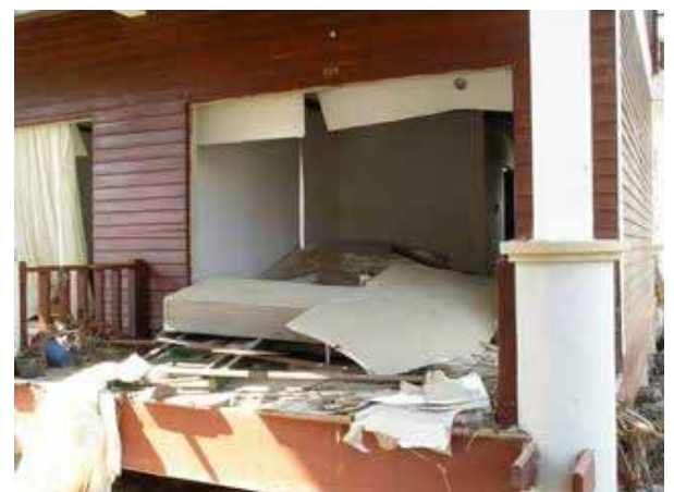
写真 5.7-4 : 1 階の被害（建物群 ）
