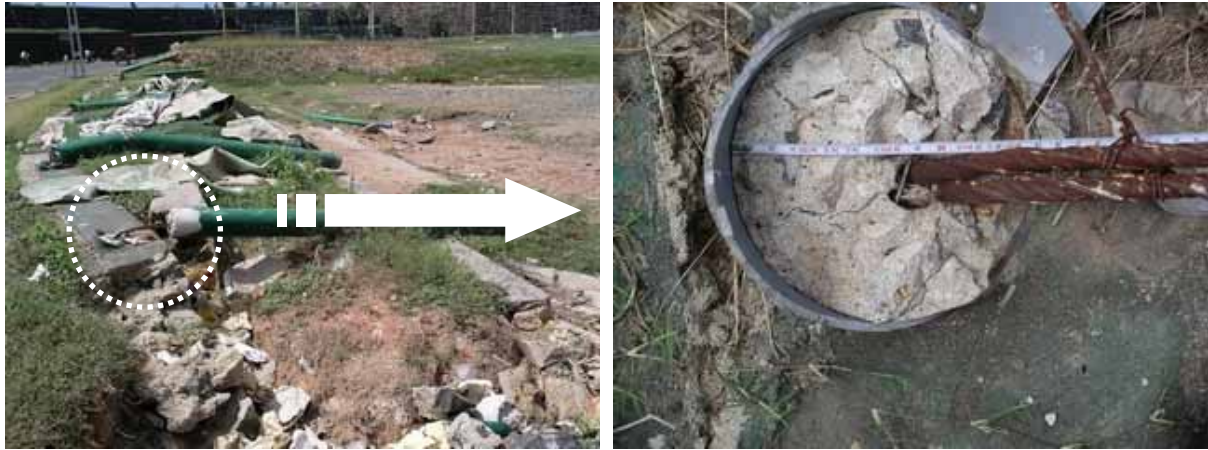
写真 4.4-5：破壊断面詳細
