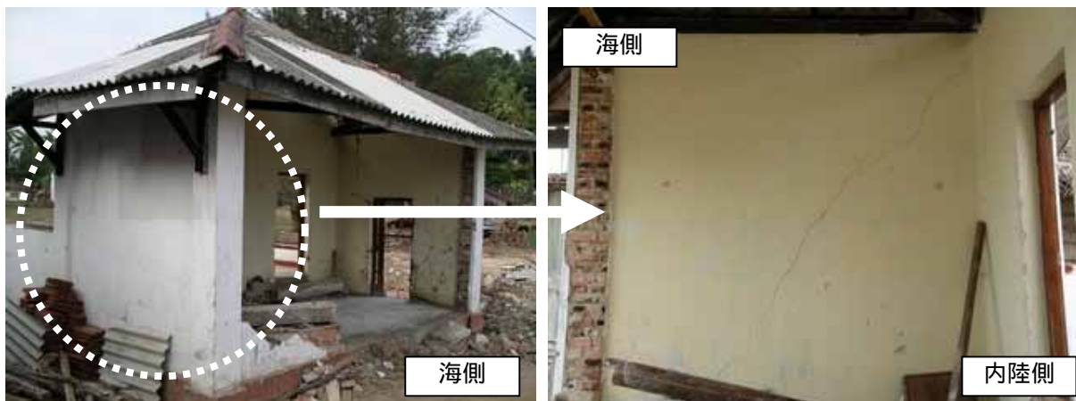
写真 4.8-1：レンガ壁にひび割れが生じた学校教室（外観）とひび割れ（内観）
