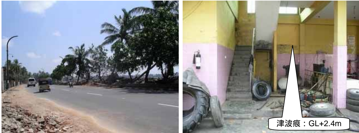
写真 4.5-5：敷地前を通る海岸道路と近接する工場での津波痕
