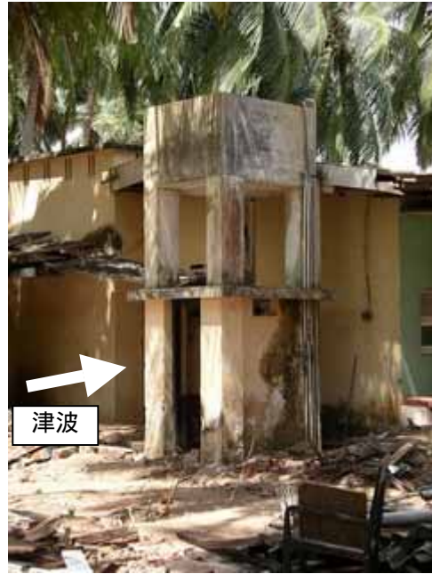
写真 4.16-8：道路脇の高架水槽
