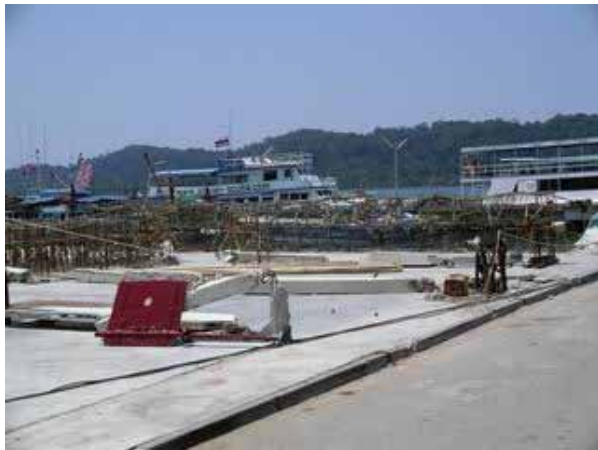
写真 5.6-1: 海軍基地近くの棧橋での倒壊柱
