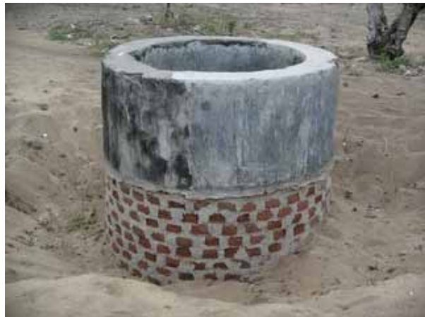
写真 4.2-4: 一般的な井戸 (洗掘が著しい)
