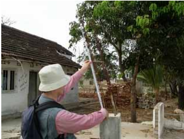
写真 4.1-4：住家の門柱（露出主筋が津波で湾曲）
