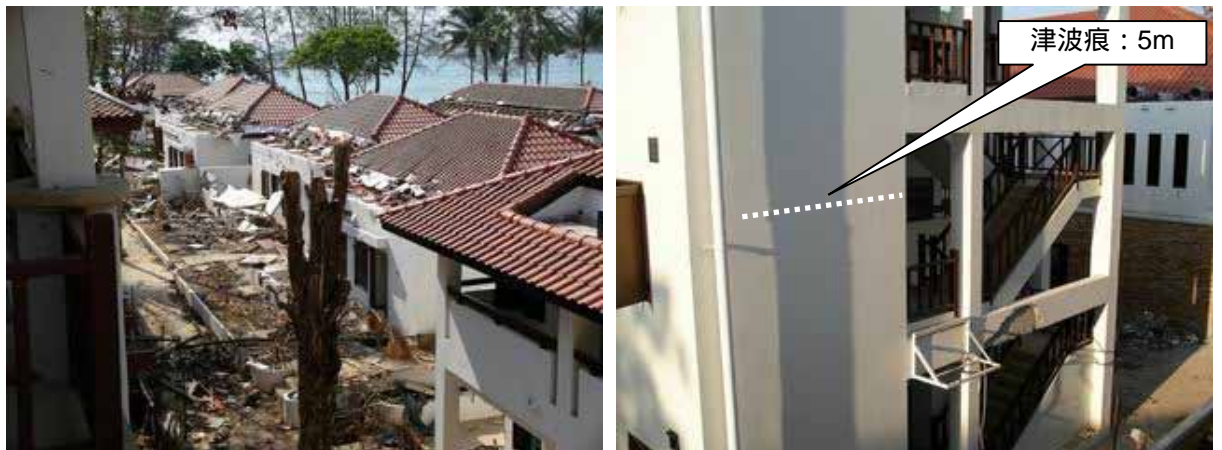
写真 5.7-2 : 建物群 の津波による屋根の被害と津波痕（5m）
