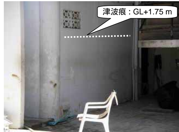
写真 5.1-3 : 隣接建物の壁の津波痕(1.75m)
