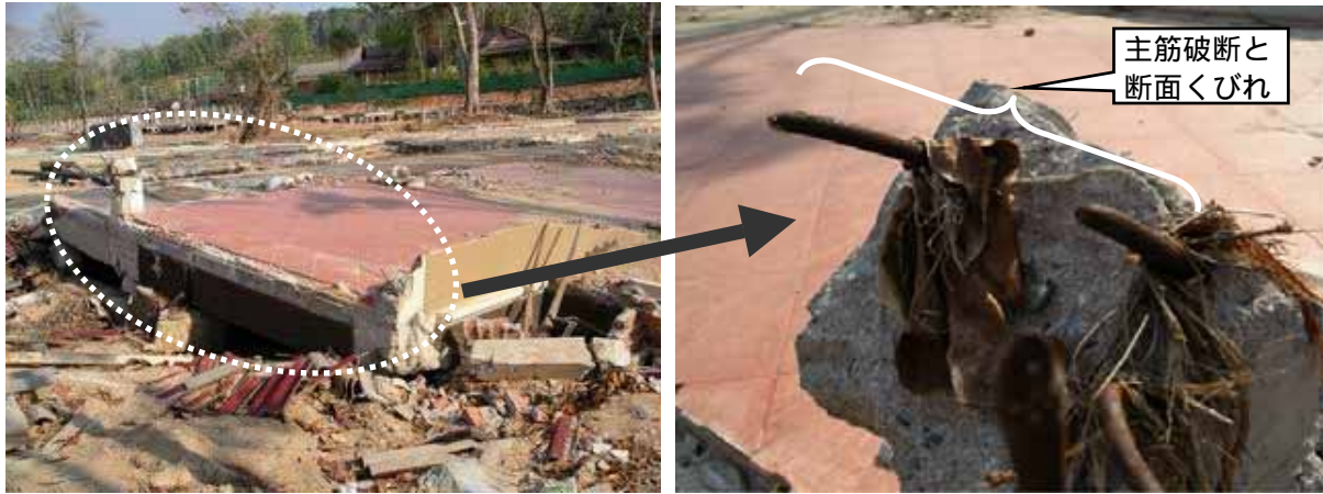
写真 5.7-8：主筋破断を伴う柱の曲げ破壊
