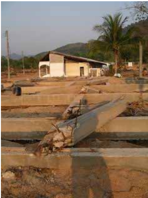
写真 5.9-2 : 倒壊柱のクローズアップ
