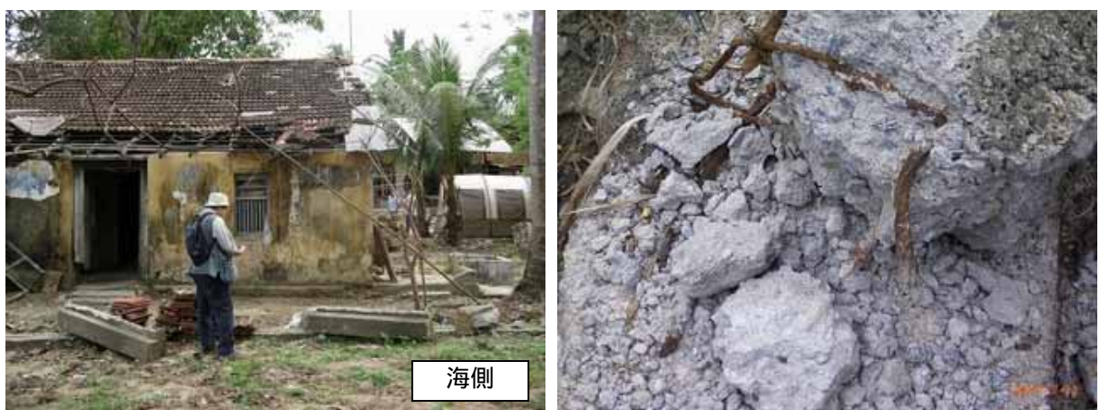
写真 4.7-3：倒壊した RC 造柱と損傷断面（鉄筋の破断と断面のくびれを確認）
