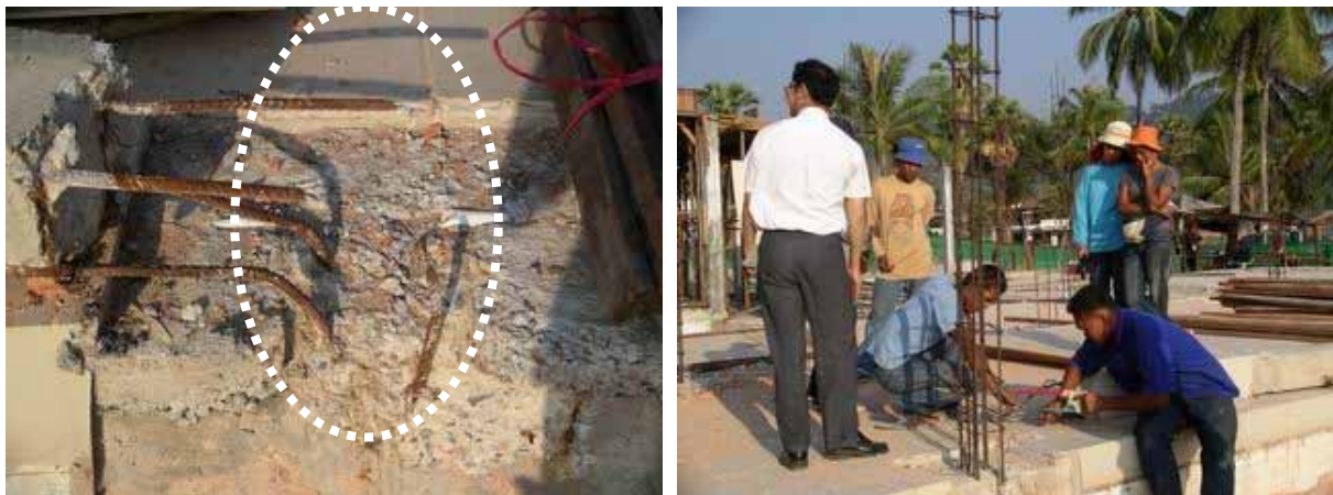
写真 5.8-2：主筋の破断を伴い曲げ破壊した柱と既存柱からの主筋サンプルの採取の様子
