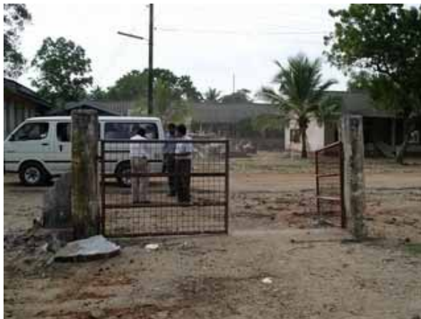
写真 4.1-1：門柱2本 / 左は健全，右は傾斜
