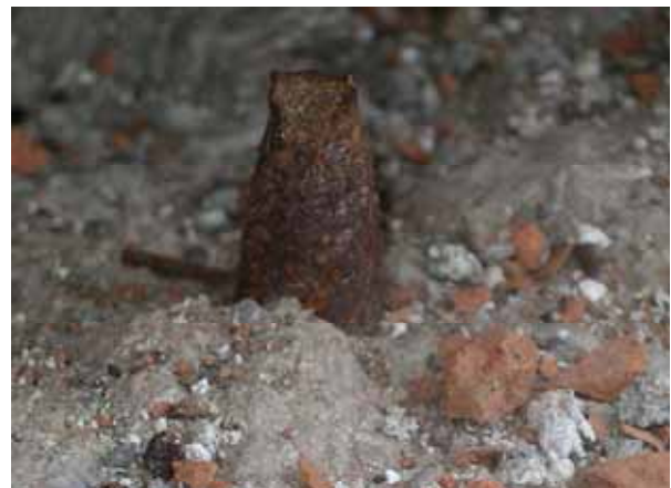
写真 4.6-2：鉄筋の破断面（くびれが確認）
