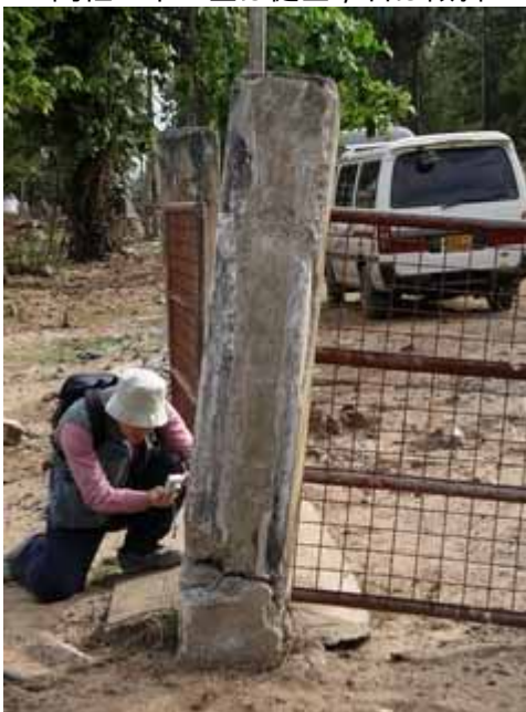
写真 4.1-3：傾斜した門柱には衝突痕が見られる
