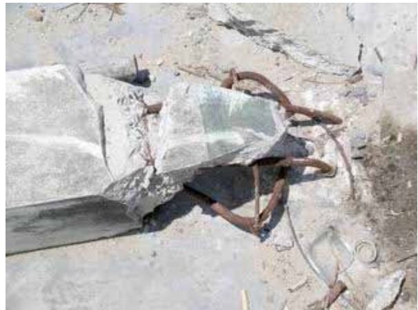
写真 5.6-2: 倒壊した柱のクローズアップ
