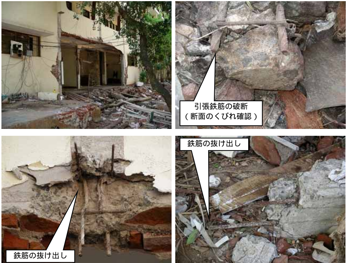
写真 4.16-6：建物西側廊下側レンガ壁（2スパン）の被害 （中央柱の脚部は鉄筋が破断している（上右）が頭部は抜け出し破壊している（下））
