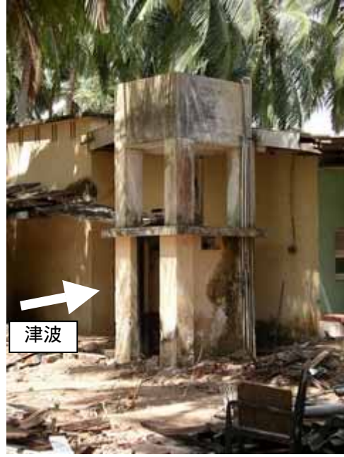
写真8：道路脇の高架水槽
