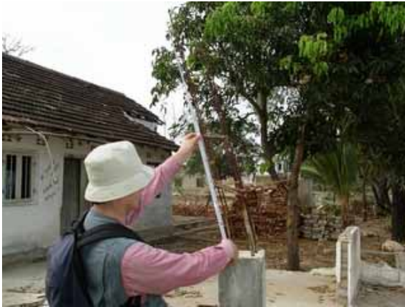
写真4：住家の門柱（露出主筋が津波で湾曲）
