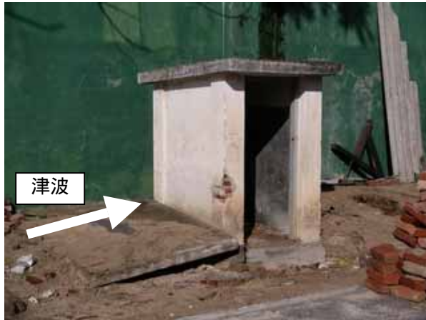
写真 1：屋外トイレ（開口部に衝突痕）
