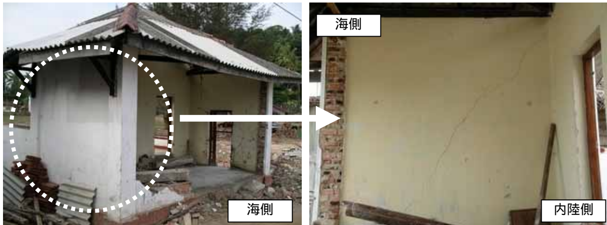
写真 1：レンガ壁にひび割れが生じた学校教室（外観）とひび割れ（内観）
