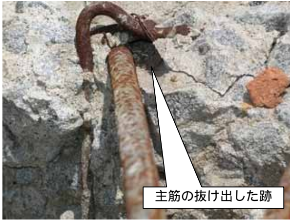
写真 3：鉄筋の抜け出し痕
