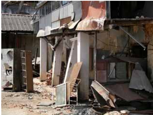
写真 1：損傷した柱（中央 2 本）
