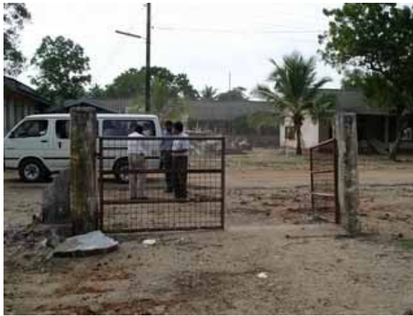
写真1：門柱2本 / 左は健全，右は傾斜
