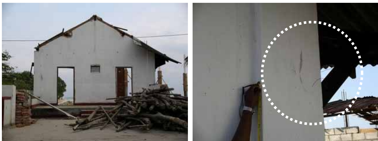
写真 3：海岸線と平行する壁と柱型上部の衝突痕
