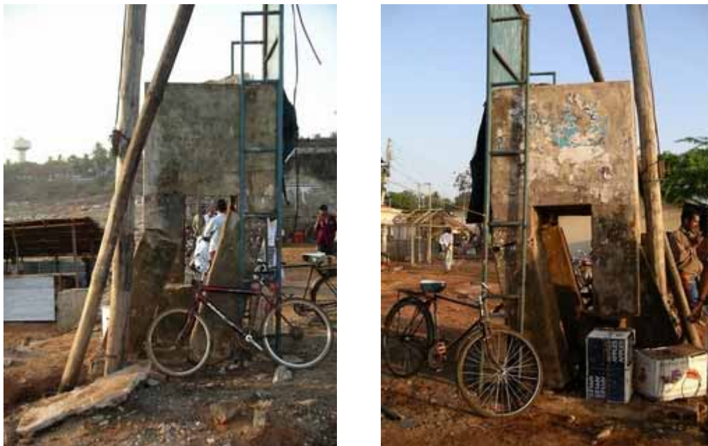
写真 2：柱の折損状況
