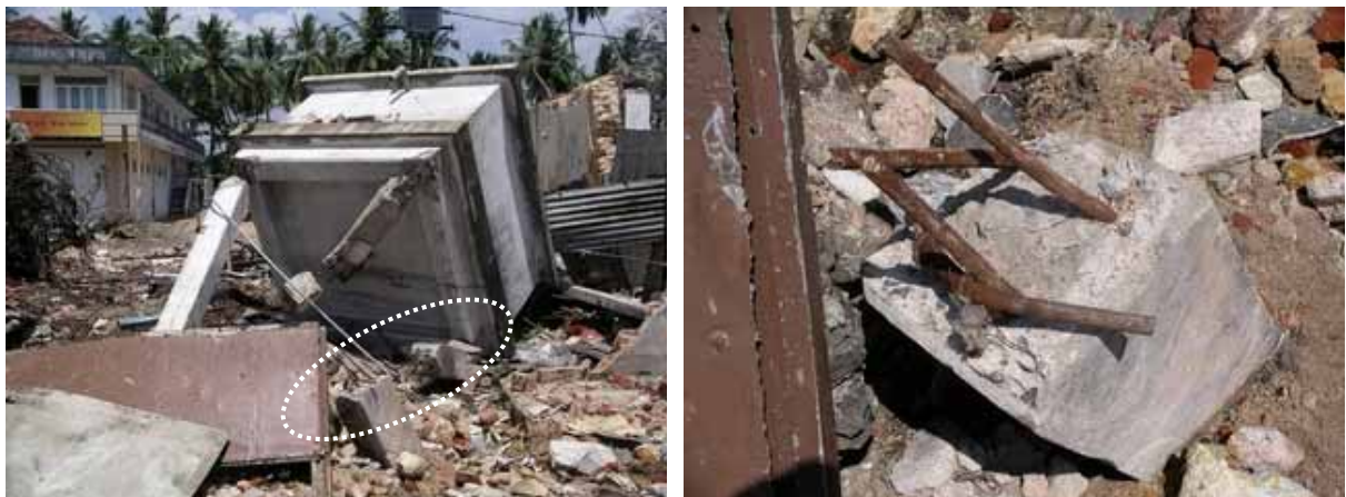
写真 2：折損した柱の断面（重ね継手にはフックは設けられていない）
