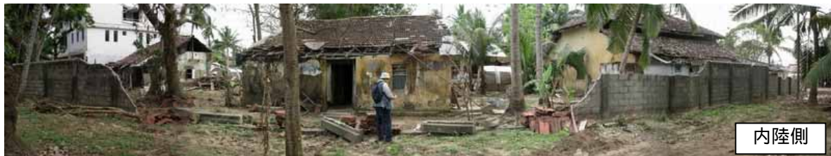
写真 1：6 スパンが倒壊した隣地境界塀
