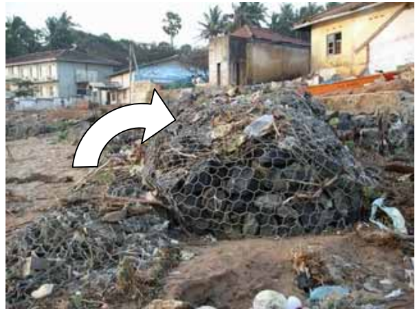
写真4：海岸側の石積み堤防の被害
