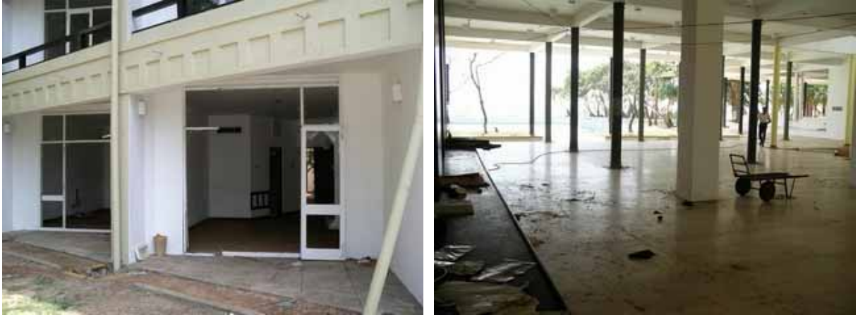
写真 1：ロビーおよび客室の被害
