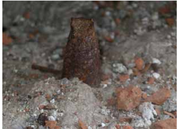
写真 2：鉄筋の破断面（くびれが確認）
