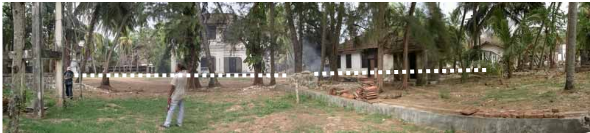
写真5：崩壊した石造隣地境界塀
