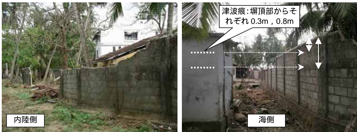
写真 2：ブロックの被害の詳細（上 3 段のみが破壊している箇所も見られる）
