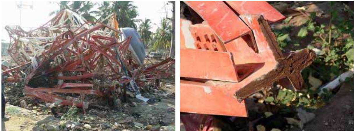
写真3：大破した鉄塔とすみ肉溶接部で破断したその柱脚部
