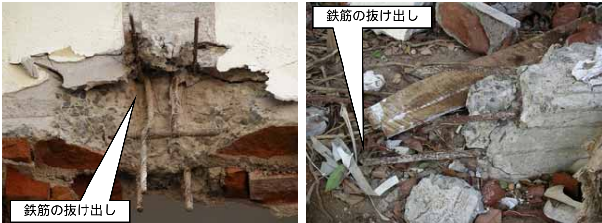
写真6：建物西側廊下側レンガ壁（2スパン）の被害 （中央柱の脚部は鉄筋が破断している（上右）が頭部は抜け出し破壊している（下））
