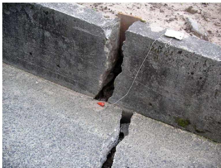
写真 42 路面および外構に見られた亀裂
