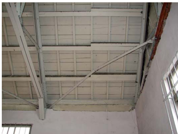
写真 講堂屋根火打ちブレースの座屈
