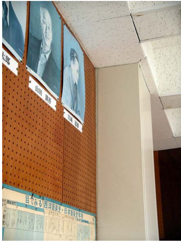
写真 音楽室の間仕切壁が面外方向に傾いている
