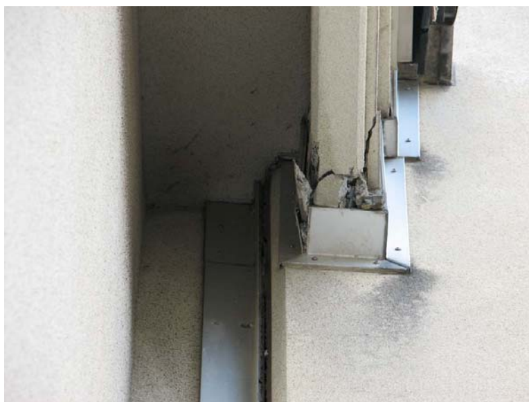
写真 エキスパンションジョイント部での損傷
