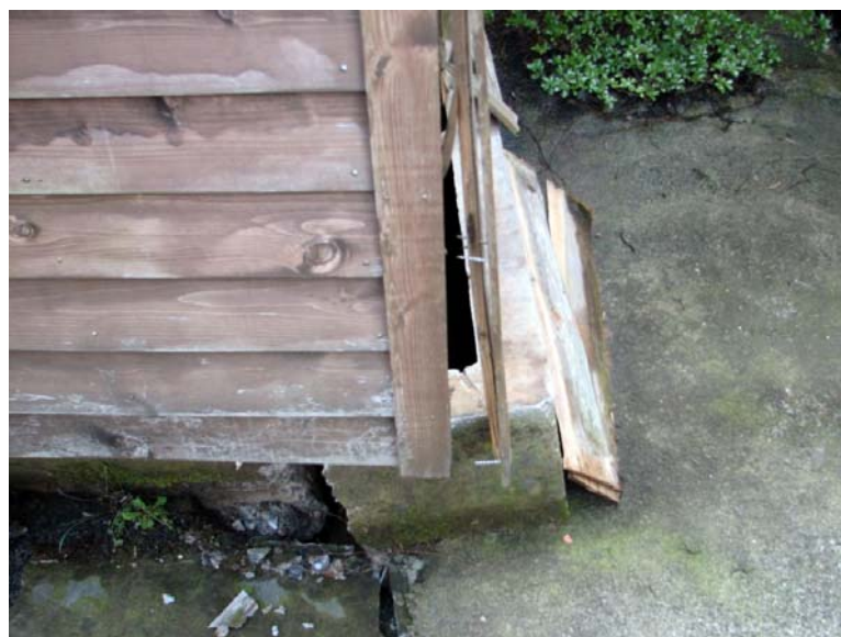
写真 10 基礎割れと上部構造のスライド
