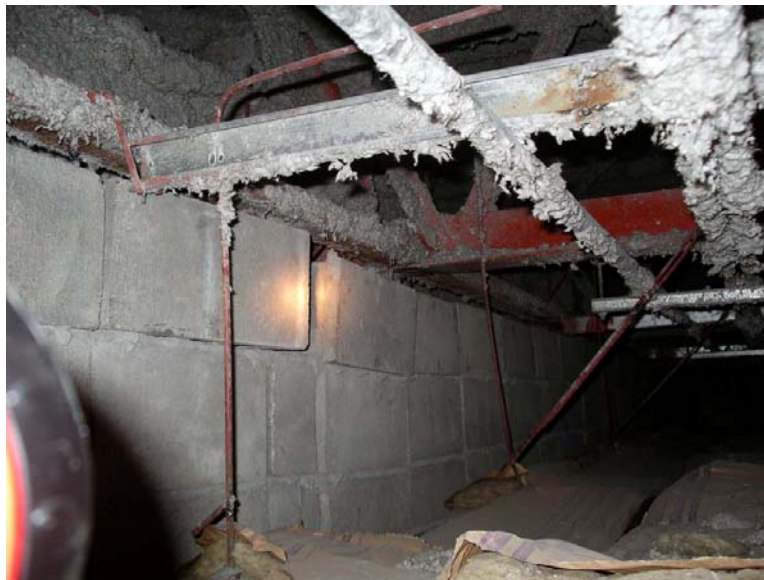
写真 間仕切壁の組積ブロックが頂部で固定されていない
