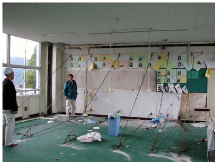
写真 脱落しかかっている ALC パネル
