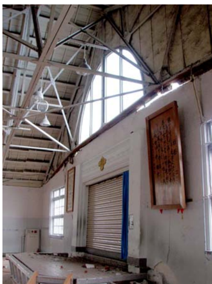
写真 講堂の妻壁の被害
