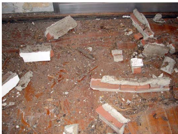
写真 講堂妻壁のブリックが落下
