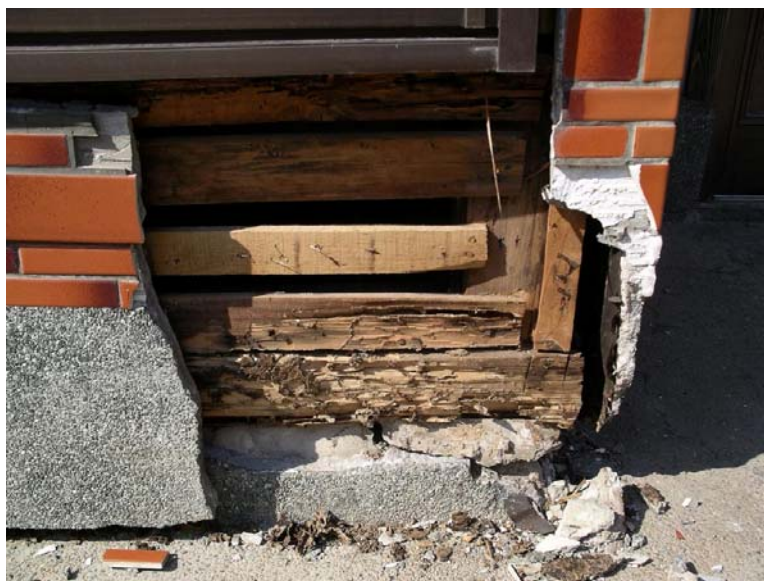
写真 29 蟻害と思われる土台の腐朽
