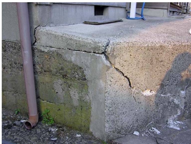
写真 39 外構部分の損傷例
