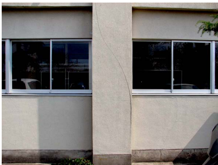
写真 短柱のせん断ひび割れ
