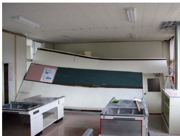
写真 脱落した間仕切壁
