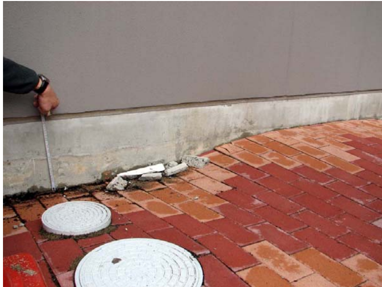
写真 校舎入口脇の不同沈下
