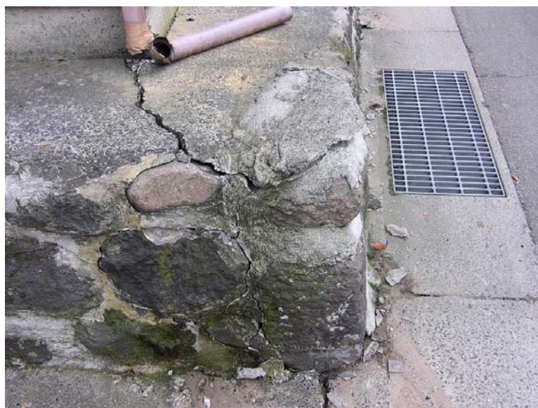
写真 12 外構隅角部の一部が崩落した跡
