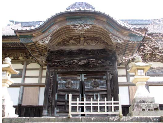
写真 脱落して傾いた大扉
