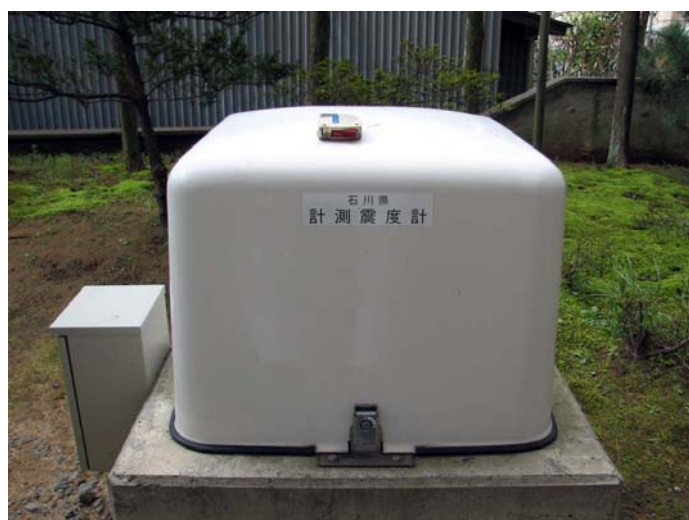
写真 設置されている計測震度計
