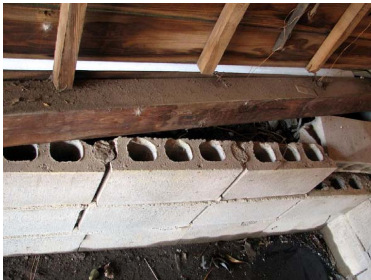
写真 28 スライドした土台の下にあるブロック基礎
