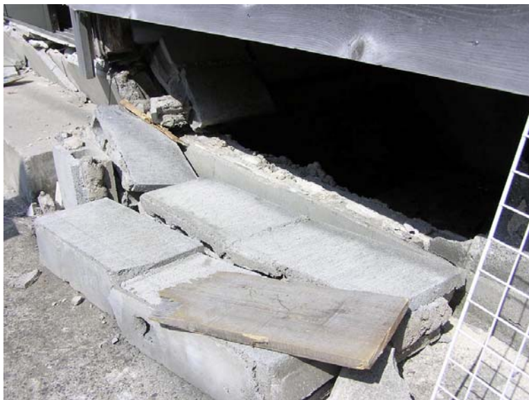
写真 8 基礎隅角部のブロックの転倒
