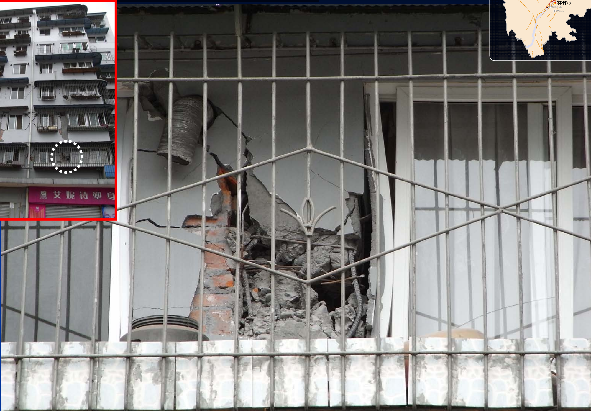
漢旺の建物B／柱のせん断破壊
