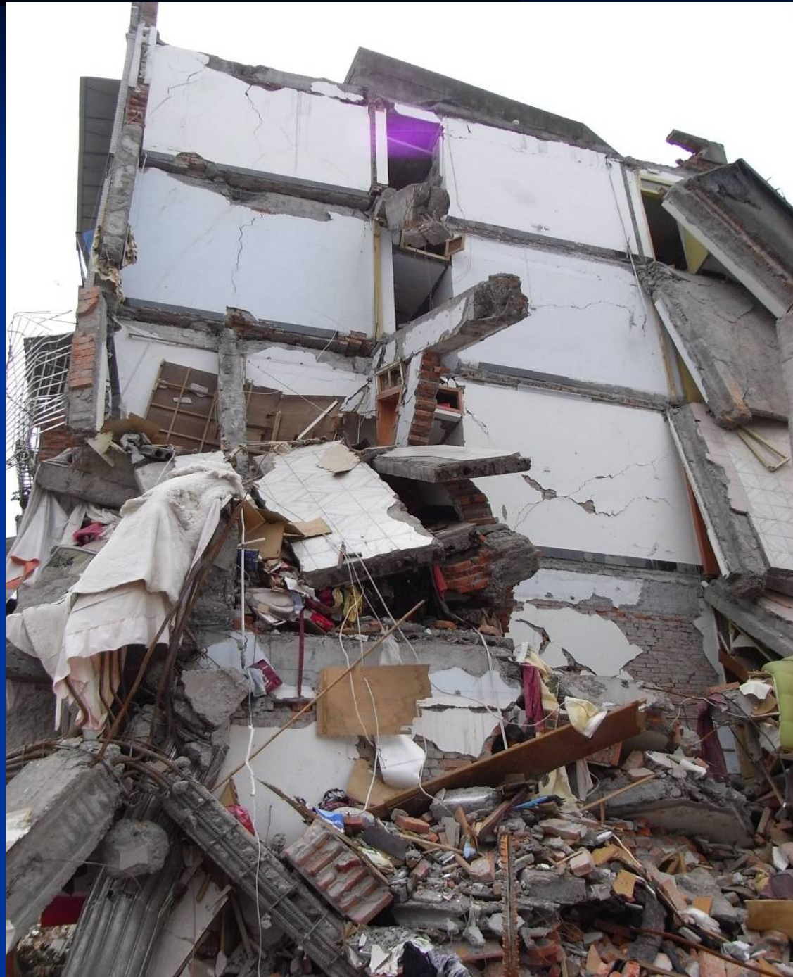
綿竹市・漢旺／接合箇所破壊・ばらばらになった建物
