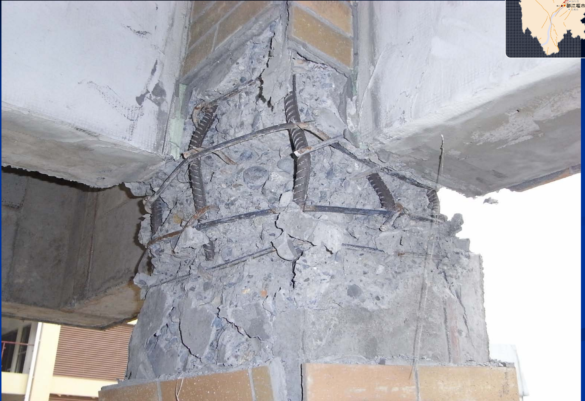
6階建集合住宅／柱頭部の損傷
