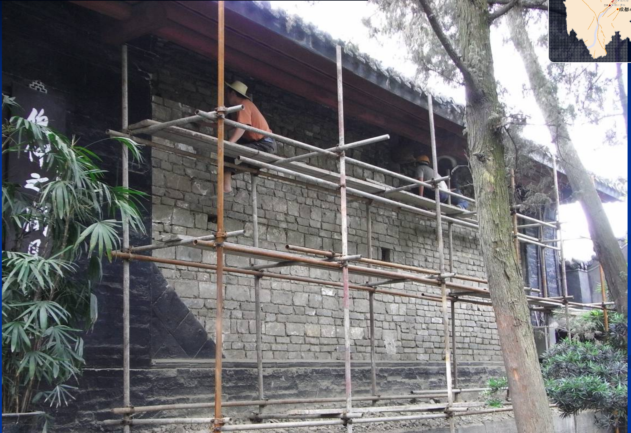
武侯祠博物館(成都市内) / 仕上げが剥落した壁(修復中)
