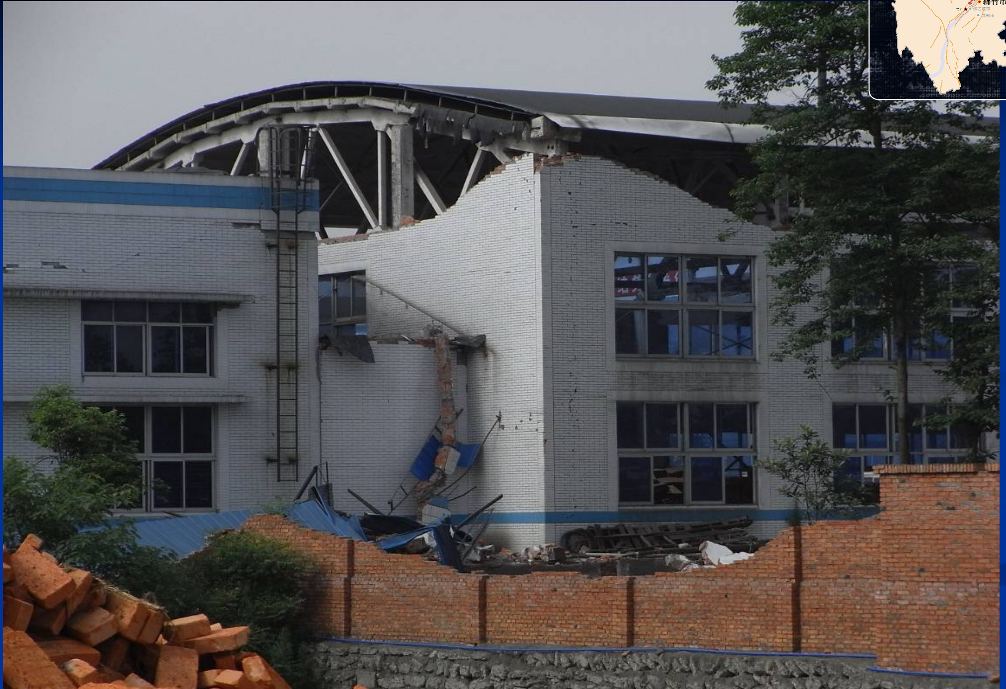
綿竹市・漢旺／工場の被害(レンガ壁が面外に崩落)
