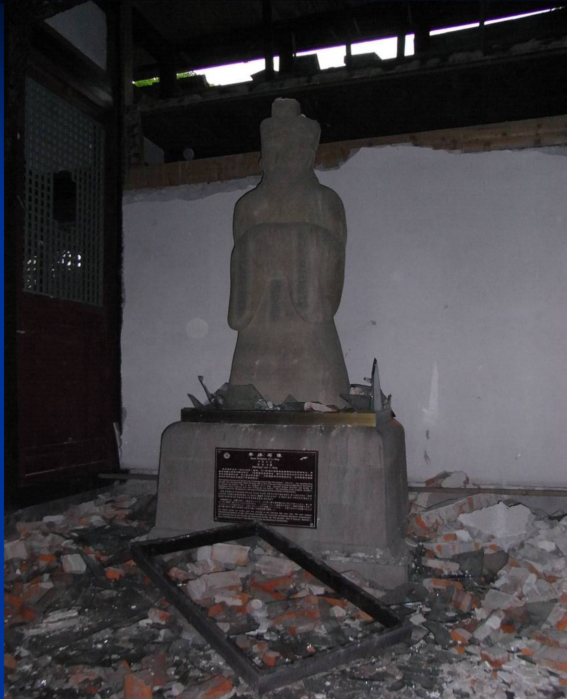
伏龍觀の石像のケースが割れる被害
