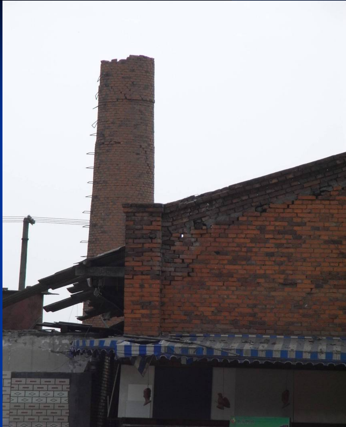
綿竹市・漢旺／レンガ造煙突の折れた事例(そこそこ揺れていると思われる)
