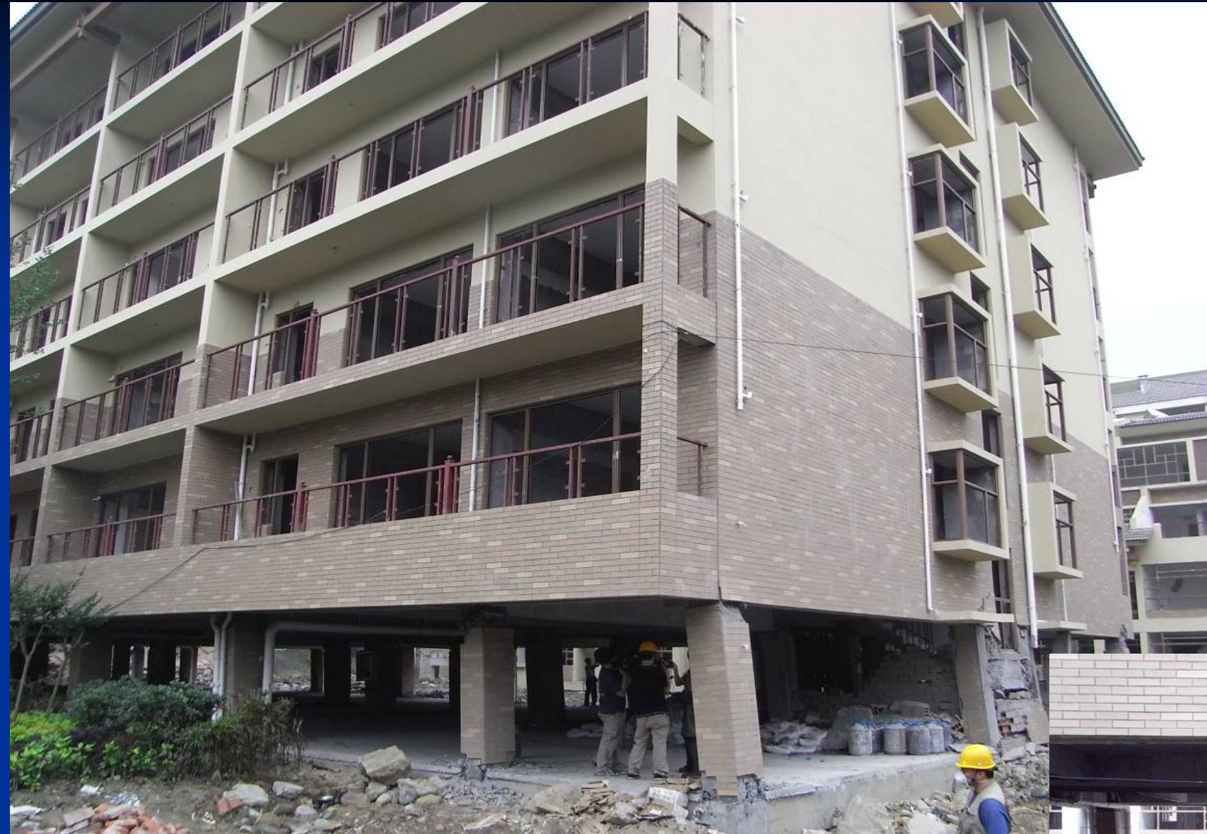
残留変形の大きい6階建集合住宅
