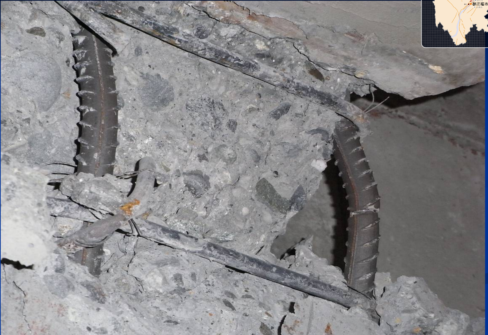
6階建集合住宅／柱主筋座屈・破断
