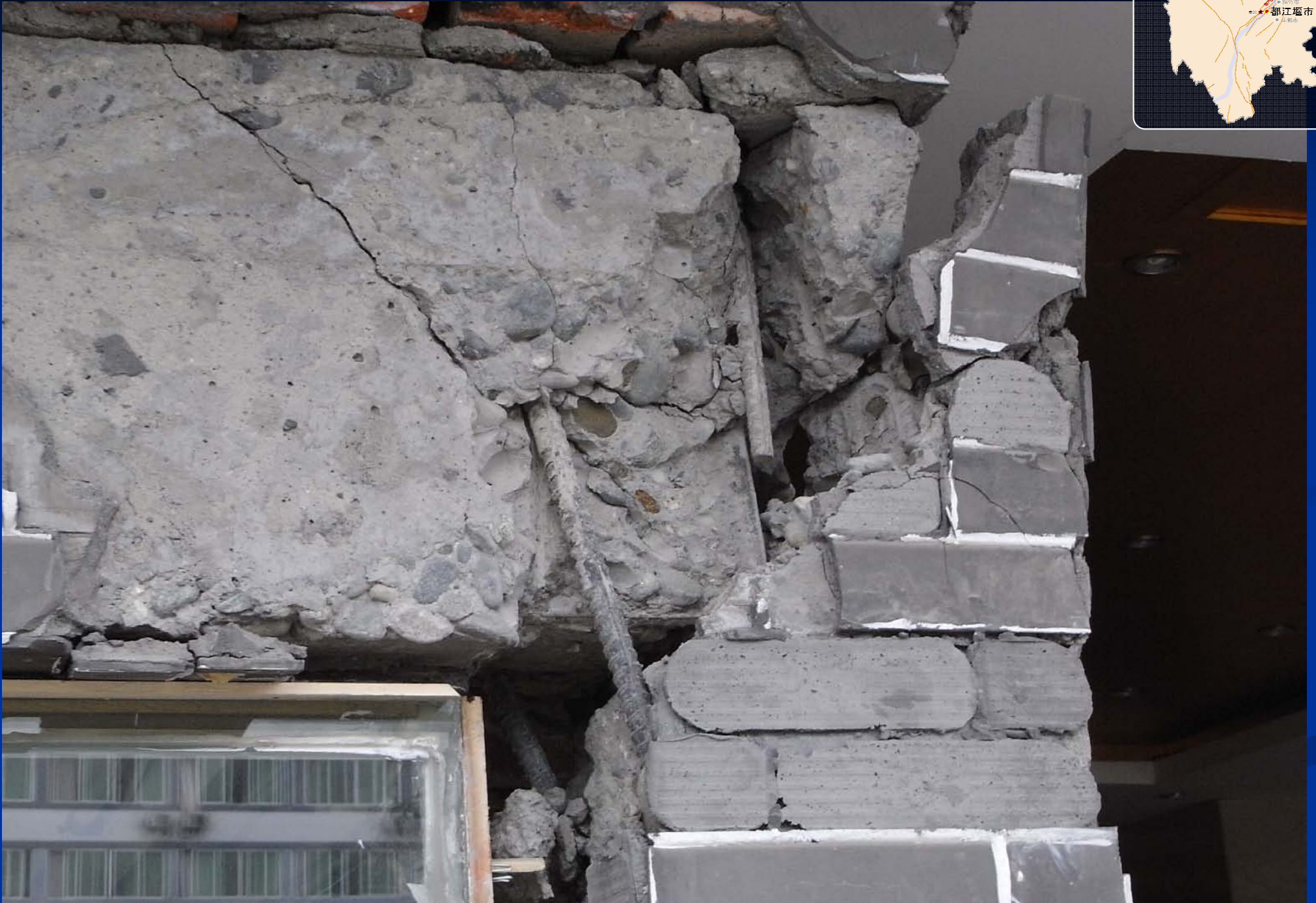
建物A／柱梁接合部 定着が不十分
