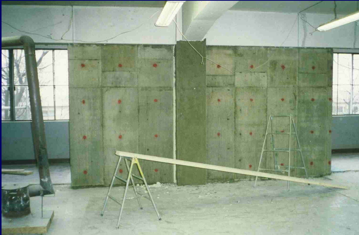
袖壁による補強 (翌1994年の北海道東方沖地震で無被害)
