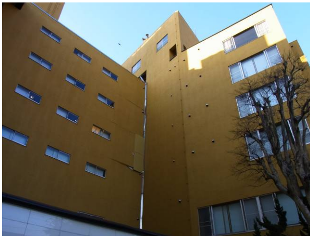
写真 6-20-4 別館と渡り廊下間の Exp.J に隣接す PCa 外壁が脱落
