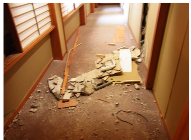
写真 6-20-13 内装材が落下した5階渡り廊下は閉鎖
