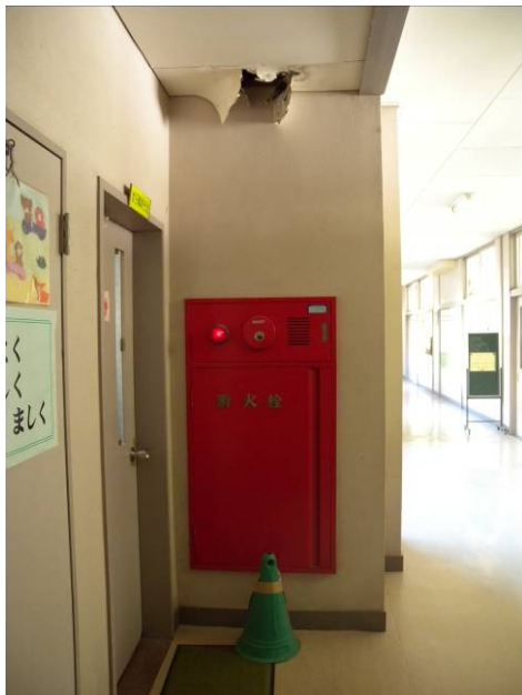
写真 6-11-2 CB 片が落下し天井パネルが破損
