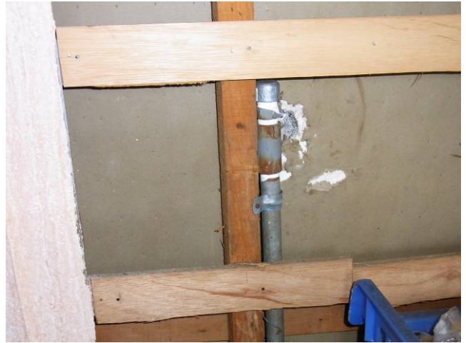
写真 6-27-7 台所水道管の破損（補修済み）
