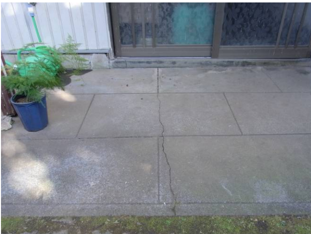
写真 6-27-4 玄関たたき部分のひび割れ
