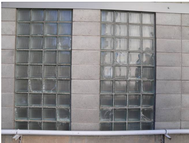
写真 6-7-4 プール附属棟 (補強CB造・耐震補強済) のガラスブロックにひび割れ
