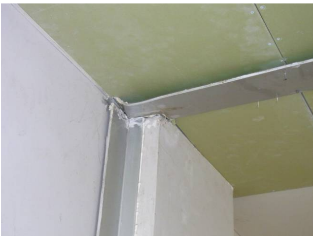
写真 6-8-2 エキスパンションジョイントカバーの損傷
