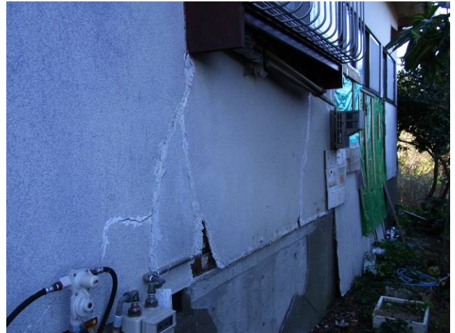
写真 6-26-3 過去の地震で生じたひび割れ補修跡からひび割れが進展
