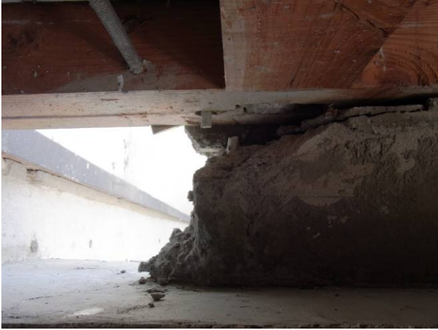
写真 6-28-2 増築部アンカーボルトの破断
