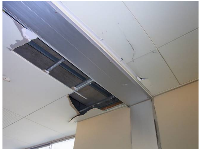
写真 6-7-3 エキスパンションジョイント周りの非構造部材 (天井パネル) の損傷
