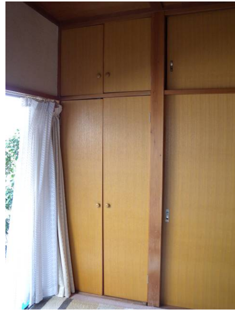
写真 6-24-3 擁壁のはらみだし方向に地盤および床が傾斜して建具に生じた変形
