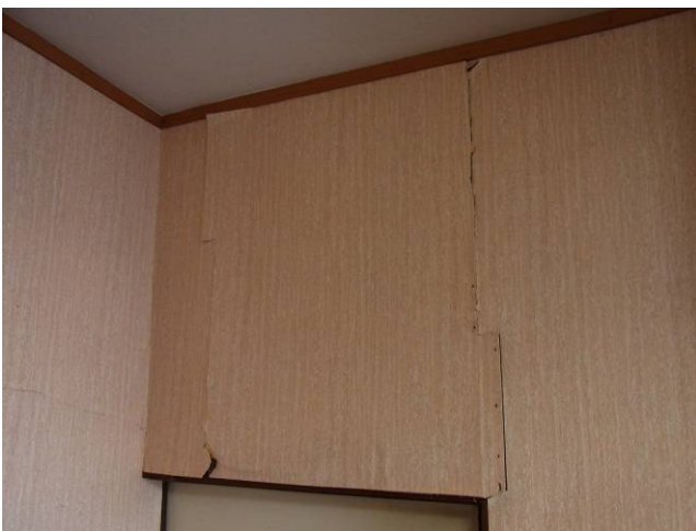
写真 6-27-8 内壁クロスのはがれ
