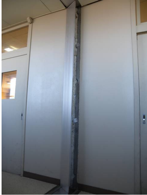
写真 6-7-2 エキスパンションジョイントの損傷
