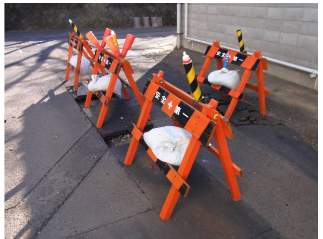
写真 6-7-5 プール附属棟前のアスファルトに亀裂
