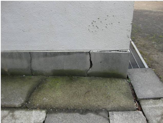
写真 6-3-2 校舎2の南端妻壁の基礎部の損傷
