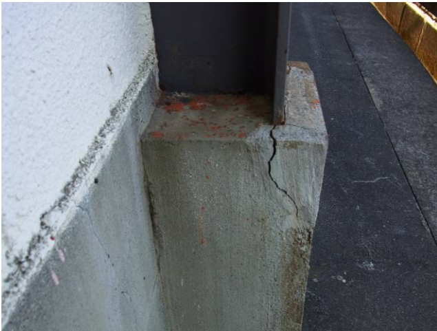
写真 6-10-4 体育館柱脚基礎コンクリートの割裂
