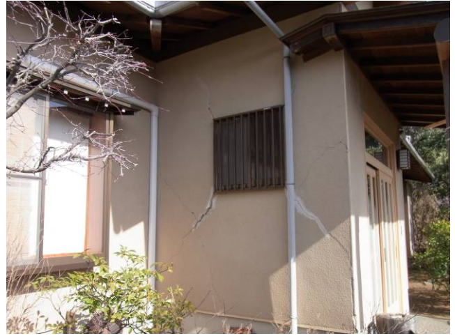
写真 6-25-3 外壁開口部周りのせん断ひび割れ
