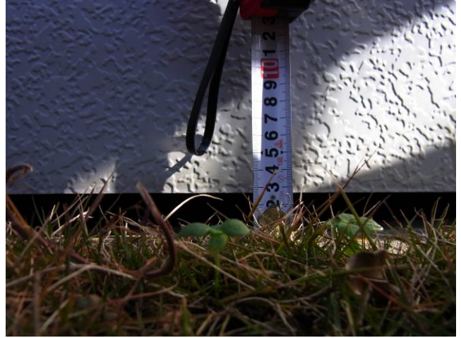
写真 6-28-3 地盤沈下に伴う基礎と地盤のずれ
