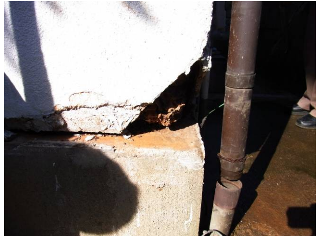
写真 6-24-5 土台蟻害・外壁隅角部の欠損
