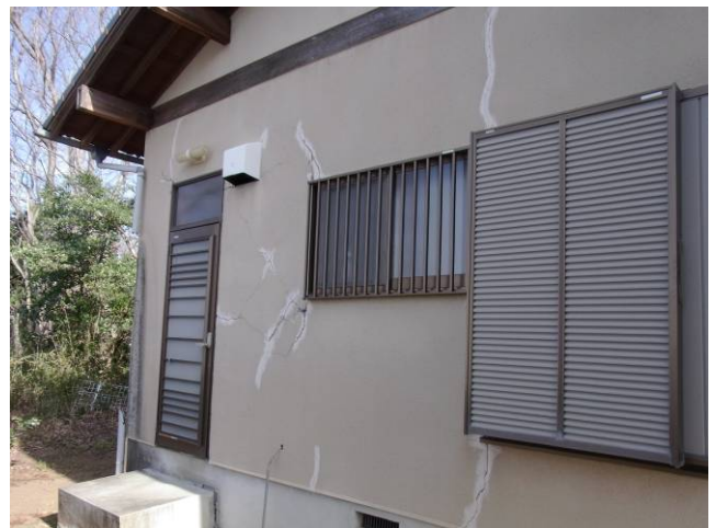
写真 6-25-5 縦樋破損（左側）・過去の地震で生じたひび割れ補修跡からひび割れが進展
