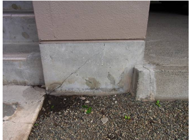
写真 6-23-3 ピロティ柱脚のひび割れ
