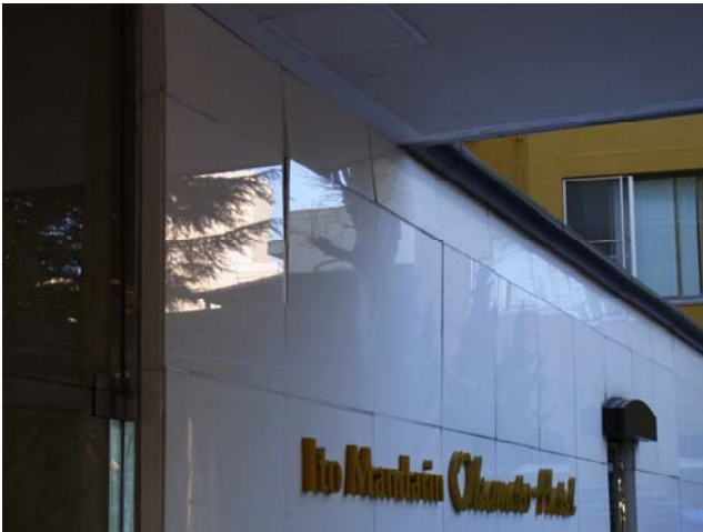
写真 6-20-8 エントランス外壁タイルの浮き
