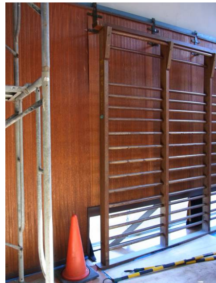
写真 6-10-5 仕上げの浮きと欄間ガラスの被害
