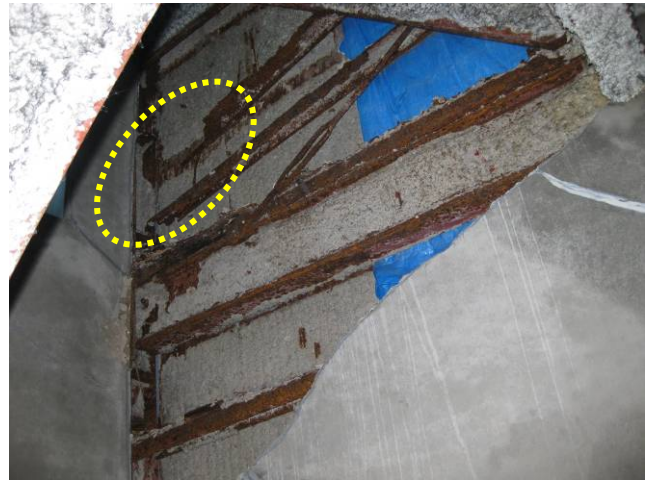
写真 6-19-3 仕上げモルタル剥落と下地鉄骨の破断
