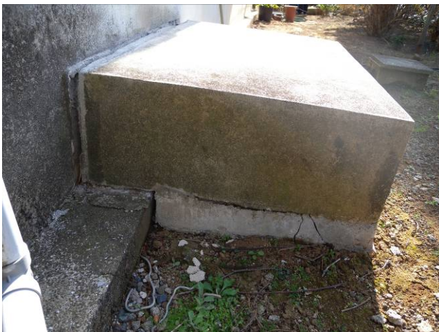
写真 6-25-4 地盤沈下に伴う踏み石の傾斜
