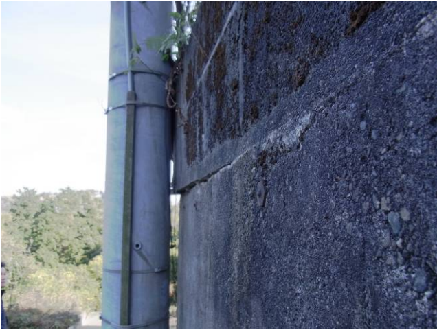
写真 6-27-6 擁壁上部をブロック塀が滑り出た
