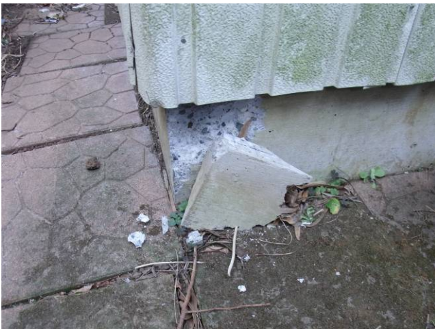
写真 6-27-2 基礎隅角部の欠け
