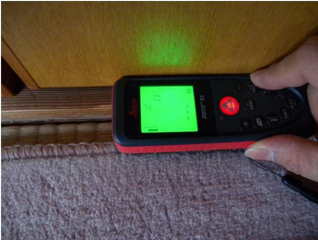
写真 6-24-4 変形した建具傾斜角の測定
