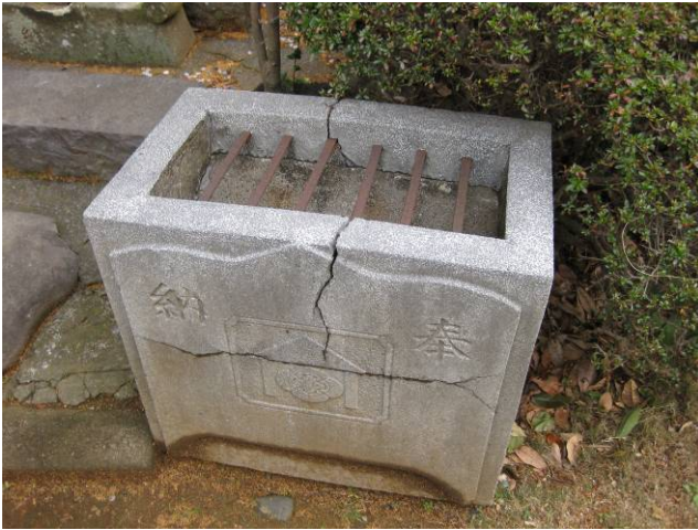
写真 6-33-2 奉納箱に生じた亀裂
