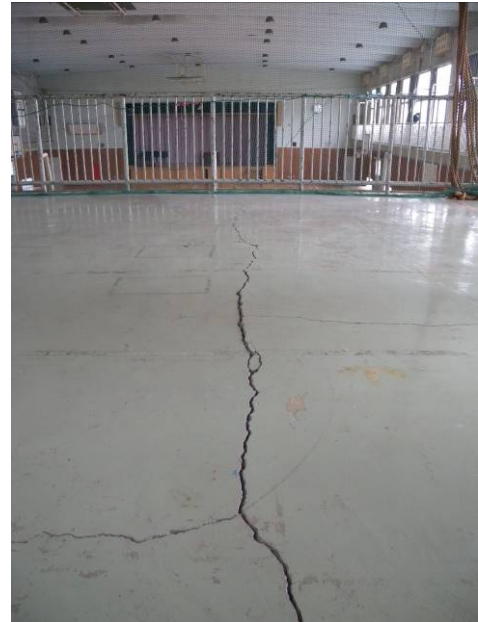
写真 6-3-3 体育館2階床スラブの亀裂
