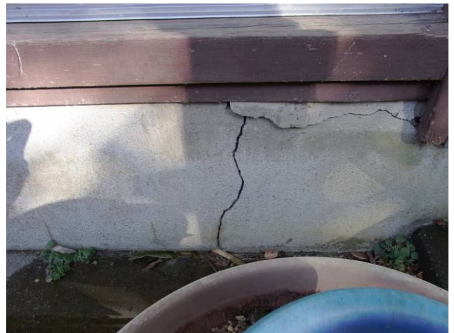
写真 6-27-3 基礎に生じたひび割れ
