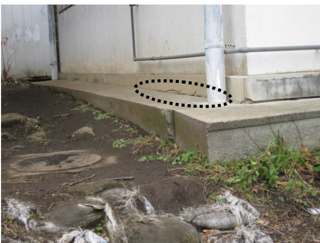
写真 6-9-2 園舎基礎部の亀裂
