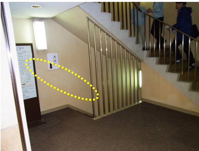
写真 6-20-10 階段室の壁にせん断ひび割れ
