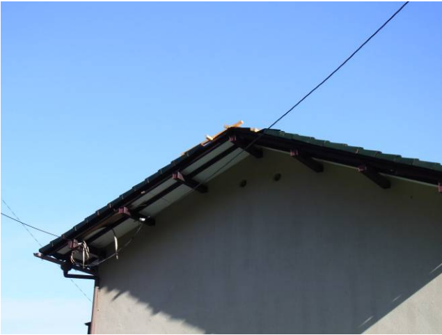
写真 6-29-2 棟瓦がずれた（地震後に撤去）
