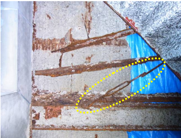
写真 6-19-4 梁に留められたターンバックル付ブレース
