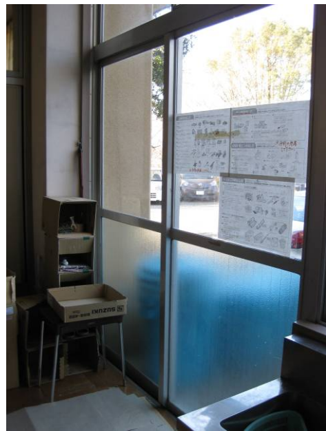
写真 6-11-3 アルミサッシュ内ガラス破損（補修済）
