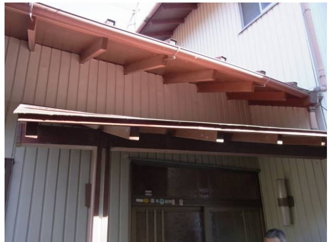
写真 6-27-5 玄関庇の傾斜
