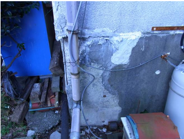
写真 6-26-4 基礎隅角部の欠損
