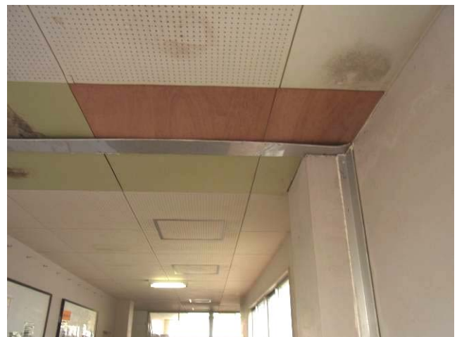
写真 6-8-3 Exp.J 周りの非構造部材（天井板）損傷
