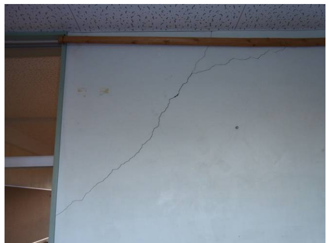
写真 6-5-3 壁にせん断ひび割れ（家庭科室）
