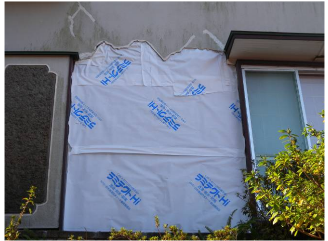
写真 6-29-3 外壁モルタル仕上げが過去の地震によるひび割れ補修跡を起点に剥落
