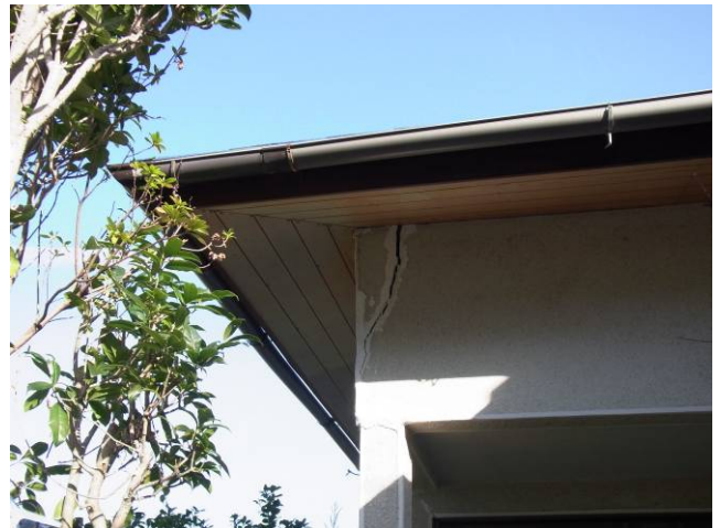
写真 6-26-5 軒先の仕上げ補修跡が再度ひび割れ
