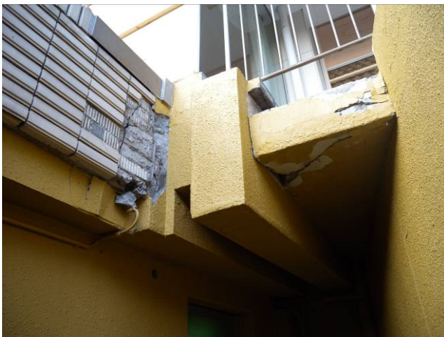
写真 6-20-6 エントランス南側の本館と外構の取合い部分のコンクリート破損 (地下1階より撮影)
