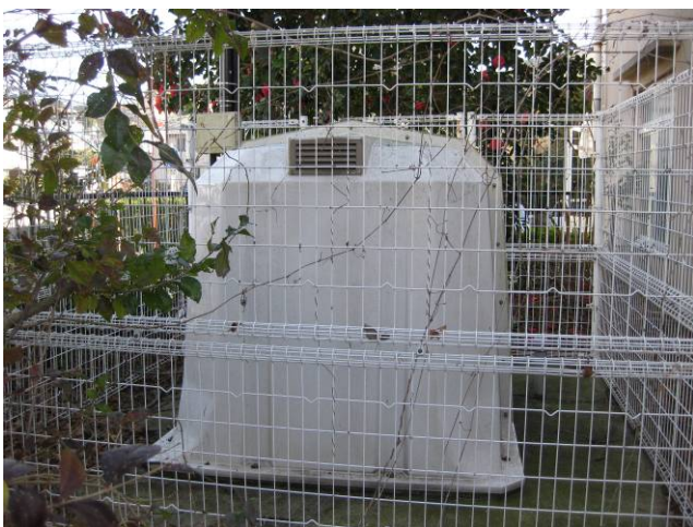
写真 6-5-2 k-net 伊東設置状況
