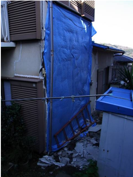
写真 6-26-2 外壁モルタル仕上げの剥落
