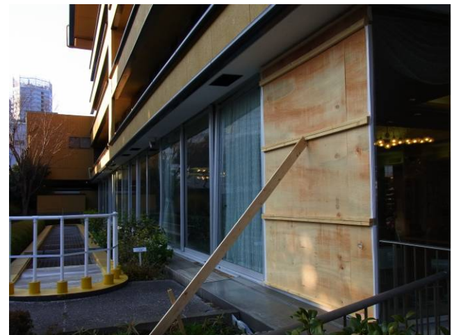
写真 6-20-7 本館エントランス右手 (南側) の窓ガラスが破損
