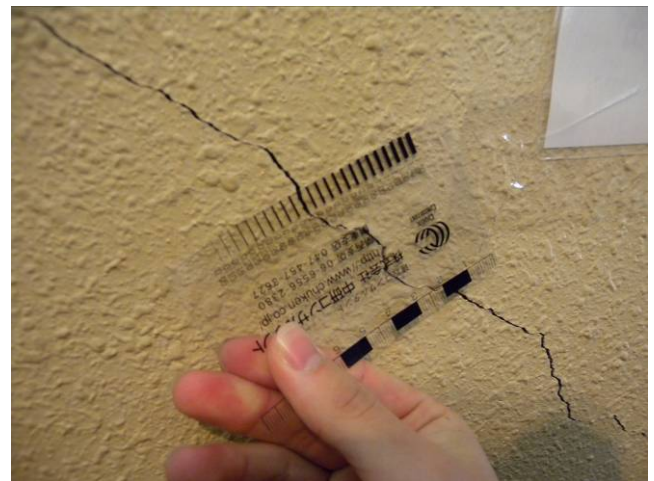
写真 6-20-11 階段室の壁のひび割れ幅 0.6mm
