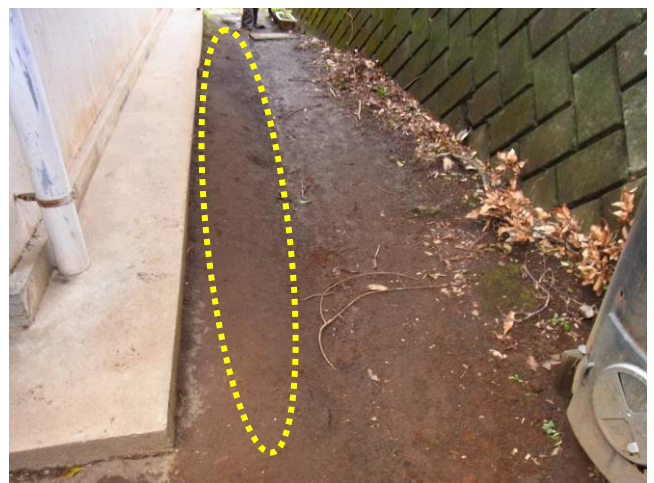
写真 6-9-3 地中埋設水道管の損傷（補修済）
