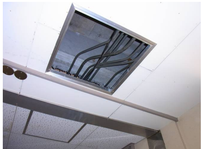
写真 6-11-5 点検口のパネル落下
