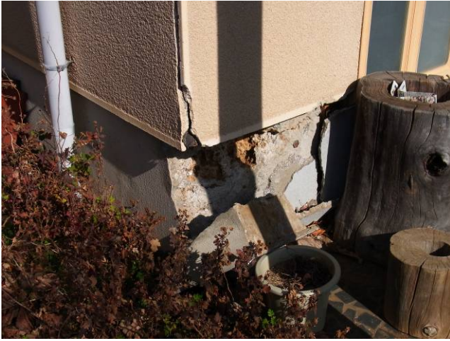
写真 6-25-2 玄関基礎隅角部の欠け
