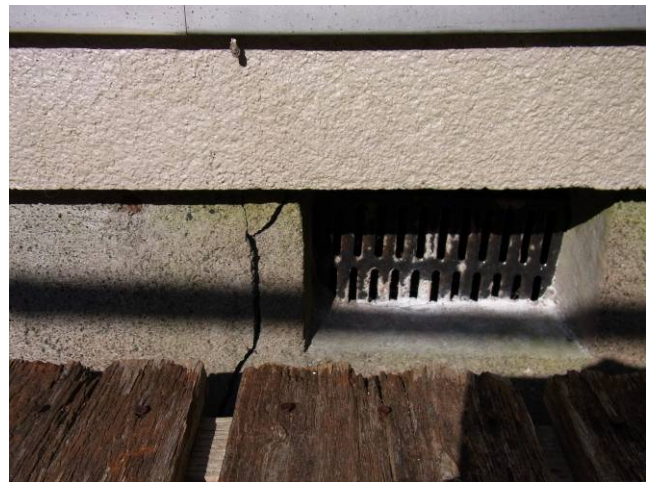
写真 6-29-5 基礎に生じたひび割れ
