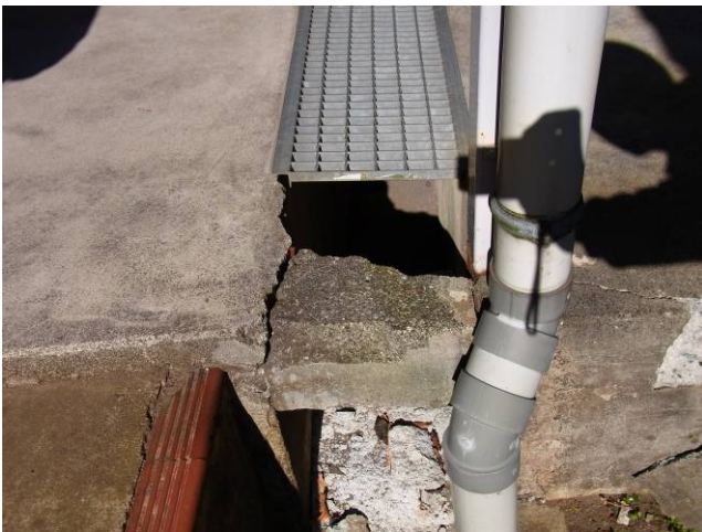
写真 6-10-2 校舎と体育館の間の側溝被害
