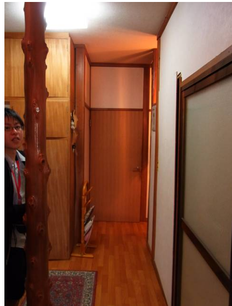
写真 6-27-9 上部構造の残留変形（右側が下がっている）
