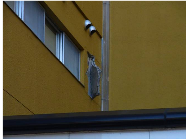
写真 6-20-3 本館と渡り廊下間の Exp.J に隣接する外壁が剥落 (3階)
