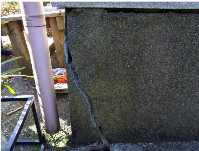
写真 6-29-4 基礎隅角部の欠け
