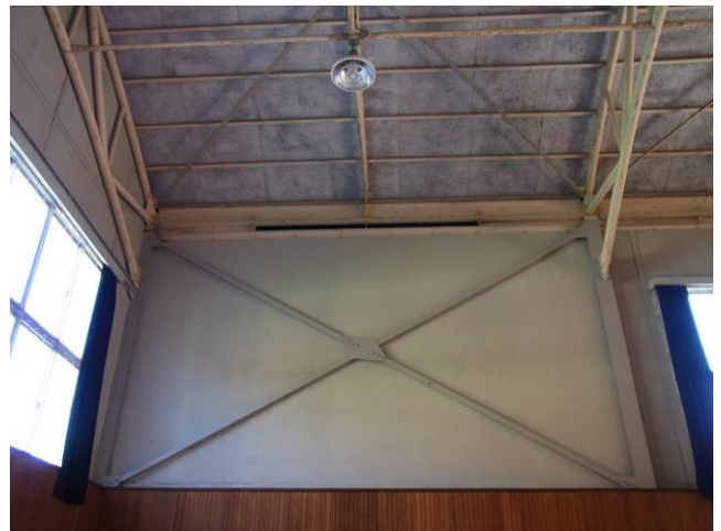
写真 6-10-3 体育館屋根梁下の化粧板落下
