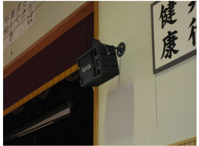
写真 6-8-5 スピーカー落下 (補修済)
