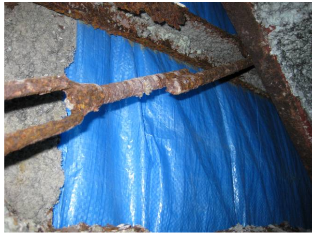
写真 6-19-5 ブレース施工不良か
