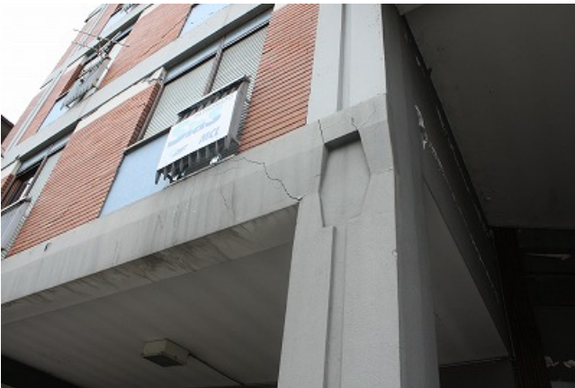
写真 19 2階床梁のせん断ひび割れ(?) (8)
