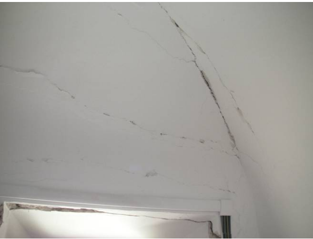
写真15 外壁のせん断ひび割れ
