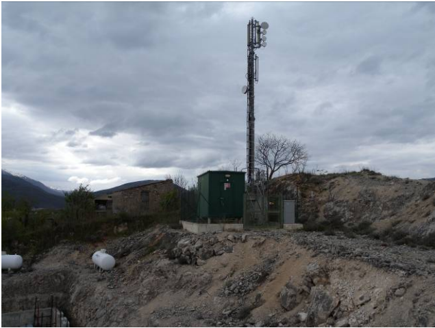
写真29 強震計 FA030 の設置状況
