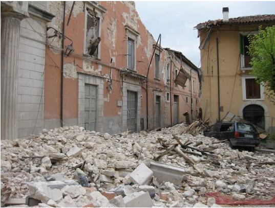
写真30 落下した外壁により車が下敷
