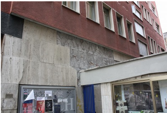
写真3 鉄骨埋め込み部周辺の損傷(2)
