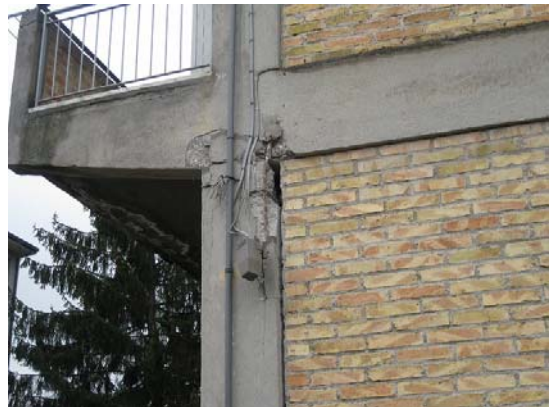
写真 25 柱頭部の接合部にひび割れ
