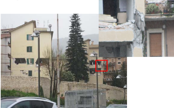
写真 20 中間階の組積壁の崩落が目立つ
