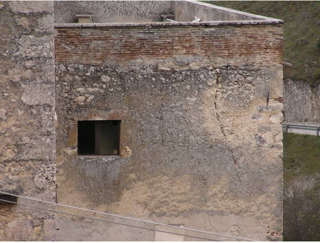
写真13 外壁のせん断ひび割れ
