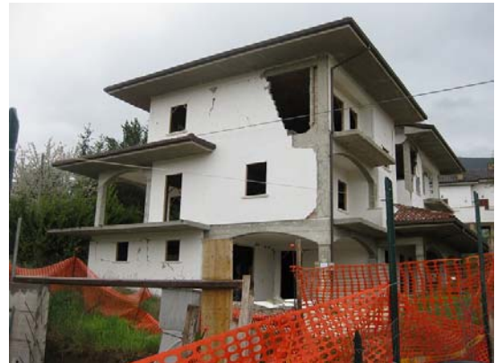
写真 3 RC 住宅の組積壁せん断破壊と仕上剥落
