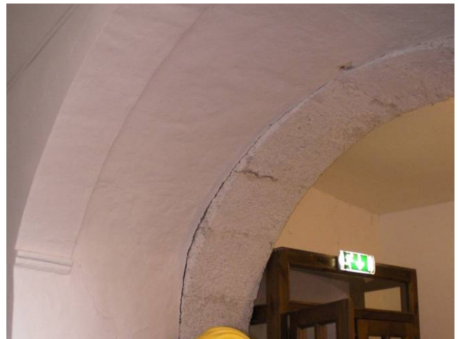
写真16 バルコニーのひび割れ
