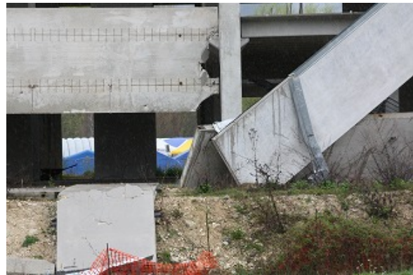
写真11 PC 外壁と床版の崩壊
