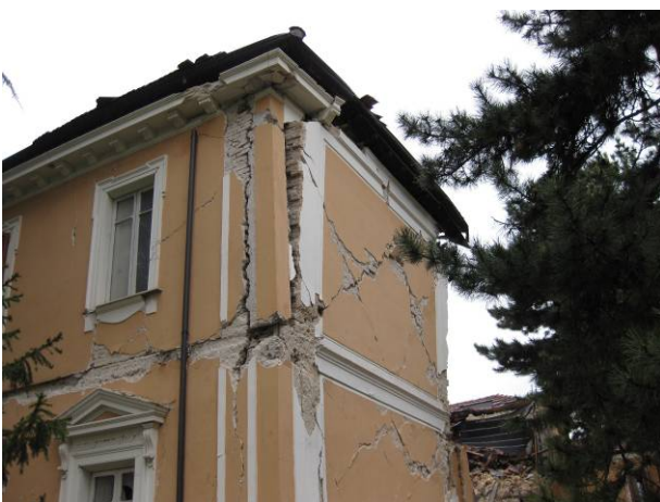
写真10 建物③：2階の短辺方向の壁が面外方向に傾斜
