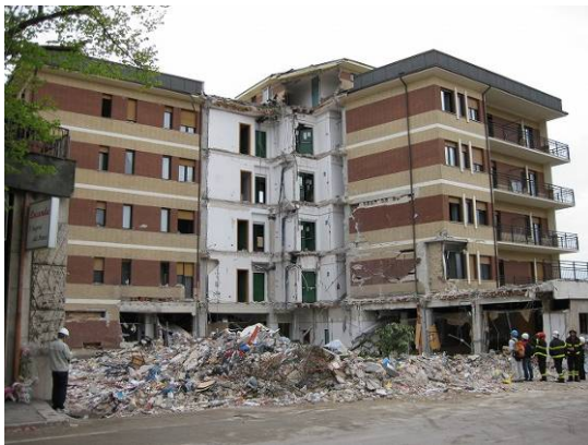
写真 34 学生寮の崩壊
