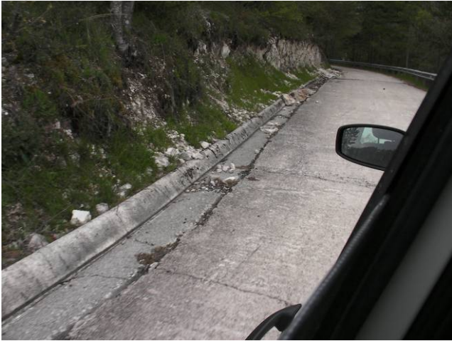
写真7 道路の亀裂と落石の状況
