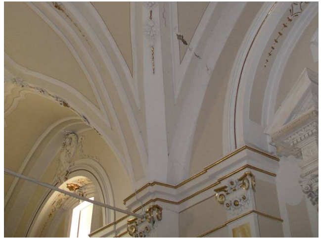
写真 20 ヴォールト天井のひび割れ
