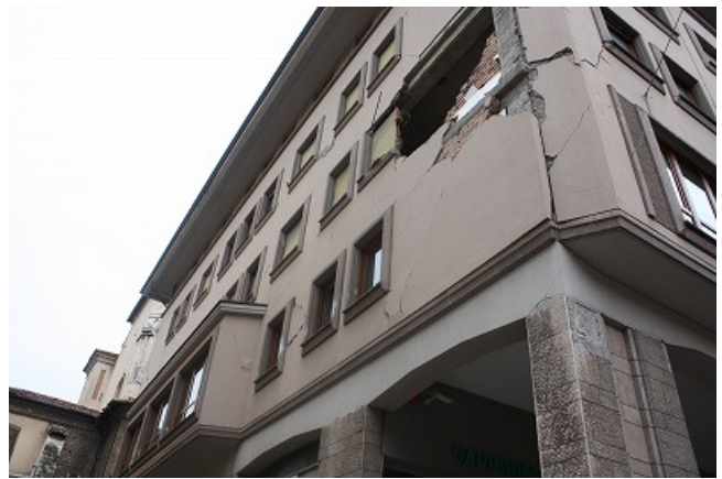
写真12 隅角部の損傷とブロック壁の崩落(4)
