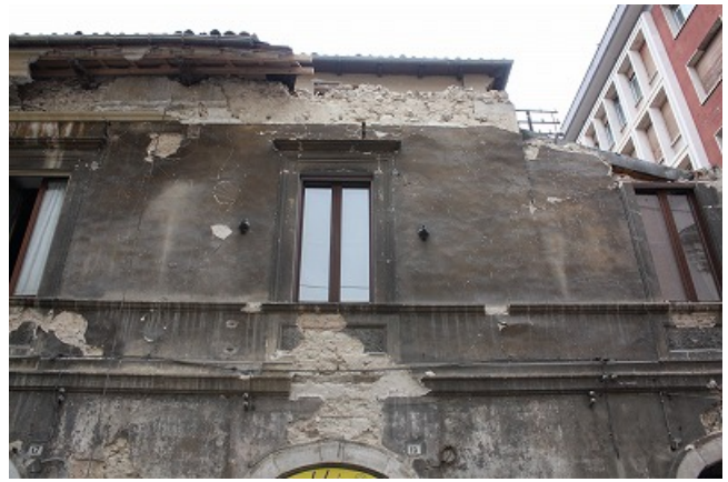
写真8 調査区域内にあった礎石造建物の被害(3)
