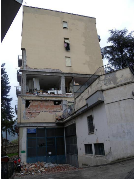
写真 12 建物④：3階の空洞煉瓦壁が完全に崩れて落下している。柱断面が2階、4階でしぼられている。
