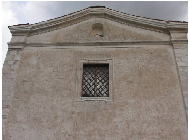
写真 22 ファサードのひび割れ
