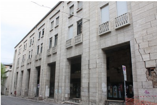
写真13 柱のふかし部の損傷と柱脚タイトルの剥落(5)
