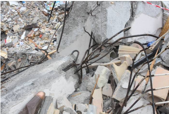
写真3 建物① ：主筋と思われる鉄筋はほとんど丸鋼に近い
