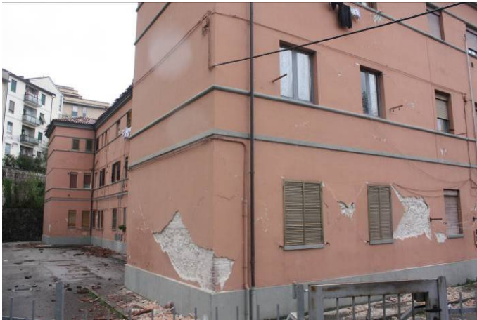
写真 18 建物⑥：壁の被害
