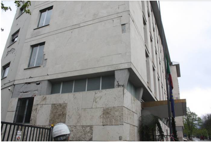
写真7 建物②：短柱のせん断破壊
