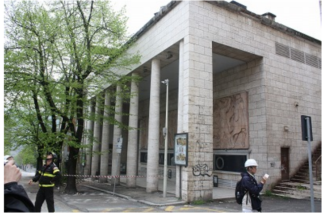
写真 16 1層映画館：柱脚にひび割れ(6)
