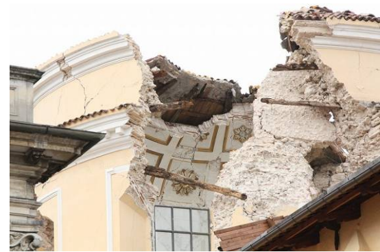
写真9 崩壊したドーム
