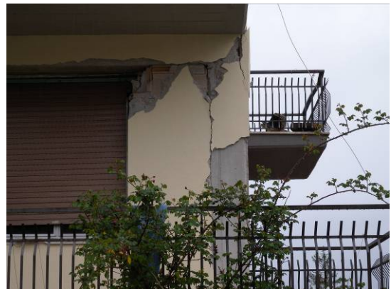
写真 19 隅柱の柱頭接合部にせん断ひび割れと付着ひび割れ
