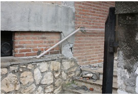
写真 28 柱脚部のせん断ひび割れ
