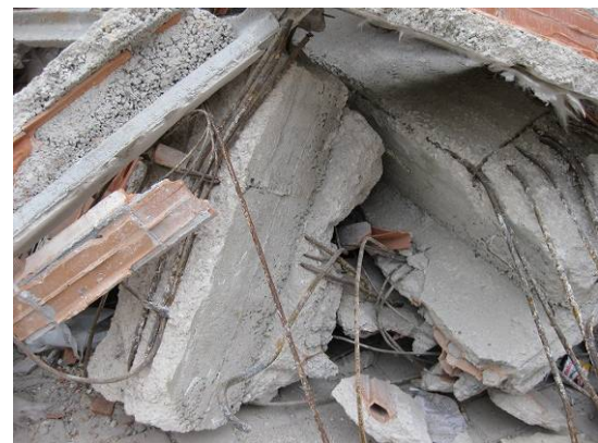
写真 39 寮崩壊付近の RC 部材の残骸
