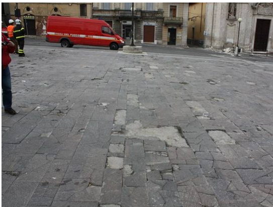
写真6 浮きや割れの生じた石畳
