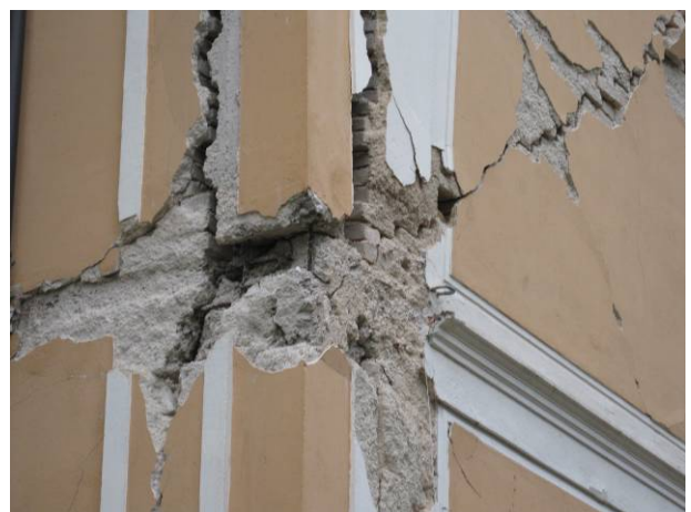
写真11 建物③：接合部の破壊状況
