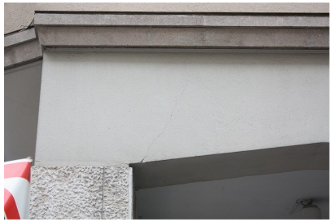
写真10 梁のひび割れ(曲げひび割れ?)(4)
