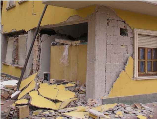
写真14 煉瓦ブロック壁の面外崩壊
