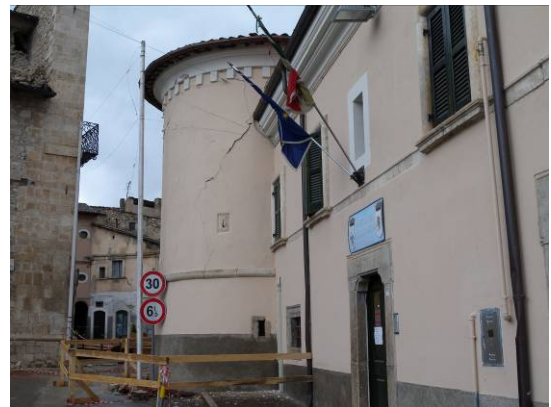
写真 15 教会前建物の円筒組積壁のひび割れ
