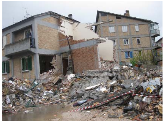
写真 23 低層 RC 造の崩壊
