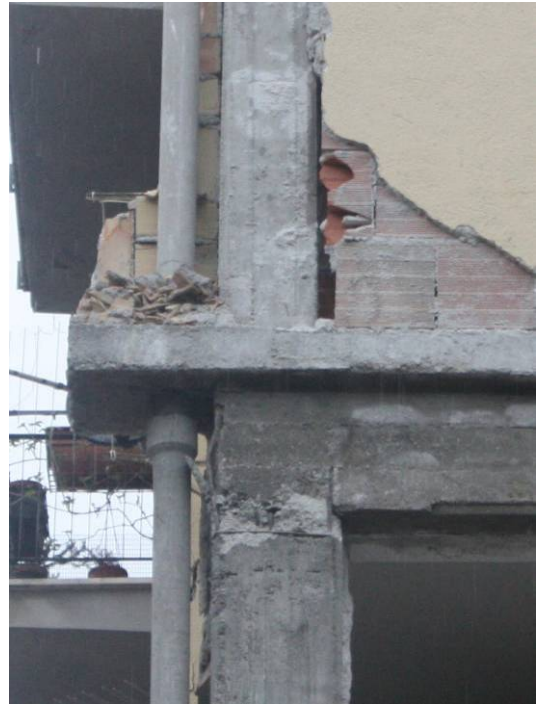
写真 13 建物④：3階と4階の柱で断面変更。接合部の鉄筋がはらみ出している。
