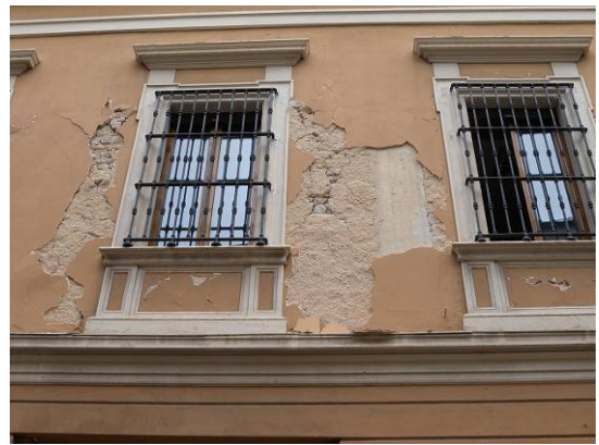
写真 19 仕上モルタルが剥離しRC柱が露出
