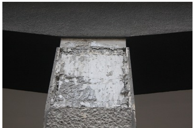
写真6 ピロティ部柱の柱頭の仕上げ材剥落(2)
