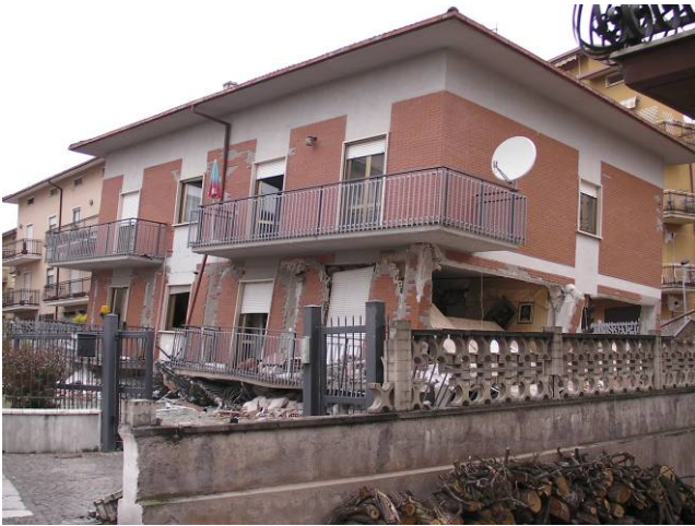
写真10 1階層崩壊の様子1
