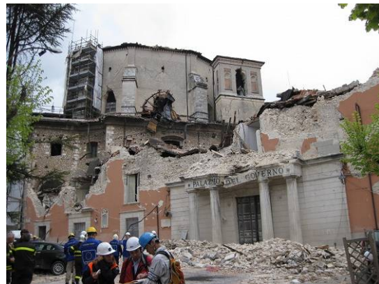
写真29 組積造の2階部分が崩壊
