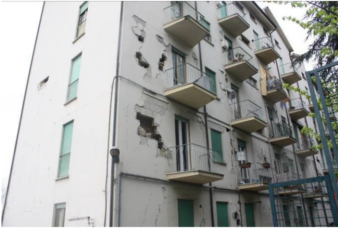
写真 16 建物⑤：空洞煉瓦壁の損傷
