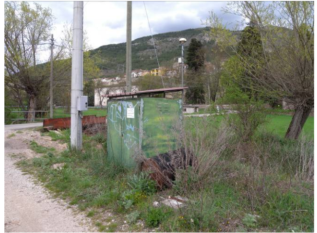
写真30 強震計 GX066 の設置状況
