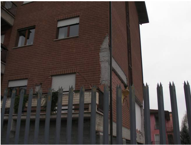
写真16 開口部間のせん断ひび割れ
