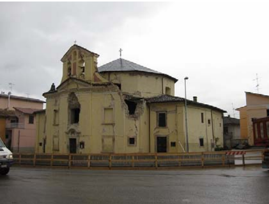
写真 14 教会の組積壁の崩落
