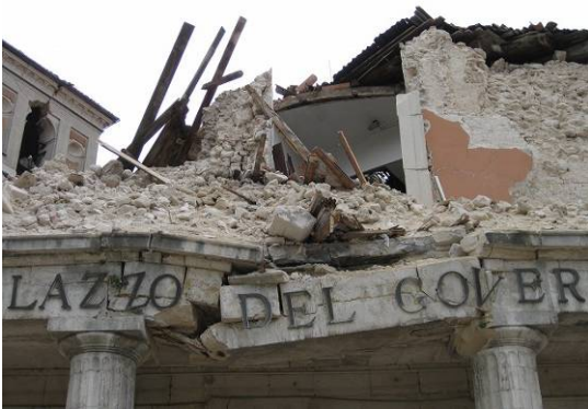
写真28 組積造 PLAZZO DEL GOVERNO の崩壊
