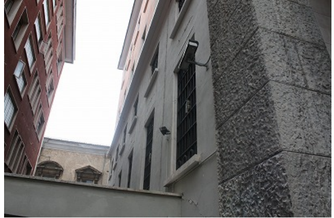
写真2 埋め込まれた鉄骨による損傷(1)
