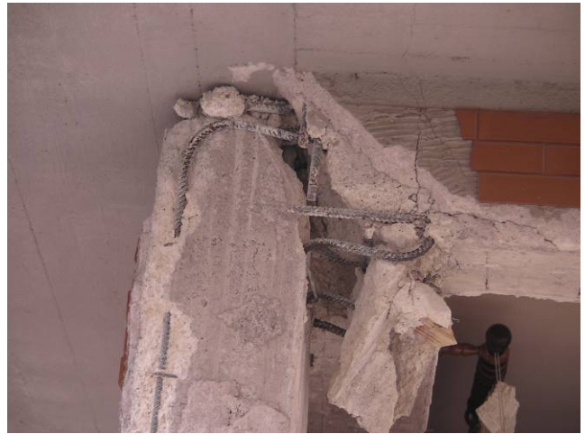
写真9 柱梁接合部の破壊状況
