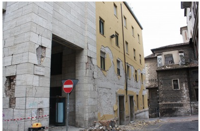
写真14 建物側面の仕上げ部の剥落(5)
