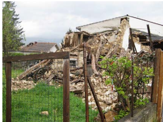
写真13-1 組積造の崩壊
