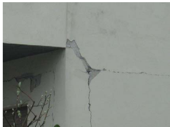
写真 17 隅柱の柱頭接合部にせん断ひび割れ
