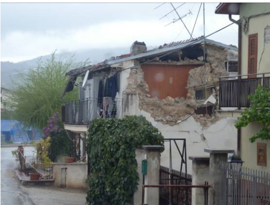
写真 18 石積+土目地壁の崩壊
