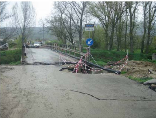
写真8 Onna へ渡るの橋の接続道路の崩落
