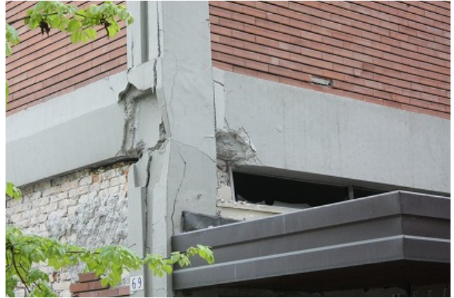
写真 18 1階ピロティ柱頭-接合部の損傷(8)
