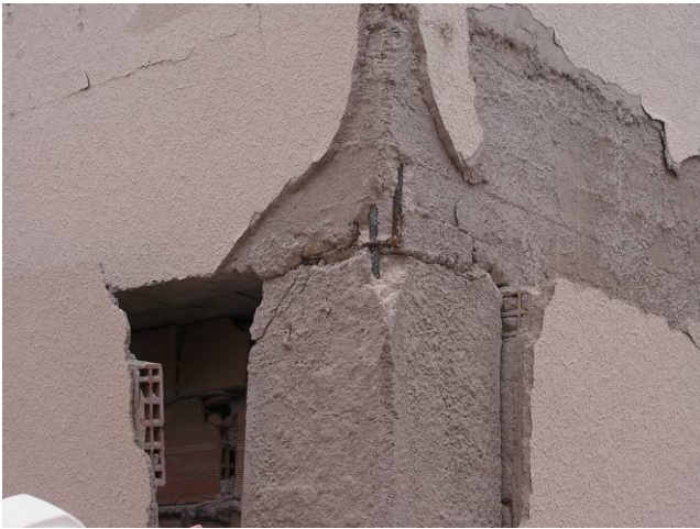
写真8 柱頭の破壊状況
