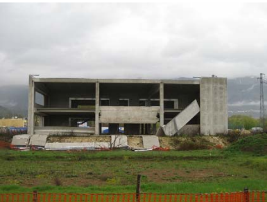
写真10 建設中の PCa 造工場の被害
