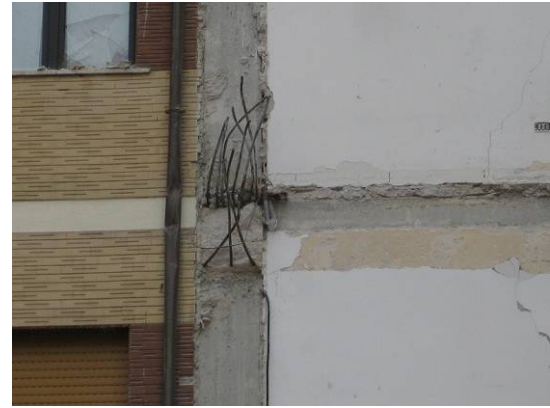
写真 37 4階連結梁主筋の露出と非連結の床
