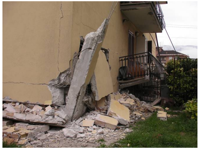
写真11 1階層崩壊の様子2
