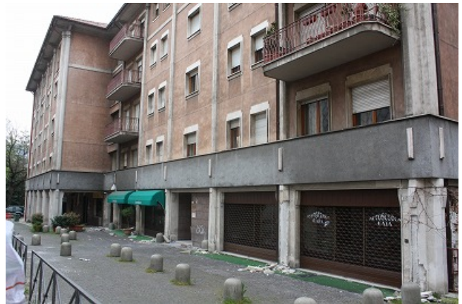
写真 20 EXP.ジョイントで繋がるホテル 損傷小(9,10)
