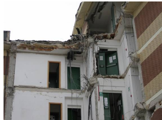
写真 35 増築部分の梁鉄筋が露出
