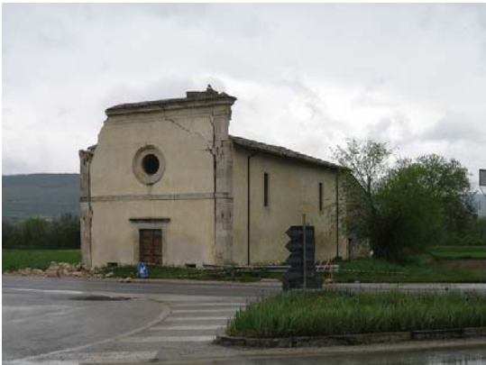
写真 2 余震による組積造教会の破損
