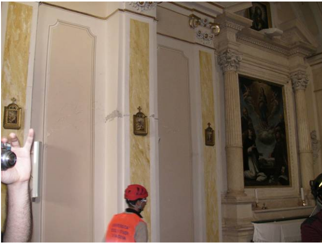
写真 19 柱・壁の水平ひび割れ
