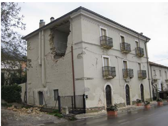
写真 4 組積造の外壁 2 階部分の崩落
