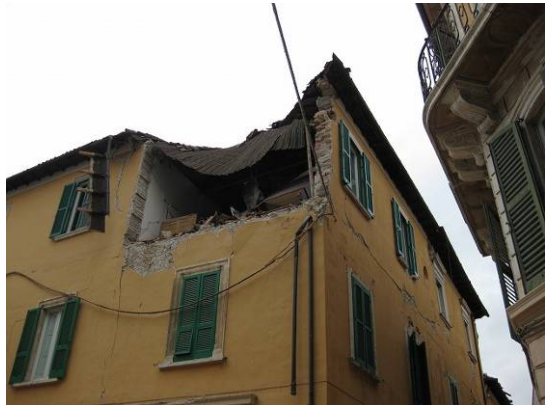
写真 25 組積造3階部分の外壁が崩落
