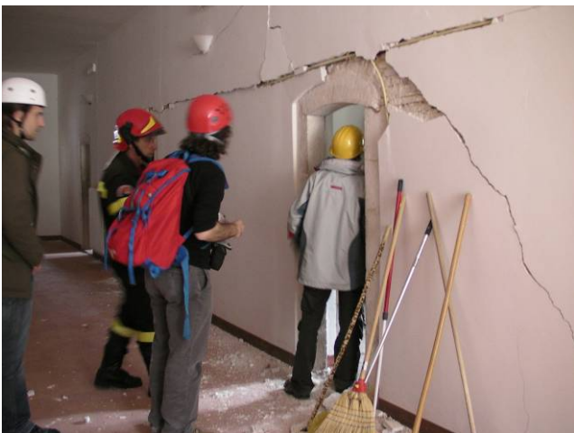
写真11 壁のせん断ひび割れ
