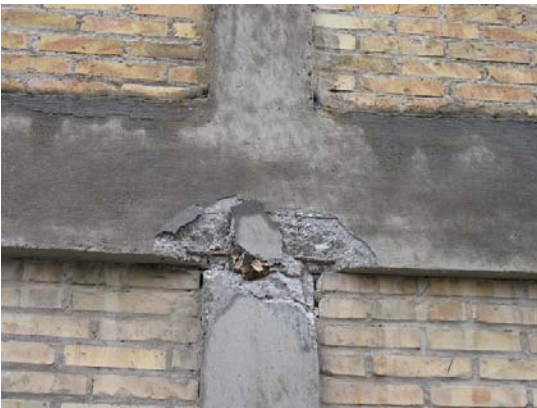
写真 22 柱頭部のひび割れ (非常に細いせん断補強筋)
