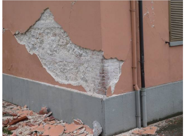
写真 19 建物⑥：柱は煉瓦、壁は石積で約 50cm ごとにレベルをとるためのレンガを挿んでいる
