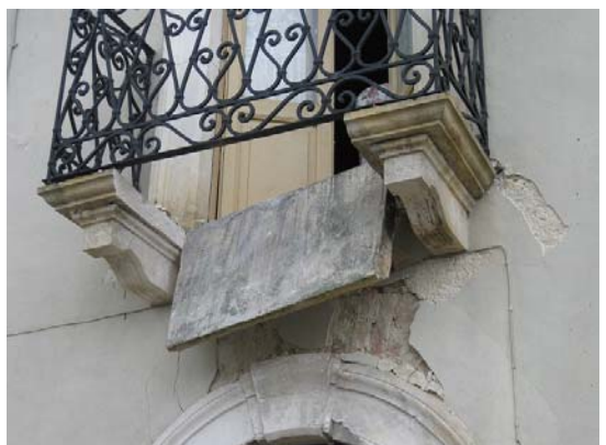
写真 5 バルコニーの石が割れている
