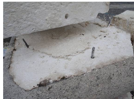
写真11 ダボ筋と石膏のような材料による結合
