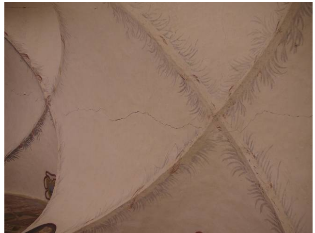
写真18 回廊ヴォールトのひび割れ
