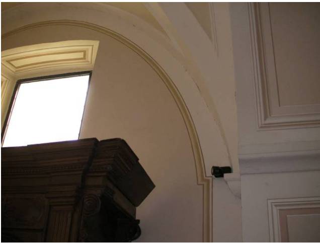
写真 21 アーチに沿うひび割れ
