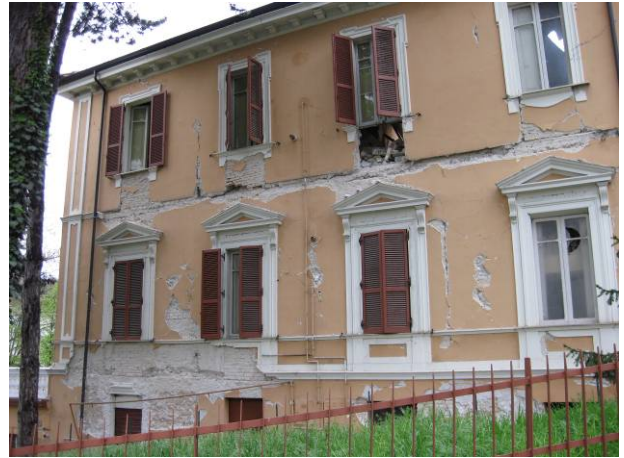
写真9 建物③：長辺方向の損傷状況
