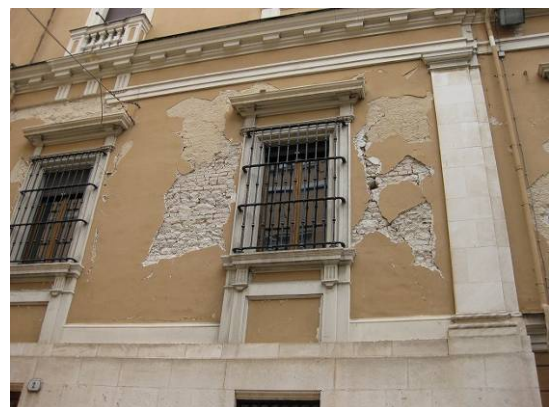
写真 17 天然石の組積壁の破壊と仕上の剥落
