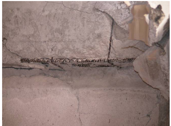
写真13 かぶり・鉄筋腐食の様子
