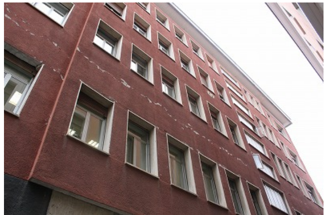
写真4 壁のひび割れ（2,3階境界位置）(2)
