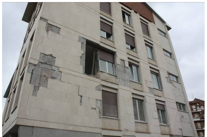
写真6 建物②：仕上げ材の剥落
