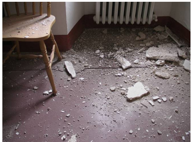
写真12 外壁の面外変形に伴う床のひび割れ
