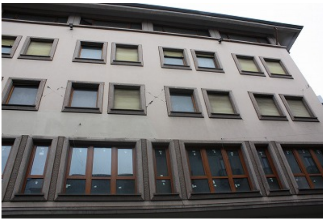
写真11 柱のせん断ひび割れ(4)
