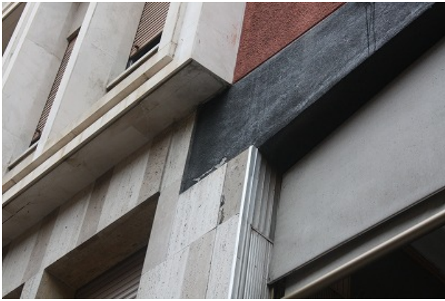
写真7 梁のせん断ひび割れ(2)
