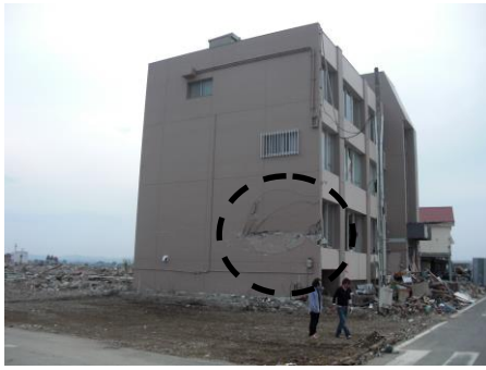
図2 漂流物の衝突による外壁の損傷（名取市）
