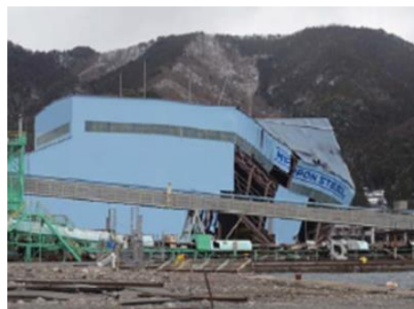
図1 船首衝突により崩壊した建築物（釜石市） 2)
