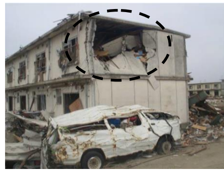
図3 漂流物の衝突による外壁の損傷（名取市） 11)
