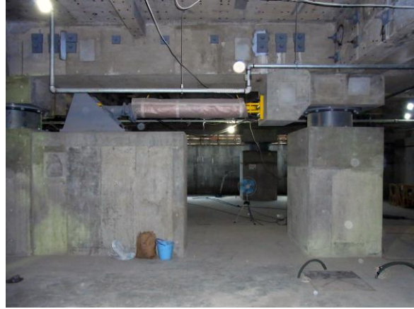
写真 2-3 地下1階免震装置とオイルダンパー
