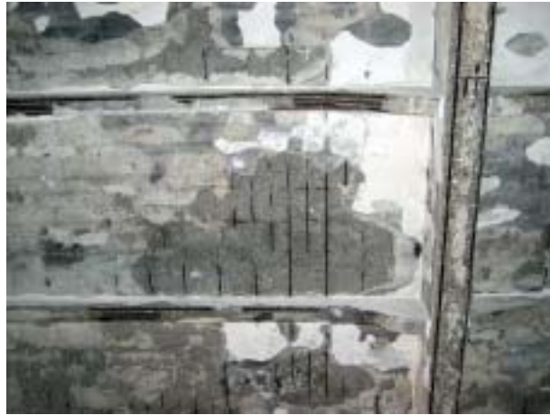
図 3-9 天井および梁のかぶりコンクリート剥落の様子
