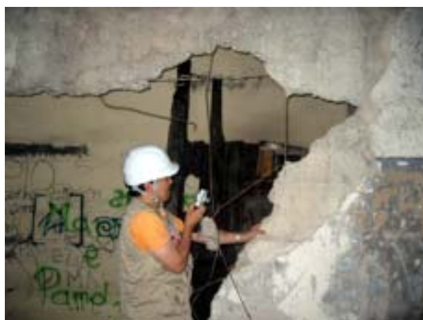
図 3-5 壁の崩落箇所
