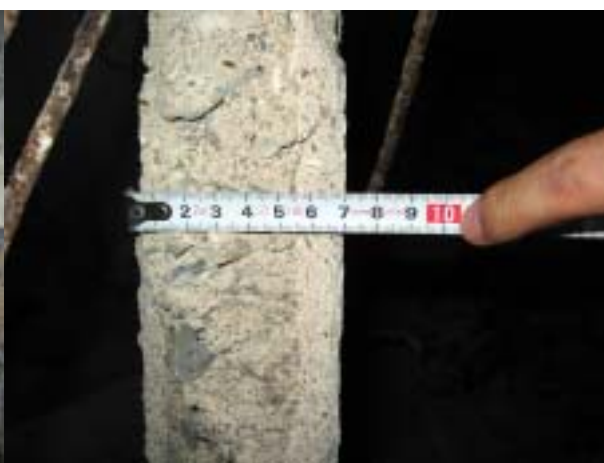
図 3-6 崩落した壁の断面
