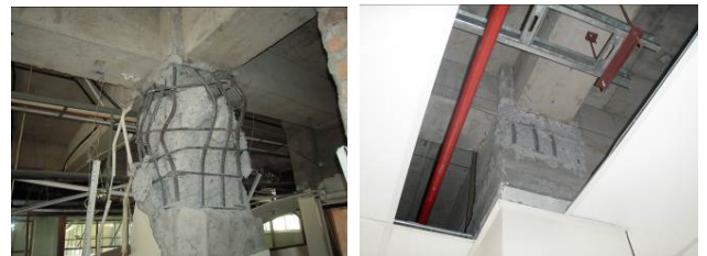
写真2 損傷度Vの柱 写真3 損傷度IVの柱
