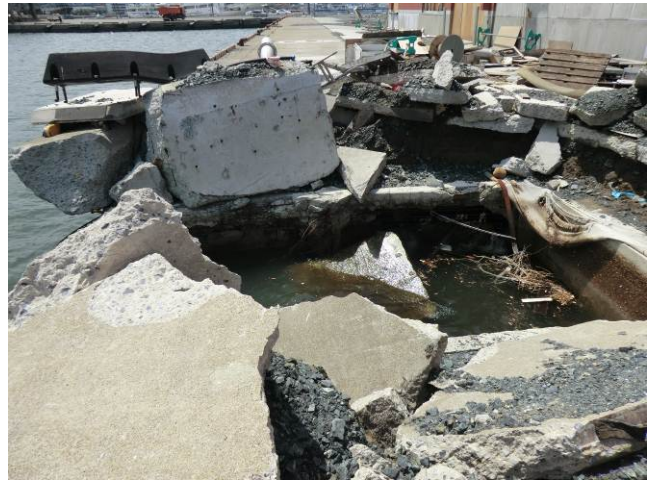
写真 3-2-4-4 堤防損傷状況
