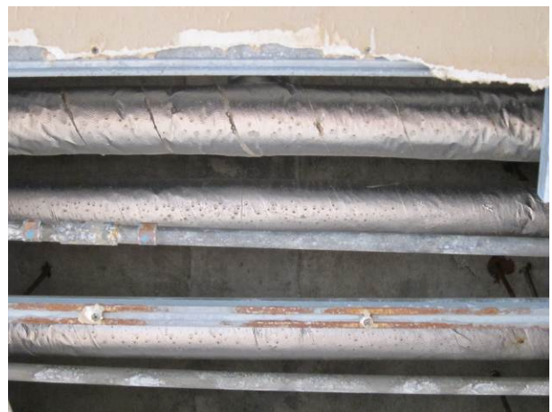
写真 3-14-16-4 2階の天井裏配管に汚濁水滴の痕跡
