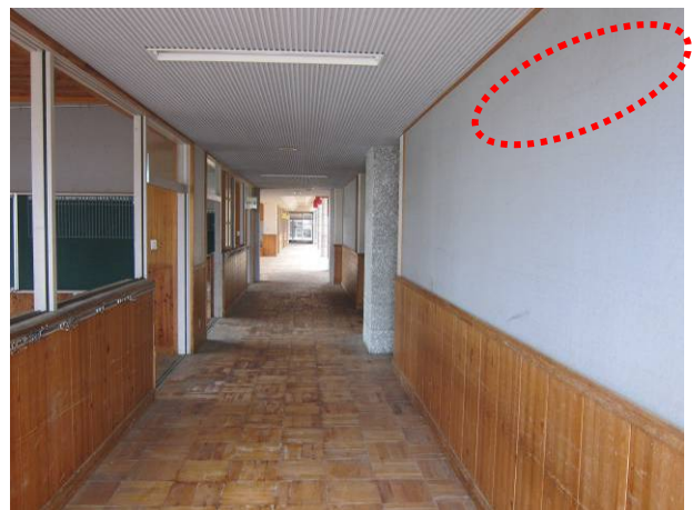
写真 3-30-1-2 東に出入口を有する廊下の津波痕跡
