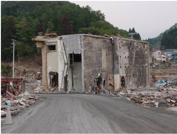
写真 3-18-1-1 転倒した冷凍倉庫
