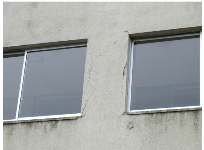
写真 3-2-17-2 校舎のせん断ひび割れ
