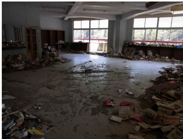
写真 3-13-6-4 特別教室棟 3階の被害状況
