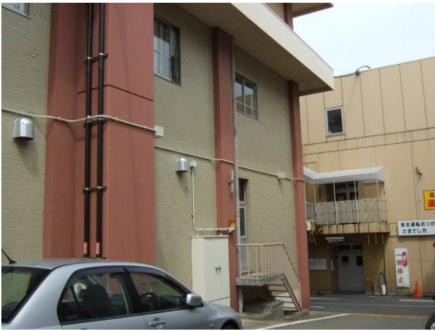
写真 3-2-15-3 以前せん断亀裂を生じた壁
