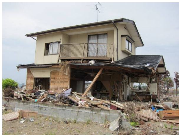
写真 3-30-13-1 海側隅角部の損傷が激しい木造2階住宅
