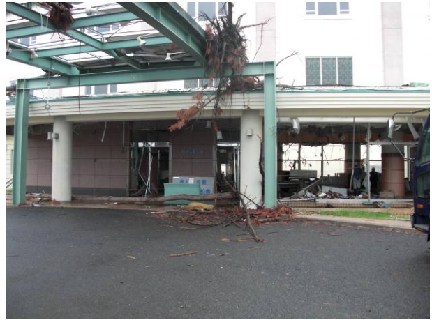
写真 3-20-1-2 かんぼの宿の被災状況
