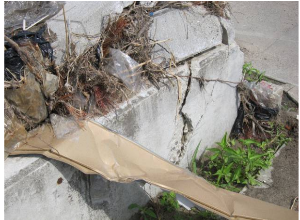
写真 3-30-19-2 RC 基礎のクラック
