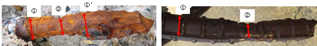
写真 4.1.1.1 閑上魚市場の RC 柱 (UT_NAT-01) の鉄筋腐食の様子
