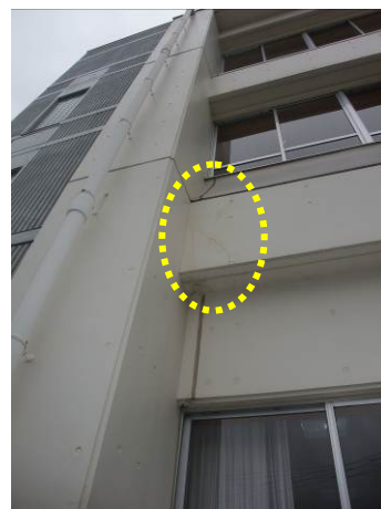
写真 3-14-4-6 梁にひび割れ多数発生
