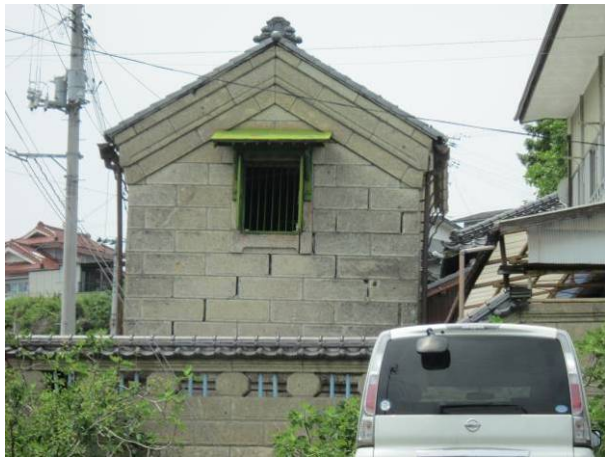
写真 3-23-site1-1 石造蔵の震動被害
