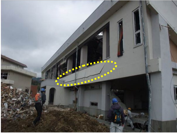
写真 3-14-1-5 体育館の被害の様子
