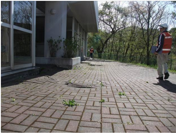
写真 3-13-21-5 建物周囲地盤の沈下1
