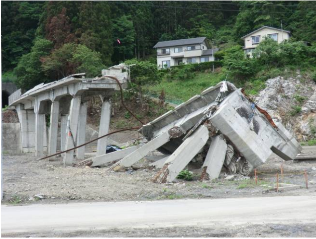
写真 3-7-6-3 大きく傾斜した鉄道橋
