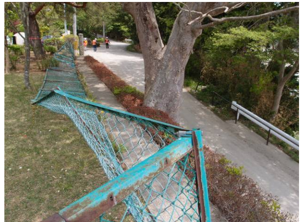
写真 3-17-5-2 公園周辺フェンスの破損
