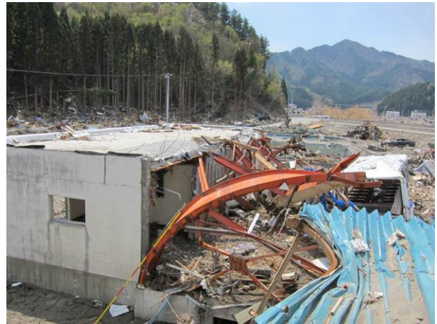
写真 3-13-7-4 屋内体育館の損傷状況
