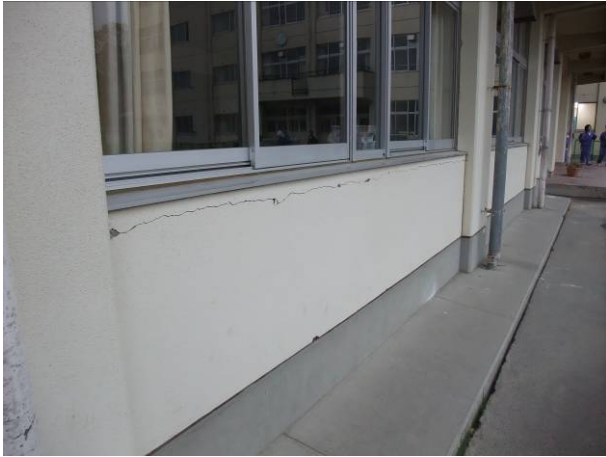
写真 3-33-3-3 腰壁上部水平方向に生じたひび割れ
