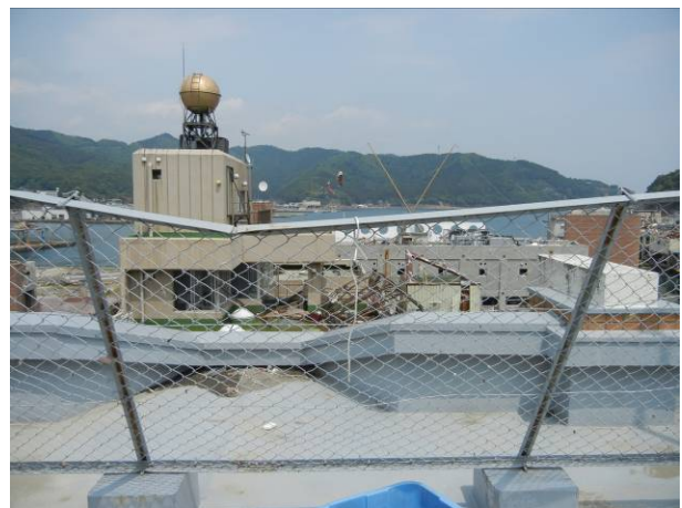
写真 3-18-12-4 海側からなぎ倒されるフェンス
