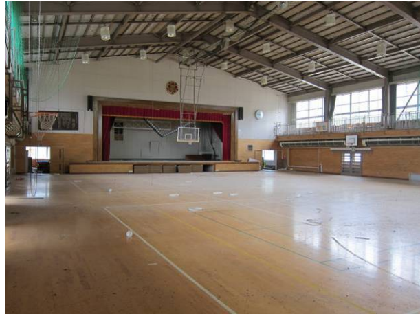
写真 3-32-2-12 照明器具が落下した体育館内部
