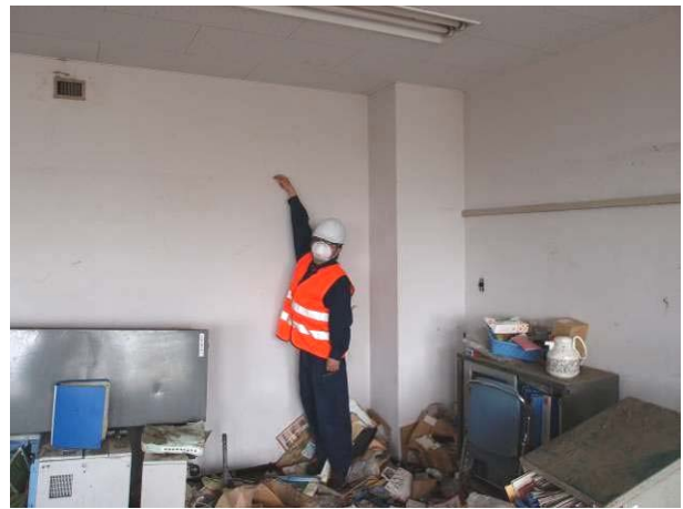
写真 3-16-4-4 2階床レベル+2mに浸水痕
