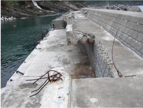
写真 3-7-4-1 崩壊したスラブ
