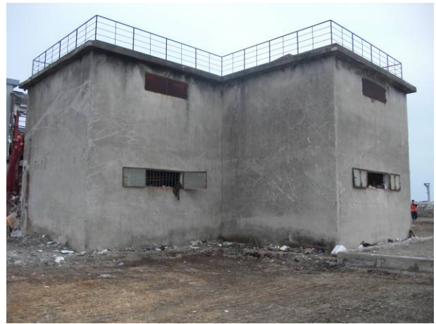
写真 3-27-5-2 残存した CB 造 2 層建物の北東面
