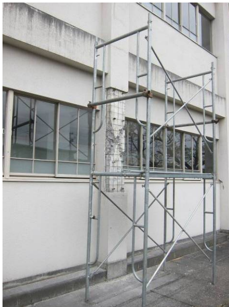
写真 3-32-3-7 実習棟のせん断破壊した柱
