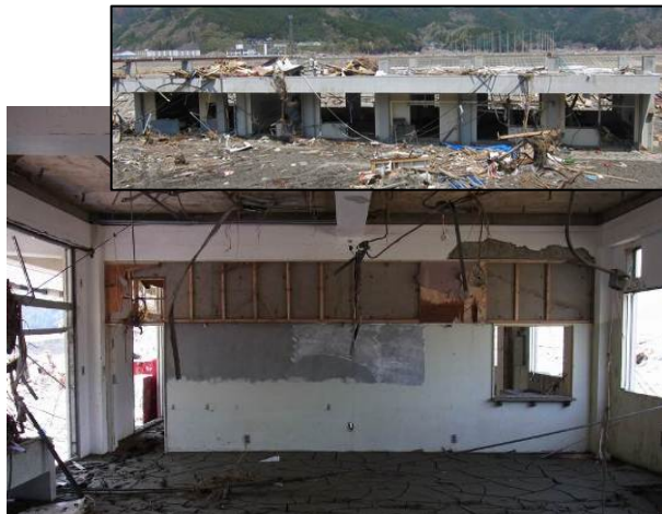
写真 3-13-6-6 技術棟の全景および被害状況
