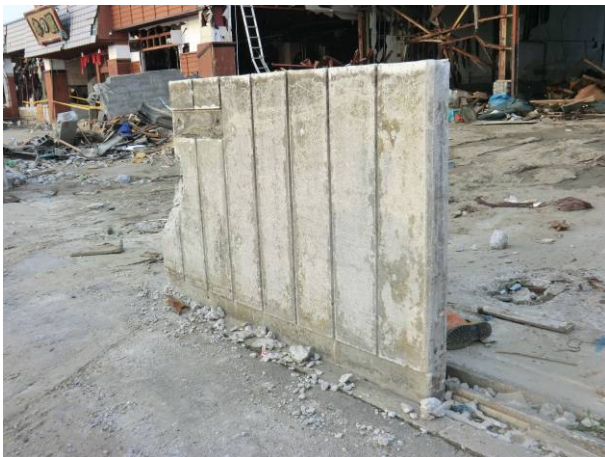
写真 3-19-7-1 一部破損するも残存したRC塀
