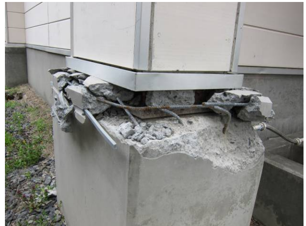
写真 3-32-2-8 柱脚部コンクリート剥落・鉄筋座屈
