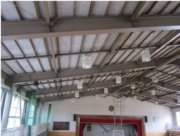
写真 3-32-2-13 屋根ブレースが座屈
