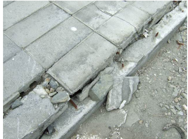
写真 3-14-6-2 CB 塀縦筋の破断
