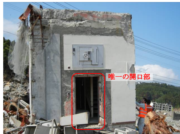
写真 3-17-6-2 RC 造平屋構造物の被害状況
