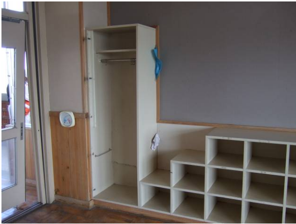
写真 3-30-14-3 津波痕跡を確認した掃除道具入れ
