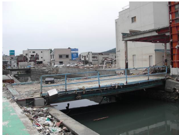
写真 3-14-11-1 橋手すり 2 の被害の様子
