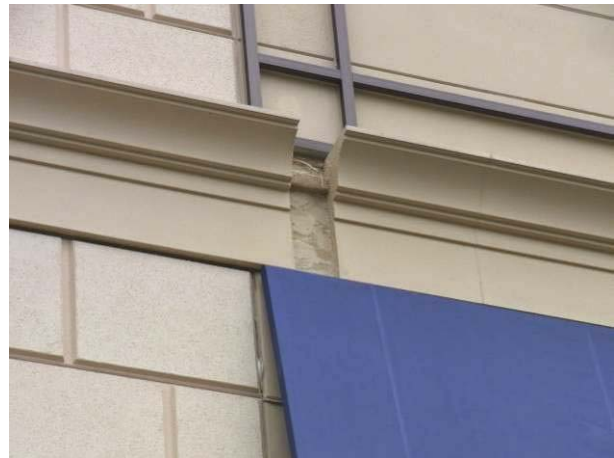
写真 3-33-1-2 外装材の脱落
