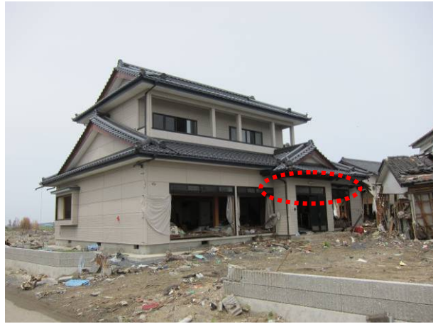
写真 3-29-4-3 建物側面の津波痕跡
