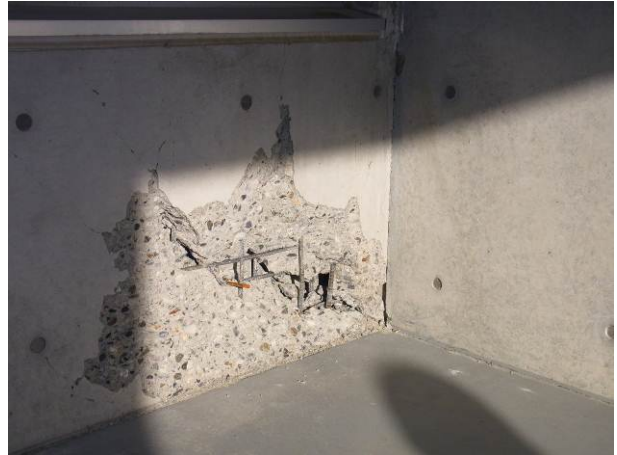
写真 3-13-23-4 腰壁の損傷状況
