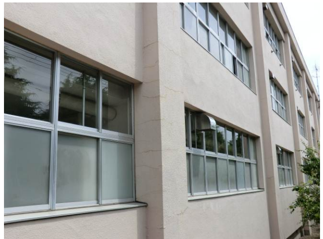
写真 3-2-18-2 多数のひび割れ補修跡
