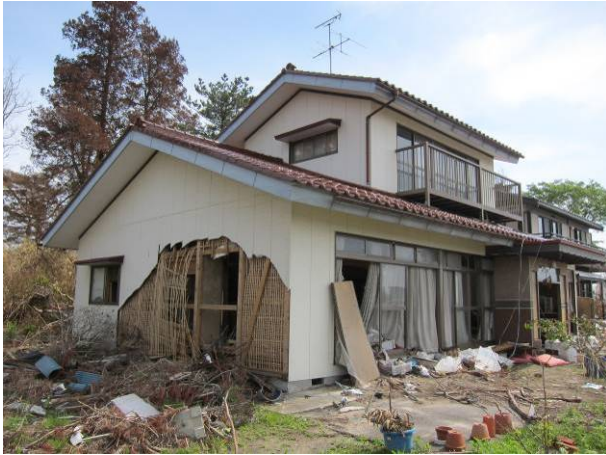
写真 3-30-20-1 浸水深を計測した住宅
