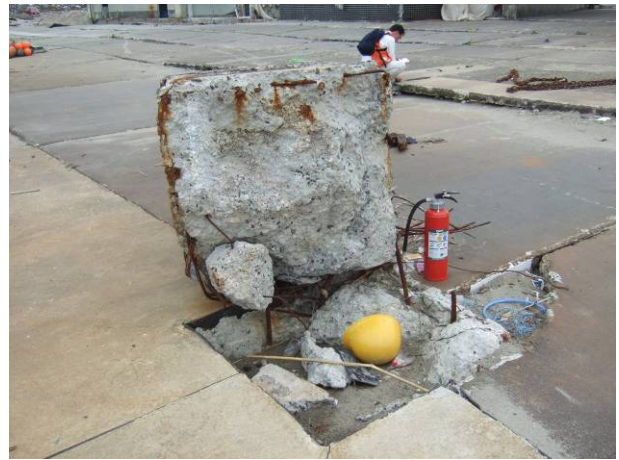
写真 3-27-1-2 崩壊した断面
