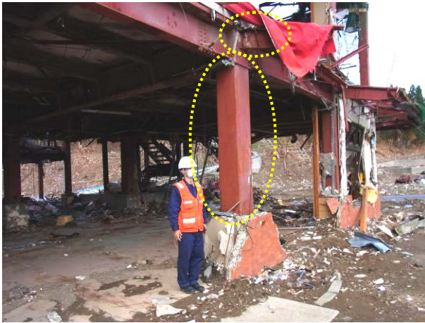
写真 3-9-3-3 庇用鉄骨損傷大／主フレーム損傷軽微
