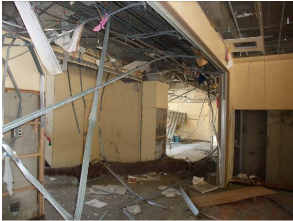
写真 3-13-4-3 校舎内の被害の様子
