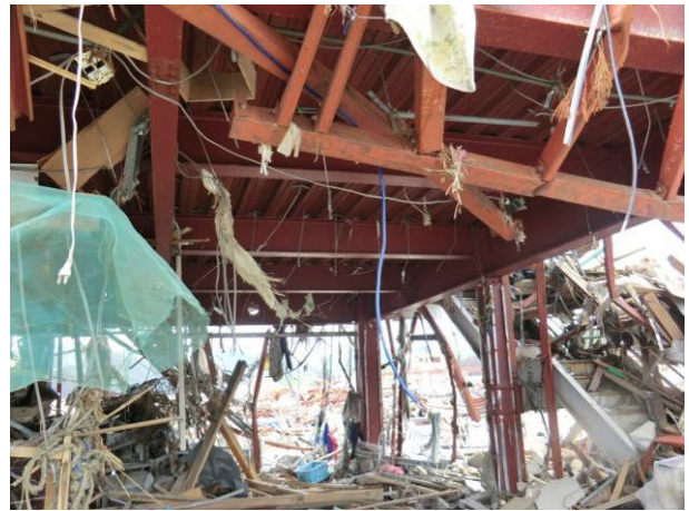
写真 3-17-1-4 防炎対策庁舎内部の被害状況
