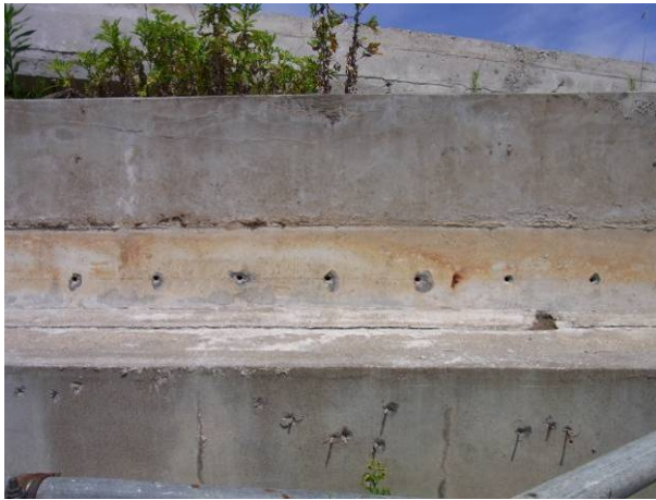
写真 3-22-3-3 CB 塀基礎水平方向のダボ穴
