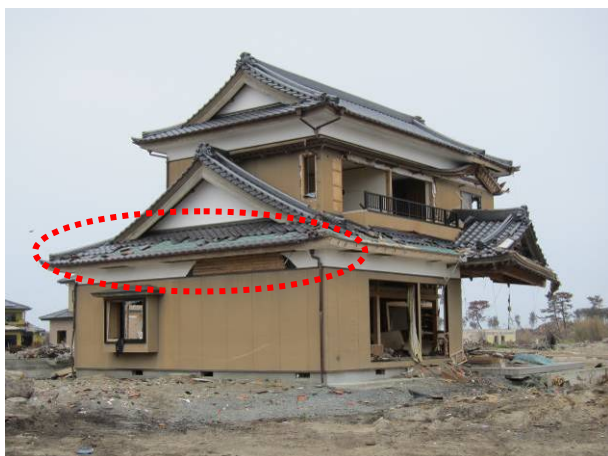
写真 3-29-4-1 背面の津波痕跡
