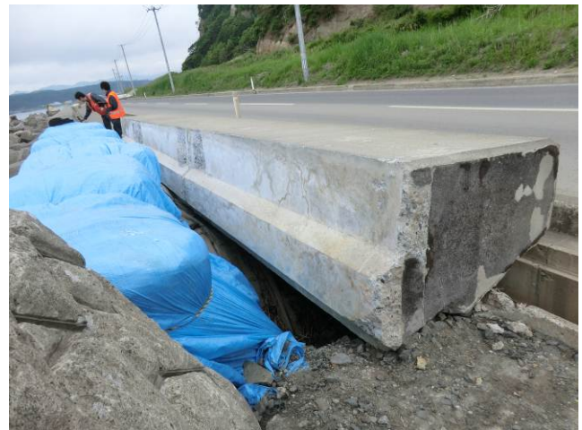
写真 3-3-4-2 転倒した堤防
