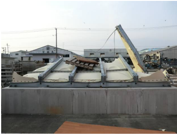
写真 3-19-5-1 支柱が転倒した FRP 水槽
