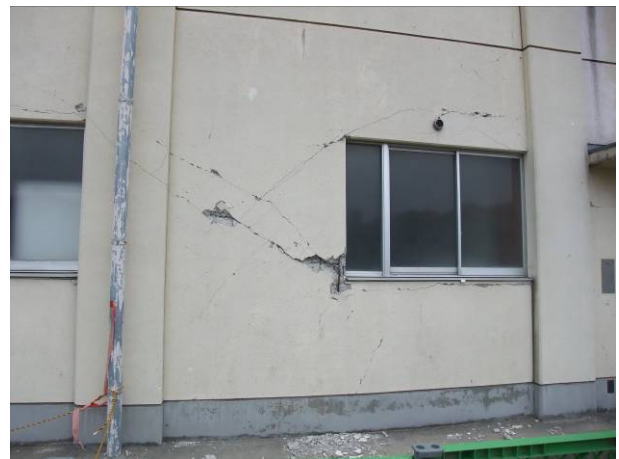
写真 3-33-3-2 壁・柱を貫くせん断ひび割れ
