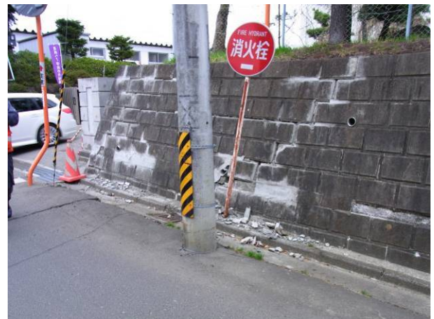
写真 3-33-2-8 正門横の擁壁が一部崩落
