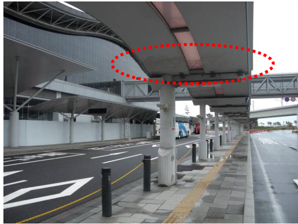
写真 3-27-8-1 仙台空港ロータリーの庇の津波痕跡
