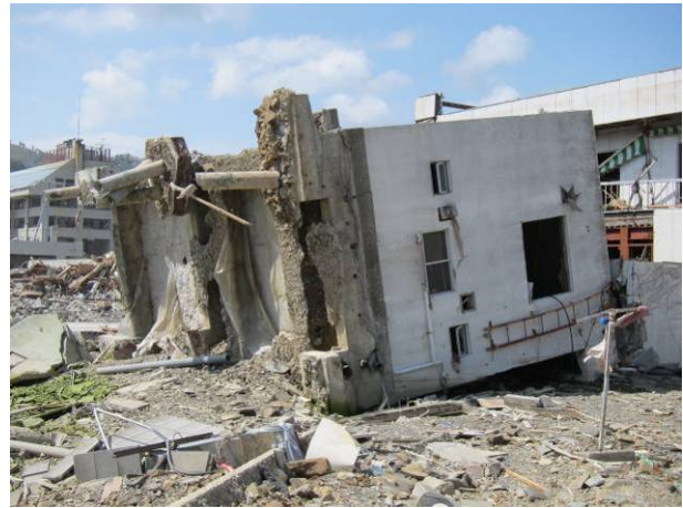
写真 3-18-7-2 折損した杭が残る底面と東立面
