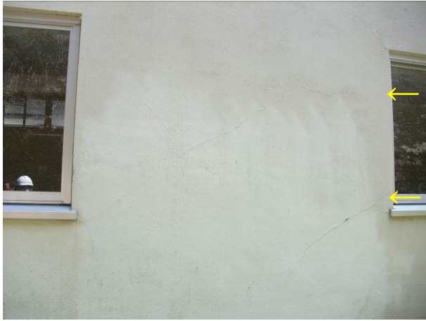
写真 3-13-20-3 雑壁の損傷状況
