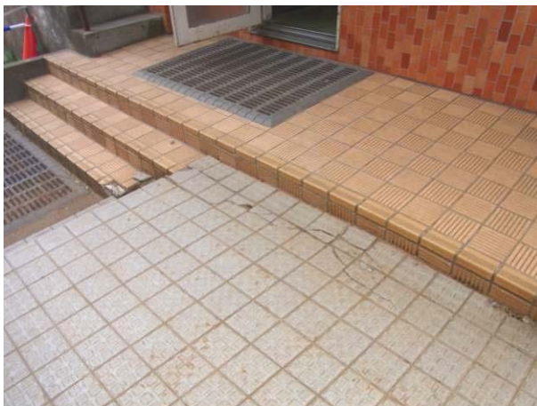
写真 3-33-2-7 地盤変状に伴う建物周りの被害
