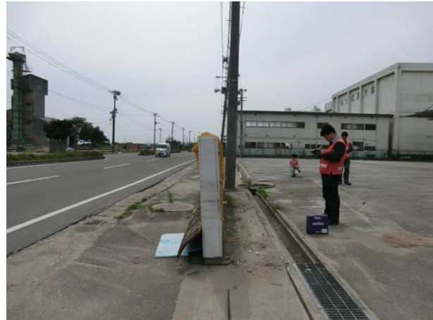
写真 3-25-3-2 ST 冷蔵前 RC 塀の傾斜
