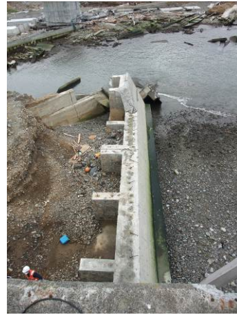
写真 3-14-2-2 堤防の損傷状況 2
