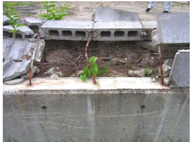
写真 3-25-9-2 CB塀の転倒部詳細
