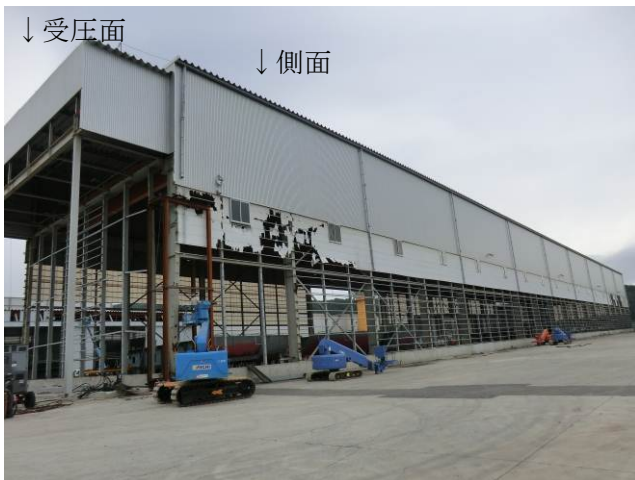
写真 3-3-5-1 工場外装材受圧面および側面の破損
