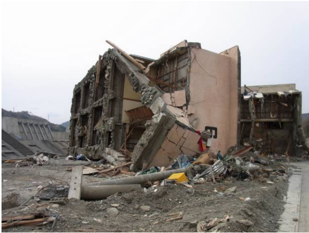
写真 3-12-3-5 転倒住宅 (6号棟)
