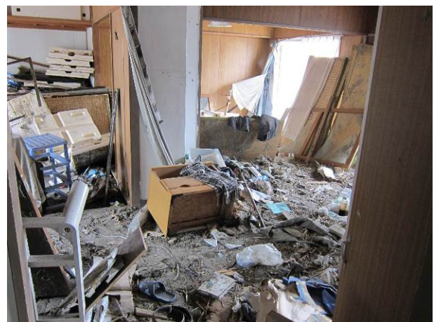
写真 3-13-2-2 片岸住宅 2 階の内部の様子
