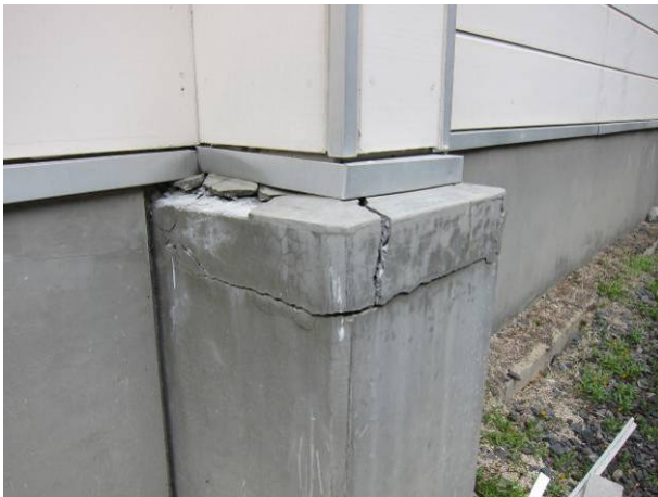
写真 3-32-2-7 柱脚部コンクリート剥落前
