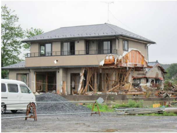
写真 3-20-site1-1 木造住宅の被害
