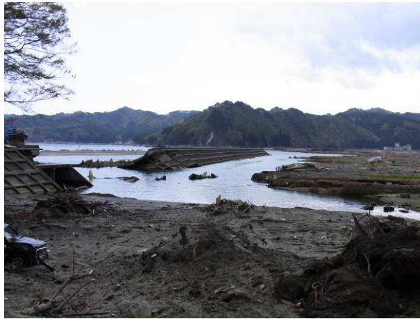
写真 3-13-site1-1 KG 集合住宅近くの堤防の被害の様子
