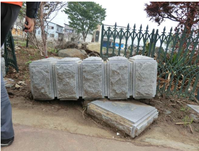
写真 3-4-1-1 転倒した石造門柱
