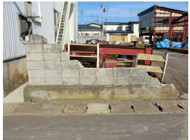
写真 3-2-9-2 隣の CB 塀 (一部損壊)
