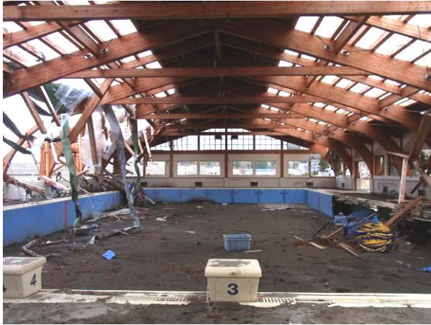
写真 3-8-1-3 プール棟内部の被害状況
