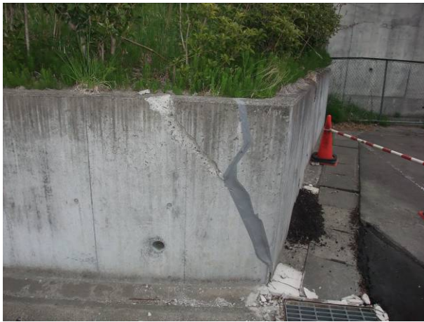
写真 3-33-3-5 擁壁の亀裂（コーキング材で補修）
