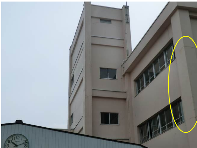
写真 3-2-18-1 校舎のひび割れ
