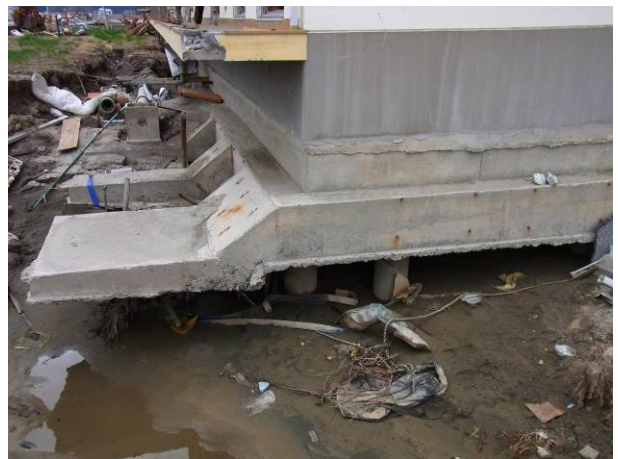
写真 3-15-1-4 隅角部の洗掘
