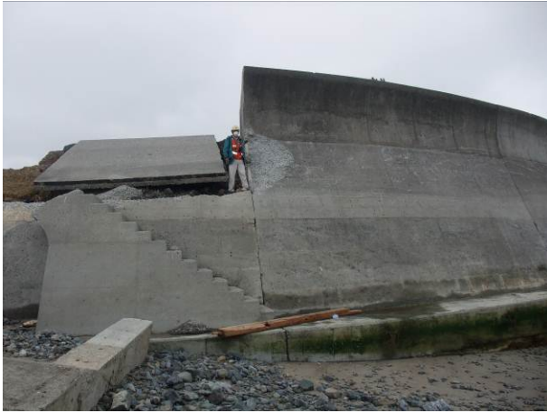
写真 3-14-2-1 堤防の損傷状況 1
