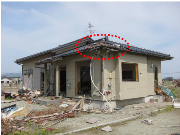
写真 3-30-20-3 受圧面の瓦破損
