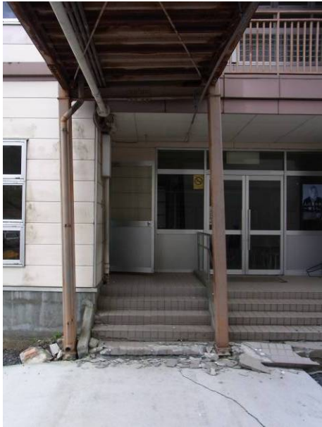
写真 3-32-2-11 体育館前通路の庇が傾斜
