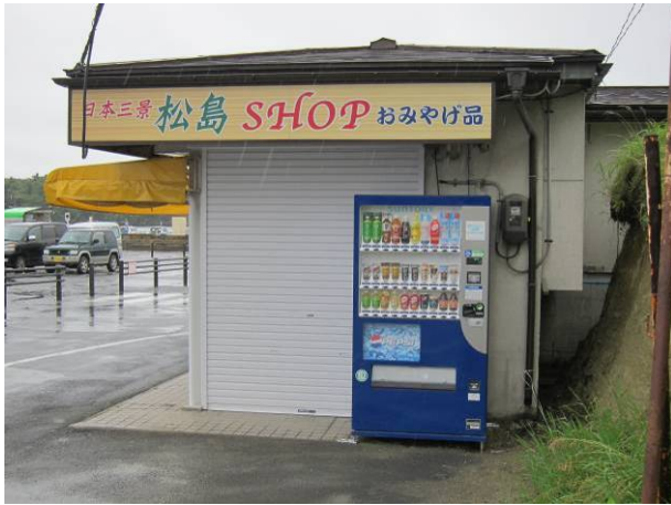
写真 3-21-site1-3 津波の痕跡が見られた売店
