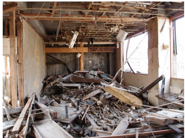
写真 3-18-3-4 建物内部の被災状況
