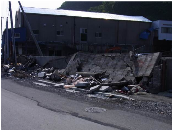
写真 3-13-18-1 CB 塀の転倒の様子
