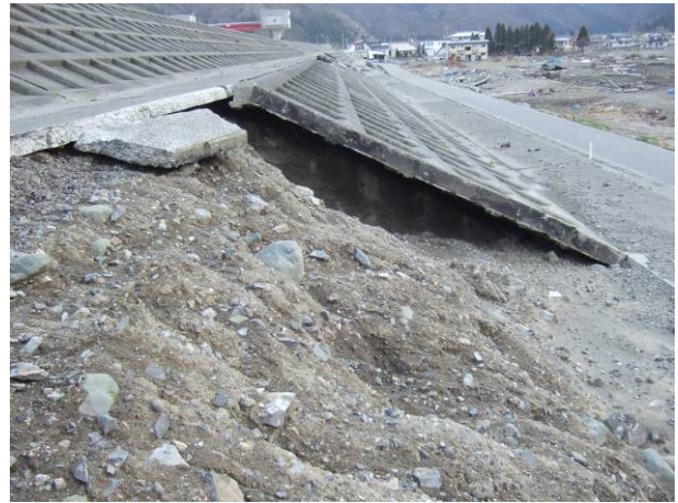
写真 3-8-2-2 堤体法面および下部の土が流出
