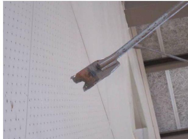
写真 3-32-2-14 妻壁側の屋根ブレース破断
