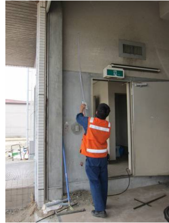
写真 3-30-22-4 建物内壁の水痕
