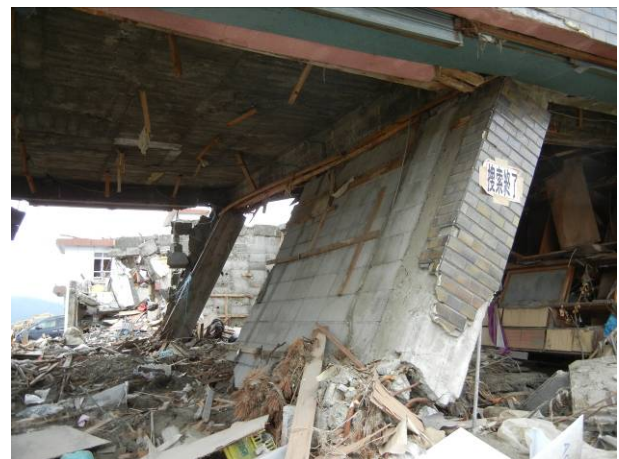
写真 3-15-4-4 両端降伏した柱
