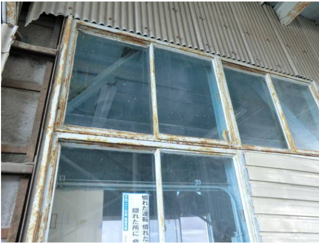
写真 3-2-6-3 工場外壁側面の水痕
