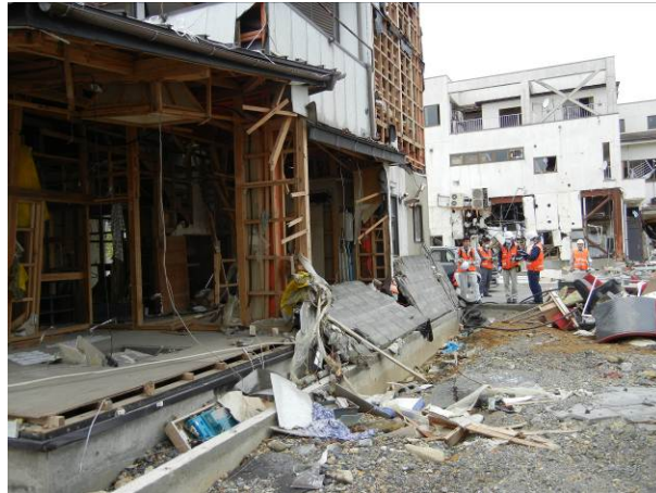
写真 3-14-22-1 CB 塀の転倒の様子
