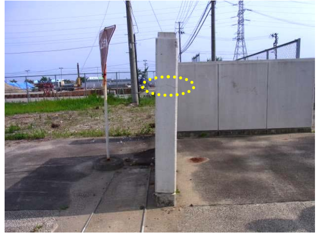
写真 3-25-7-2 塀の傾斜とひび割れ
