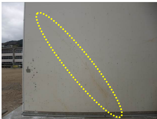
写真 3-14-4-7 壁に曲げひび割れ多数発生
