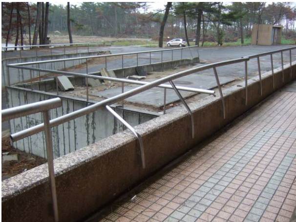
写真 3-30-6-1 曲げ変形した手摺り綱管
