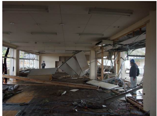
写真 3-14-1-4 教室棟 3階の被害の様子
