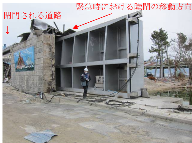
写真 3-11-1-1 残留した防潮堤と流出した防潮堤跡
