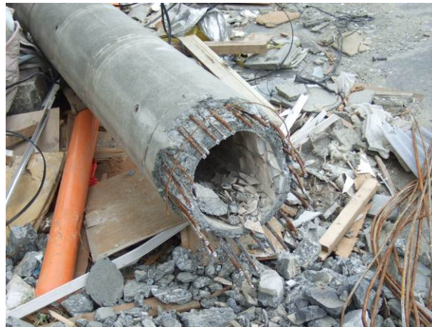
写真 3-14-7-1 電柱の被害の様子
