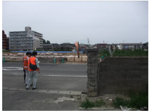
写真 3-24-1-4 CB 塀直前の河川堤防が決壊
