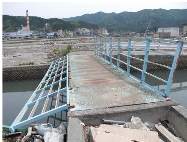
写真 3-14-10-1 橋手すり1の被害の様子
