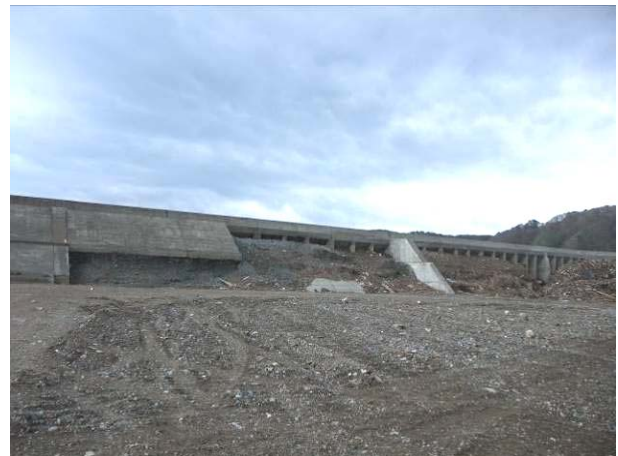
写真 3-9-1-2 堤体法面および下部の土が流出
