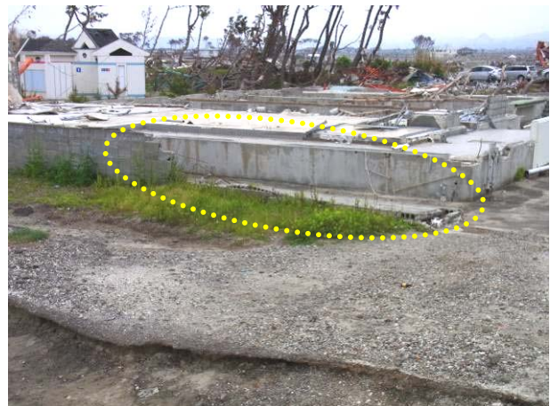
写真 3-26-1-2 CB 塀の転倒
