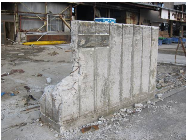
写真 3-19-7-3 一部破損するも残存したRC塀
