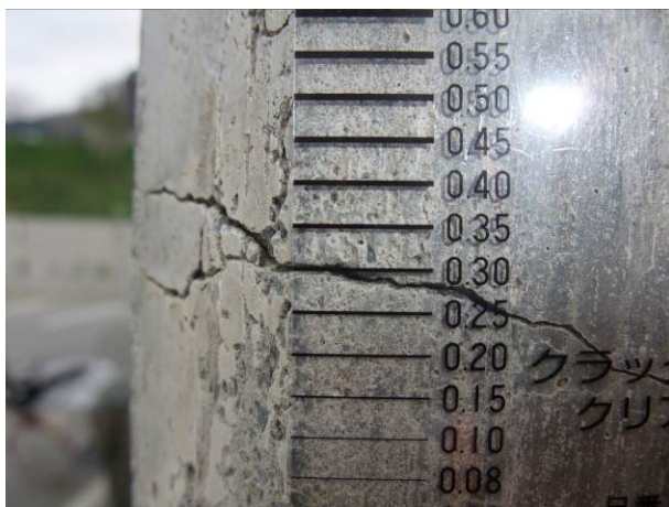
写真 3-14-4-5 柱に曲げひび割れ多数発生
