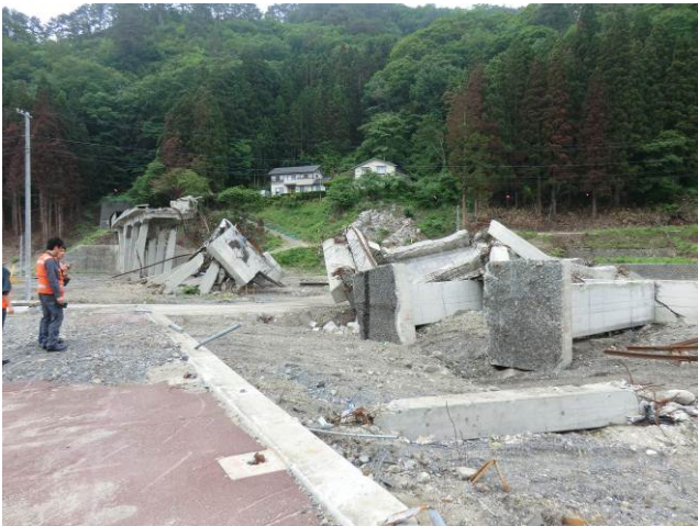
写真 3-7-6-1 島越駅の転倒した鉄道橋
