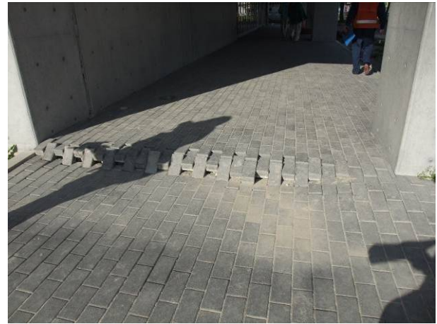
写真 3-13-23-6 建物周囲地盤の沈下
