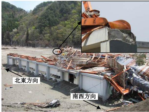
写真 3-13-6-2 屋内体育館の損傷状況
