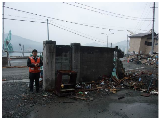
写真 3-13-16-2 CB塀の様子
