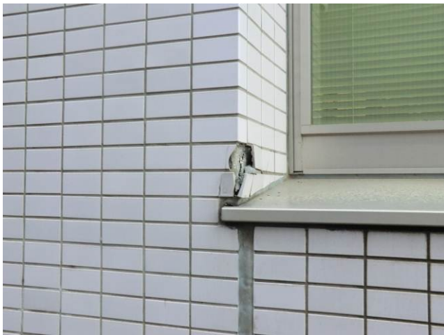
写真 3-2-11-1 仕上げタイルの剥落
