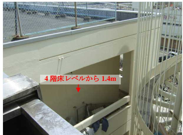
写真 3-17-4-2 建物側面からの浸水深
