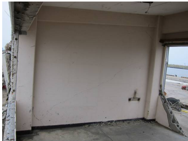
写真 3-27-3-1 ひび割れが生じた RC 内壁
