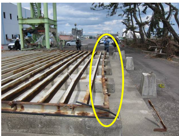
写真 3-25-1-1 曲げ変形を生じた鉄骨材
