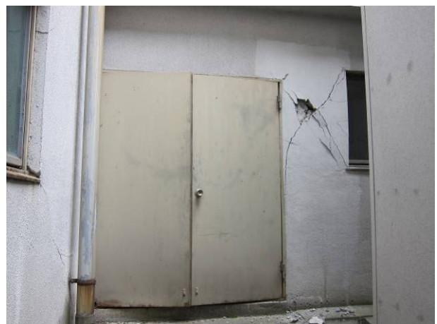
写真 3-32-3-2 雑壁にせん断ひび割れ
