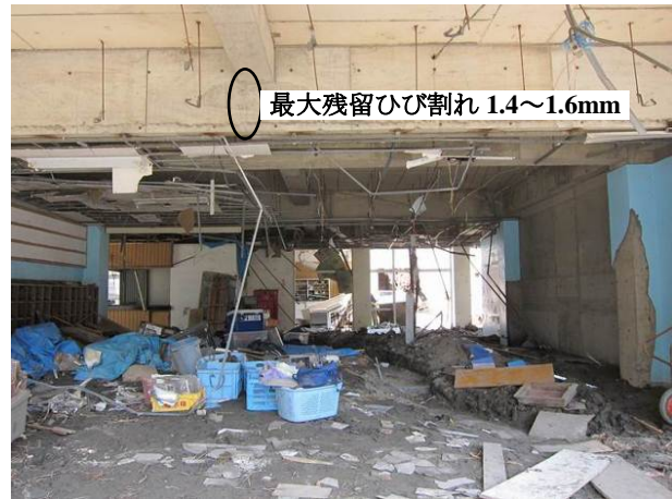
写真 3-13-6-5 管理棟の被害状況
