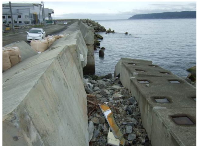
写真 3-3-6-2 転倒した堤防
