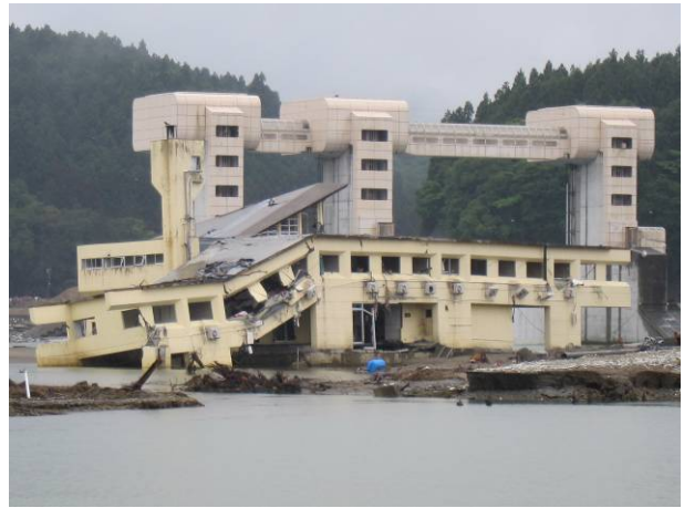
写真 3-15-9-2 洗掘により損傷したレストラン
