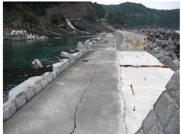
写真 3-7-2-2 堤防の転倒跡
