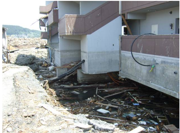
写真 3-17-3-2 基礎部の洗掘の様子
