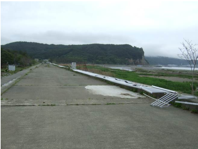
写真 3-3-2-1 転倒したフェンス
