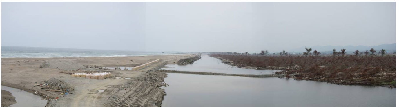
写真 3-30-23-4 水門南の防潮堤破堤と防潮林傾斜
