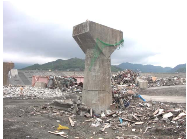
写真 3-12-5-2 曲げひび割れの入った橋脚
