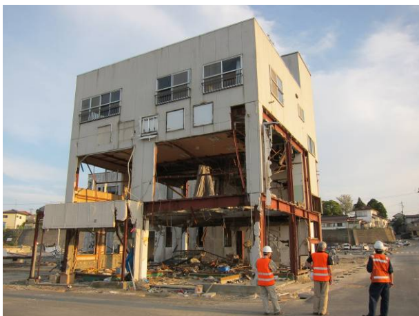
写真 3-31-5-1 MH 旅館の北東（受圧）面
