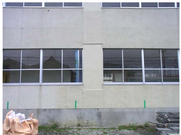
写真 3-32-1-6 校舎北側せん断破壊した柱（補修中）
