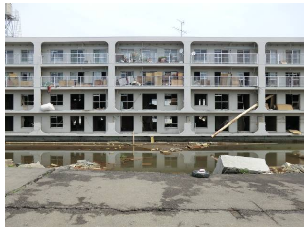
写真 3-19-1-2 2 階のベランダ手すりまで破壊
