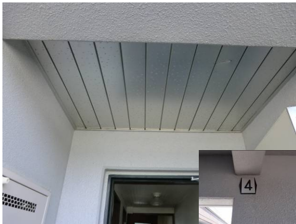
写真 3-17-3-3 4階の玄関上部の津波の痕跡
