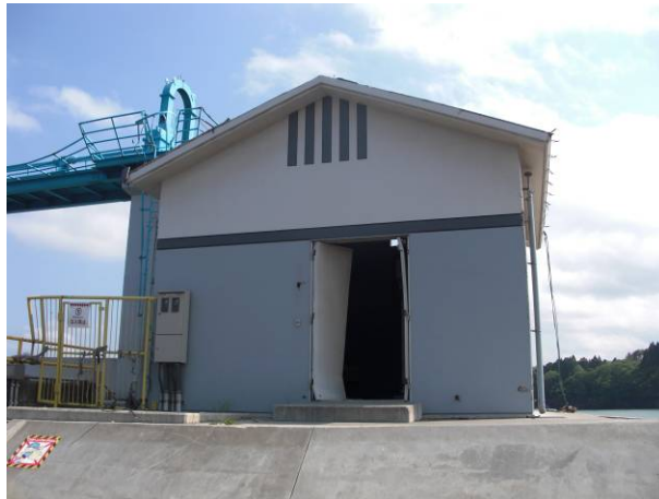
写真 3-17-7-3 軽微な建物の被害状況（湾西端の河口位置）
