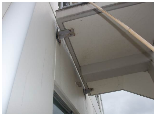
写真 3-14-4-8 外付け階段室の定着ボルト脱落
