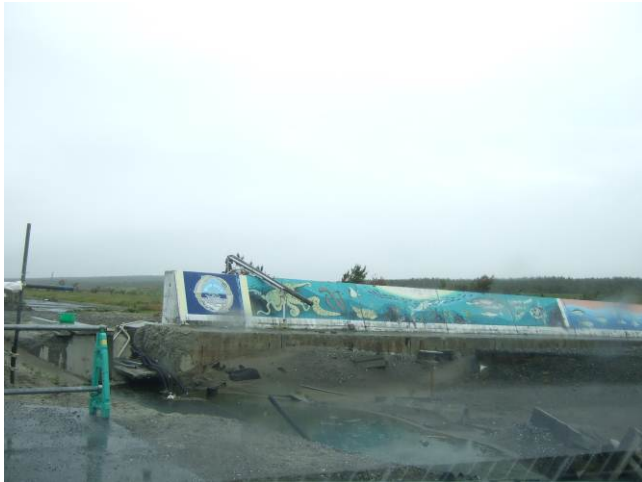
写真 3-1-site1-1 三沢漁港の洗掘
