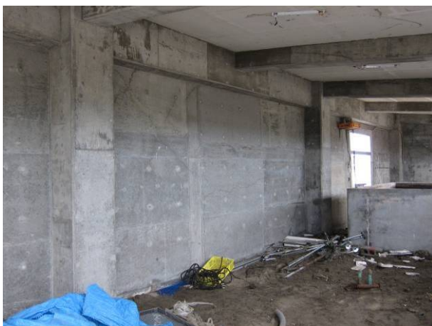
写真 3-27-2-2 ひび割れが生じた RC 外壁
