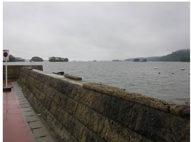
写真 3-21-site1-2 越流した防潮堤
