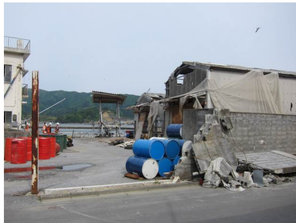
写真 3-14-26-1 CB 塀の損傷状況
