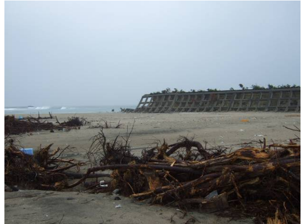
写真 3-30-7-2 高瀬浜砂近傍の破堤した堤防
