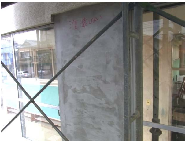
写真 3-32-1-5 校舎北側せん断破壊した柱（補修中）
