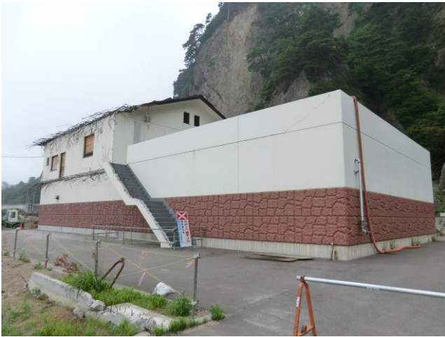
写真 3-3-7-1 建物被害状況
