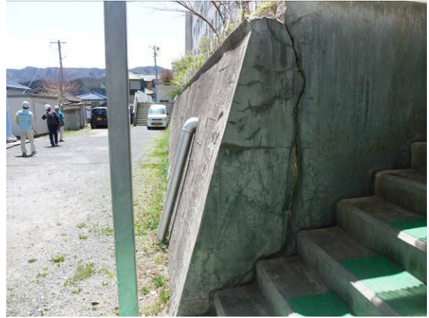
写真 3-13-20-4 擁壁の損傷状況
