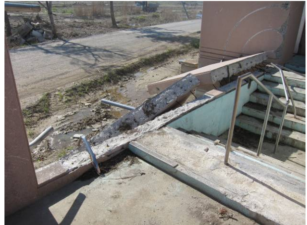
写真 3-30-17-4 転倒した南北方向の塀
