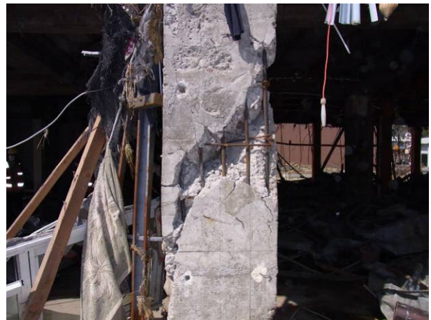
写真 3-18-8-2 せん断破壊した柱
