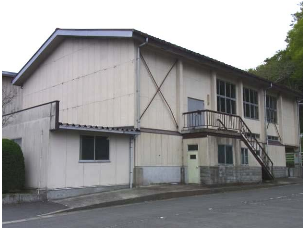
写真 3-32-3-3 武道館の壁面ブレース座屈
