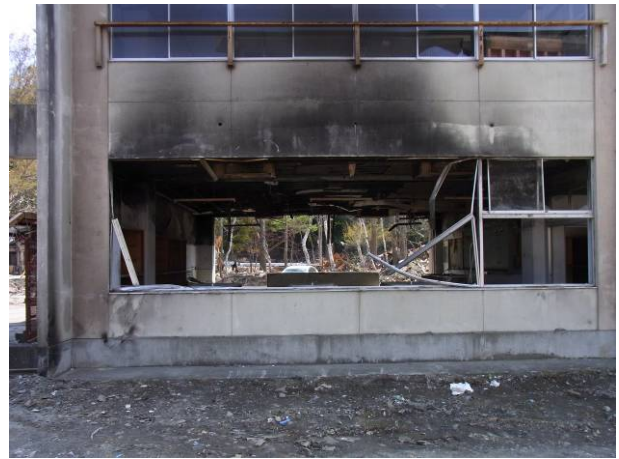
写真 3-12-1-4 津波衝突物による火災跡
