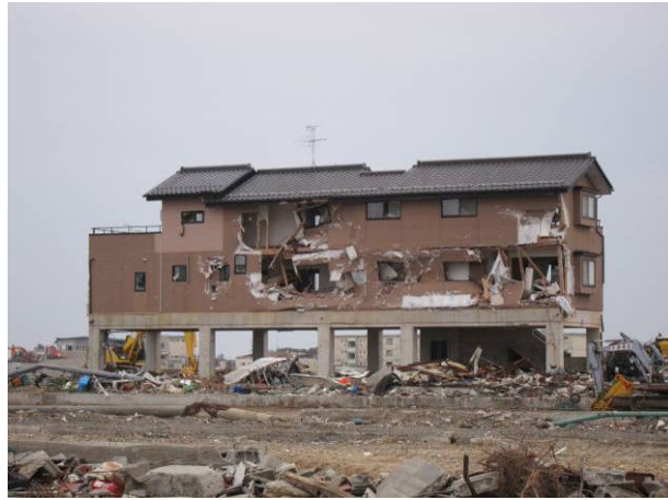
写真 3-27-7-1 衝突被害を受けた3層建物
