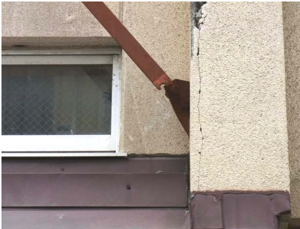
写真 3-32-3-5 壁面ブレースの破断
