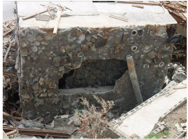
写真 3-18-4-2 底面（折損した杭が見える）
