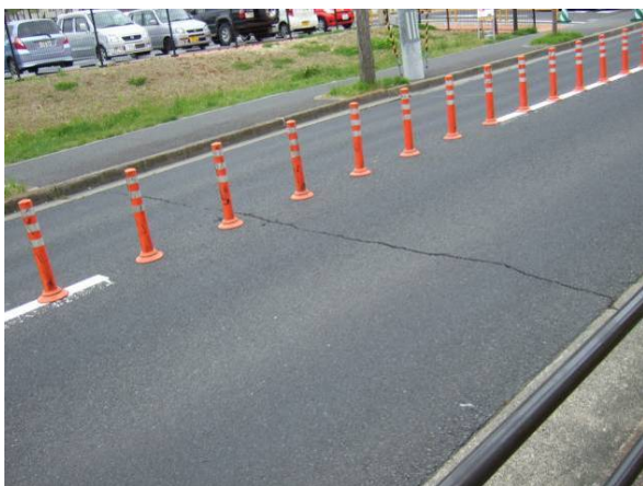
写真 3-33-1-3 周辺道路に亀裂
