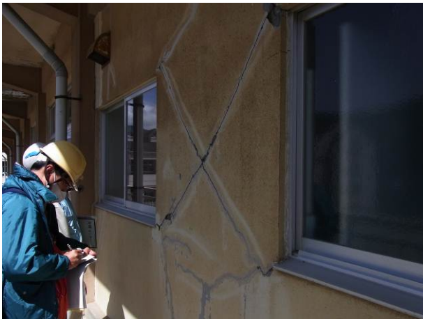
写真 3-13-19-3 雑壁の損傷状況
