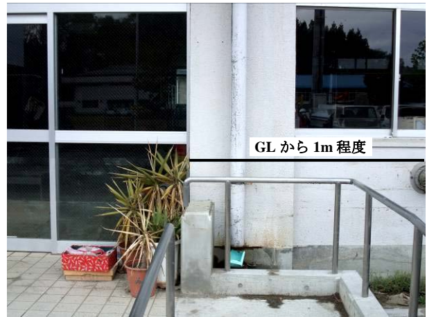
写真 3-9-2-4 浸水深は約1m
