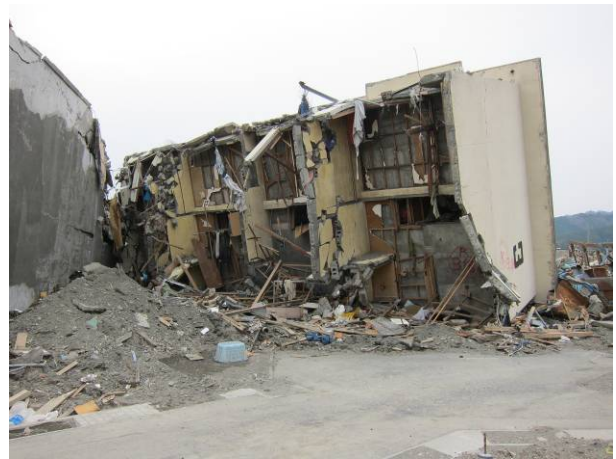
写真 3-12-3-2 転倒住宅 (3号棟)
