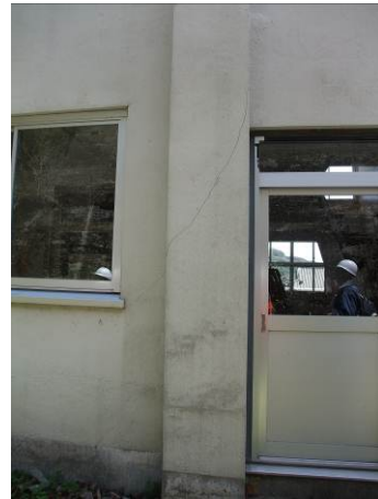
写真 3-13-20-2 柱の損傷状況
