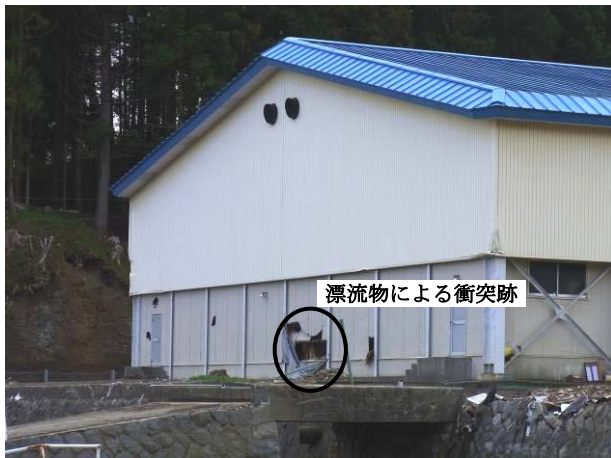
写真 3-9-2-5 体育館妻壁に漂流物の衝突跡
