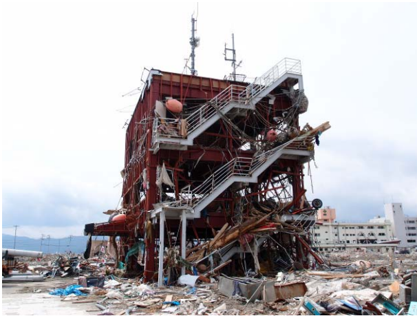
写真 3-17-1-3 防炎対策庁舎の被害状況（北側）
