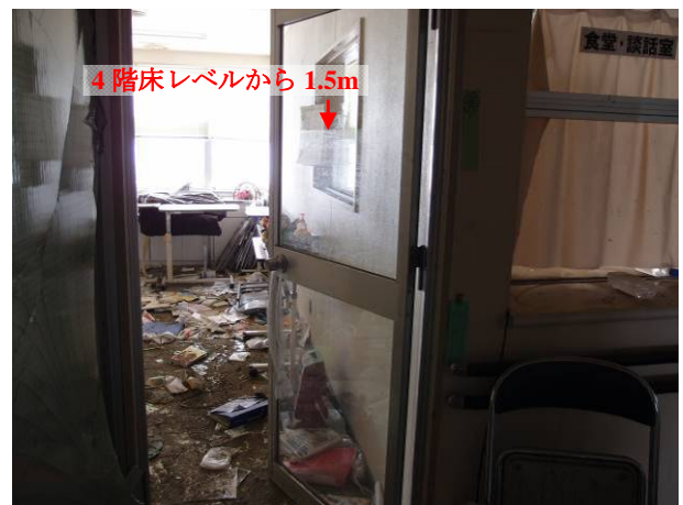
写真 3-17-4-4 建物内壁・ガラスからの浸水深
