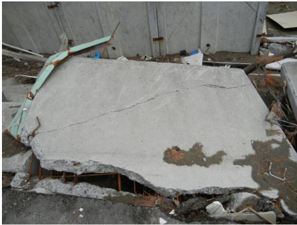
写真 3-19-2-1 転倒した擁壁
