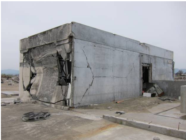
写真 3-29-1-1 大破した受圧面と降伏した側面
