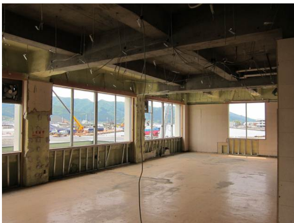
写真 3-14-16-3 2階の被害の様子
