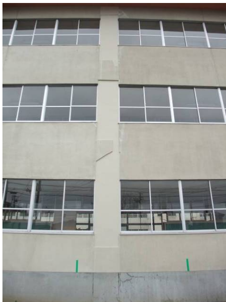
写真 3-32-1-7 校舎北側せん断破壊した柱（補修中）
