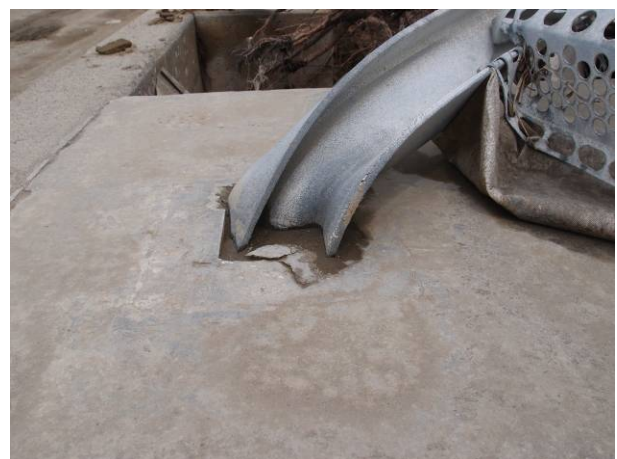
写真 3-19-3-4 フェンス支柱の座屈
