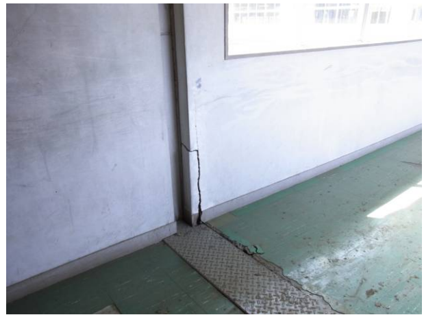
写真 3-12-1-6 渡り廊下棟の損傷
