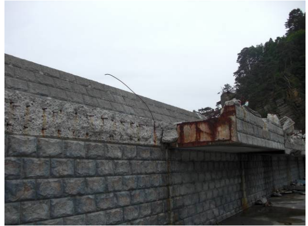
写真 3-7-4-2 崩壊したスラブ
