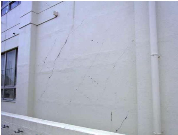
写真 3-33-2-5 壁に生じたせん断ひび割れ
