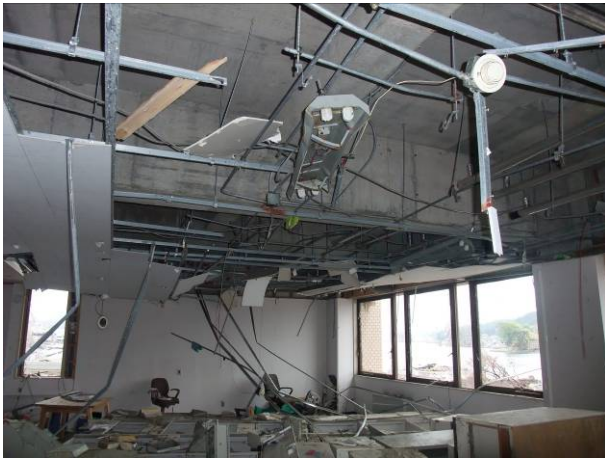
写真 3-16-4-3 建物内部の被災状況
