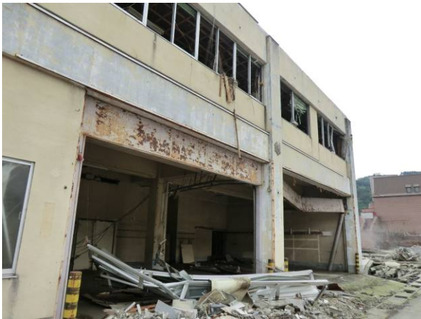
写真 3-18-9-5 東立面シャッター上部が室内側に湾曲
