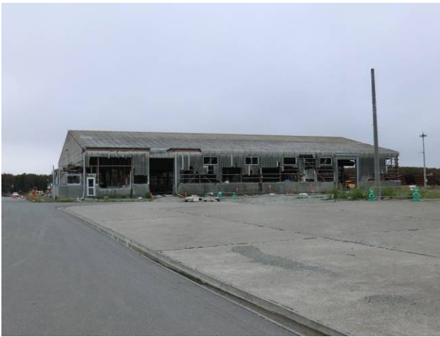
写真 3-1-3-3 S 造建物被害状況
