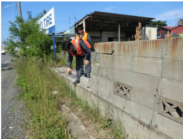
写真 3-2-8-1 CB 塀の残留部分
