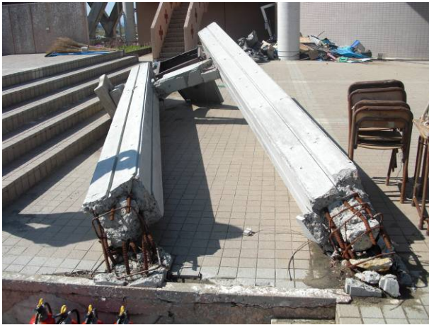
写真 3-30-16-1 転倒した RC 柱時計台
