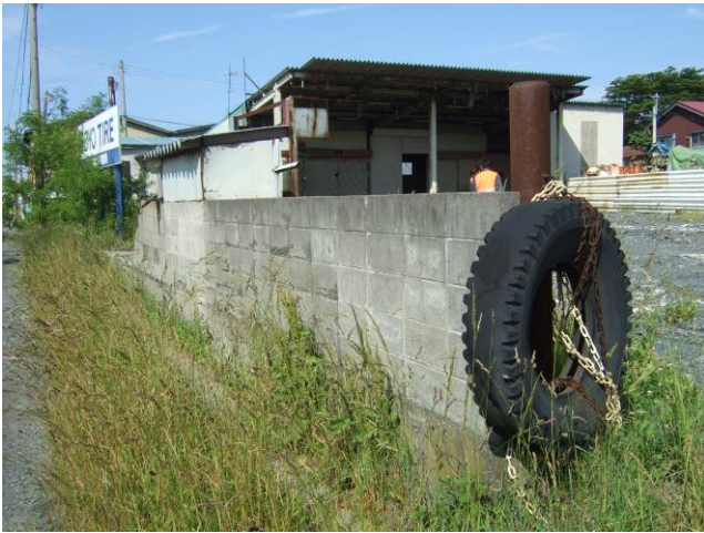
写真 3-2-8-3 CB 塀残留部分全景
