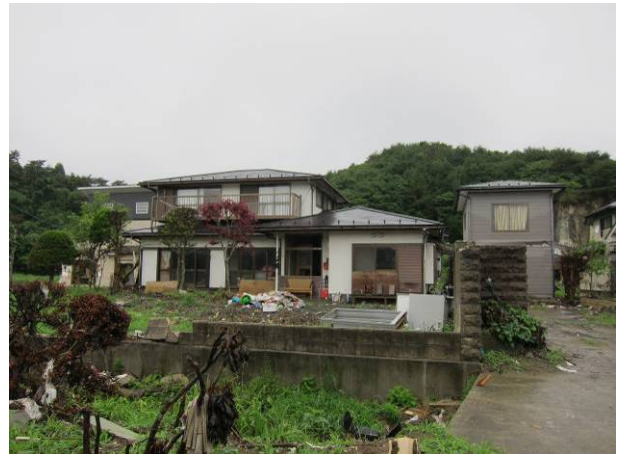
写真 3-20-site2-2 外壁に軽微な損傷があった木造住宅
