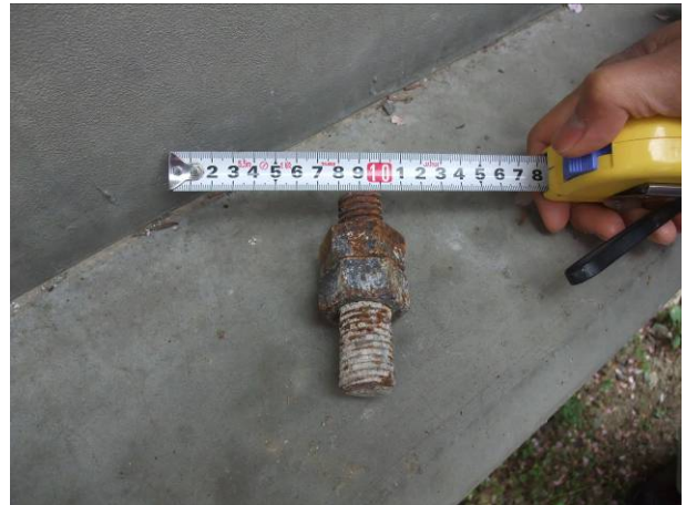
写真 3-32-2-10 破断したアンカーボルト M19
