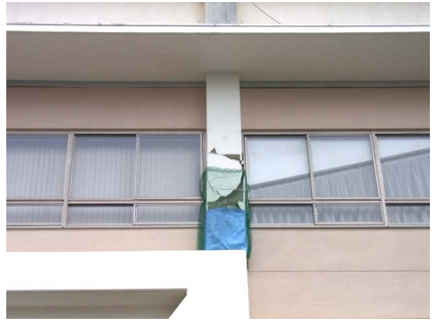
写真 3-22-4-4 非補強階の柱にせん断ひび割れ
