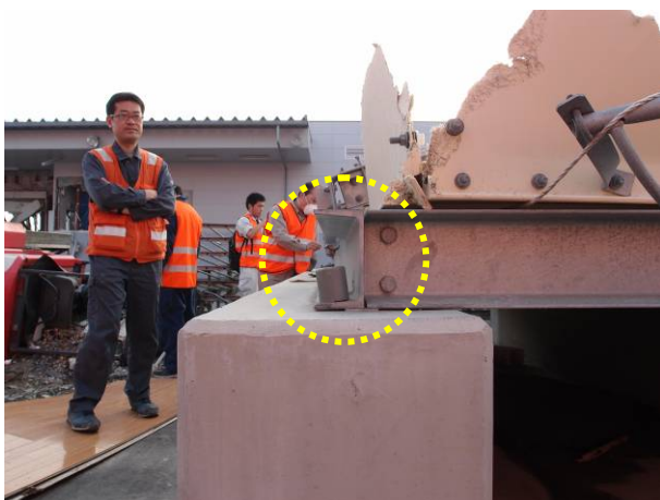
写真 3-19-5-3 支柱基部のチャンネル鋼
