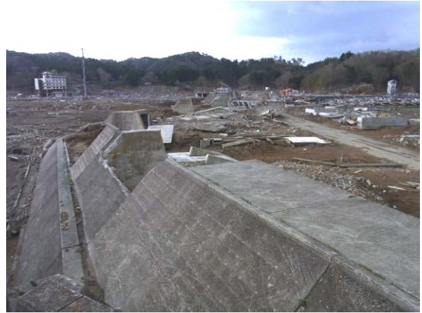
写真 3-9-1-4 防潮堤自体が津波で破壊された箇所
