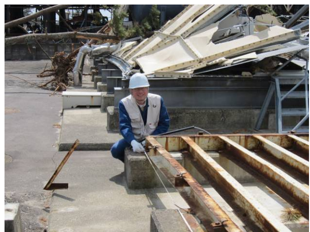
写真 3-25-1-2 曲げ変形を生じた鉄骨材の受圧面
