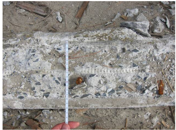
写真 3-19-8-2 破断した鉄筋
