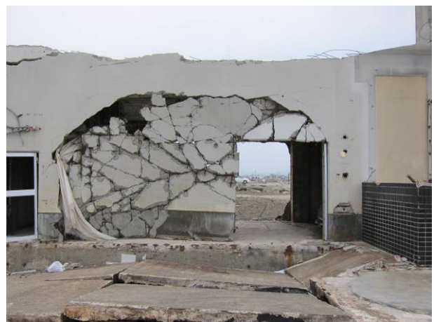
写真 3-27-2-3 崩壊した RC 外壁
