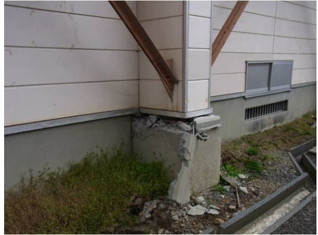
写真 3-32-2-6 体育館柱脚部の震動被害
