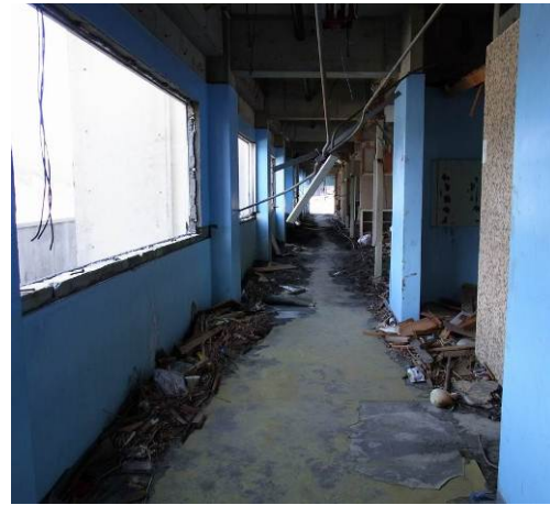
写真 3-13-6-3 普通教室棟 3階の被害状況
