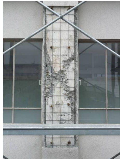
写真 3-32-3-8 せん断破壊した柱
