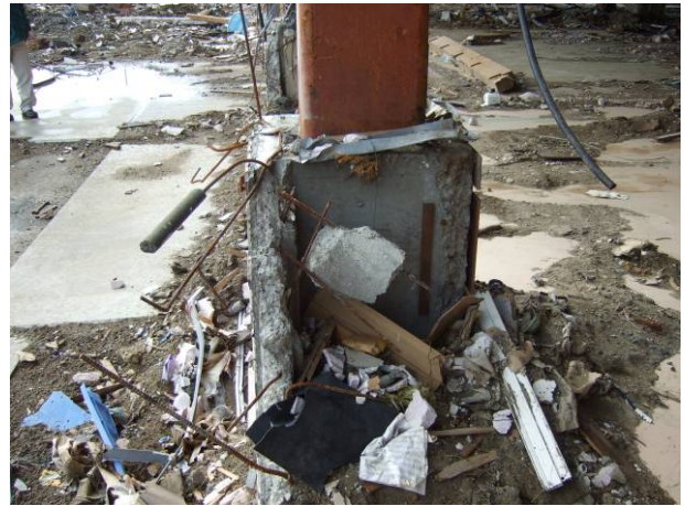
写真 3-9-3-4 受圧面の雑壁破壊
