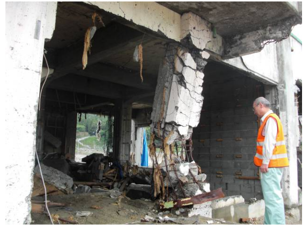
写真 3-9-4-2 漂流物の衝突跡
