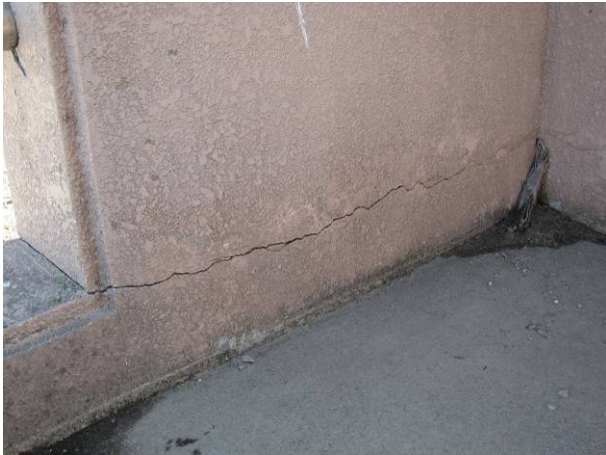
写真 3-30-17-3 直交壁を有する塀のひび割れ
