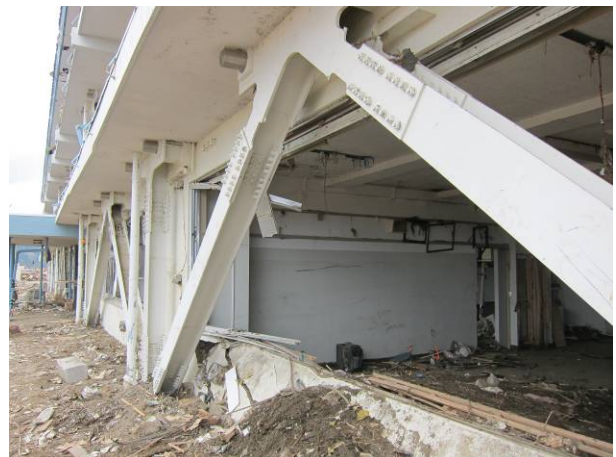
写真 3-15-2-2 教室棟に設置されたブレース
