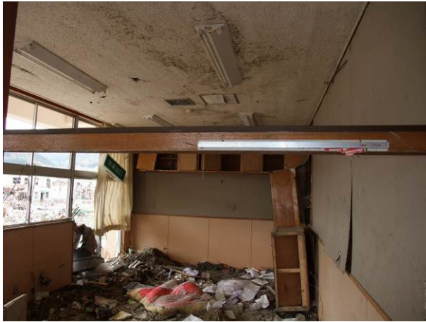
写真 3-13-5-2 建物内部の被害の様子
