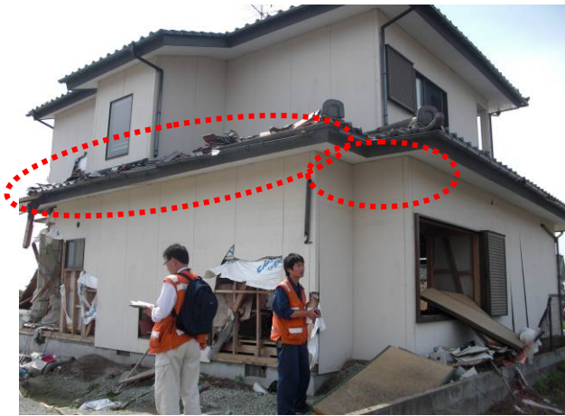
写真 3-30-20-5 側面の瓦破損と背面の痕跡
