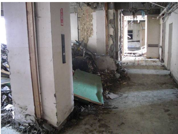
写真 3-17-4-3 建物内部の被害状況
