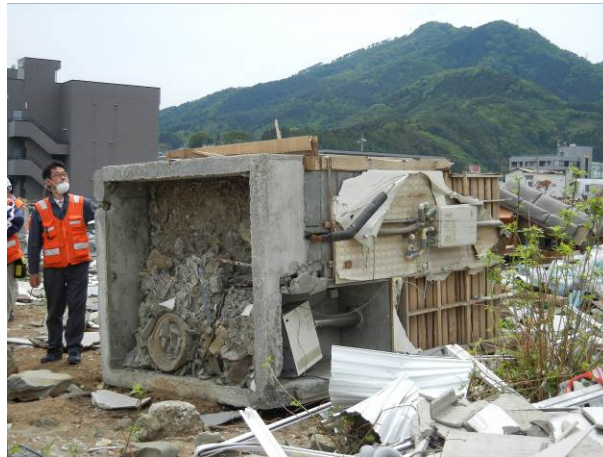
写真 3-14-21-1 転倒した構造物の様子
