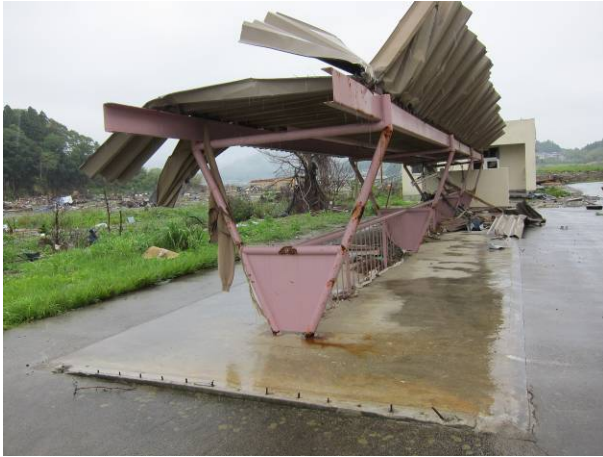
写真 3-15-1-5 RC 塀の流出跡
