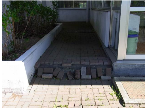
写真 3-13-21-6 建物周囲地盤の沈下2
