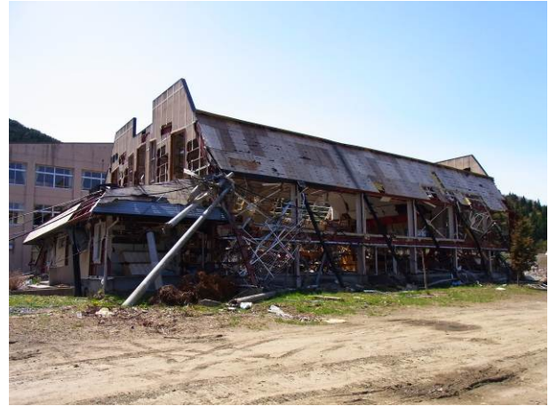
写真 3-13-4-4 屋内体育館の被害の様子
