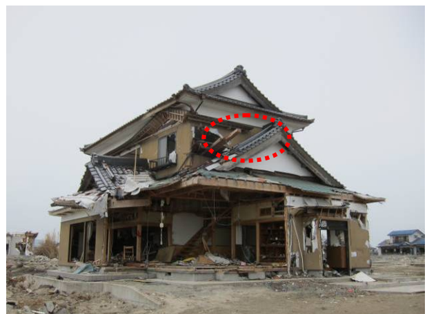
写真 3-29-4-2 受圧面の津波痕跡
