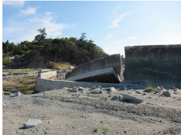
写真 3-30-18-1 傾斜した堤防
