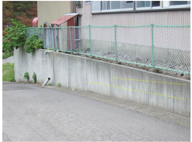
写真 3-6-1-4 浮遊物による傷痕
