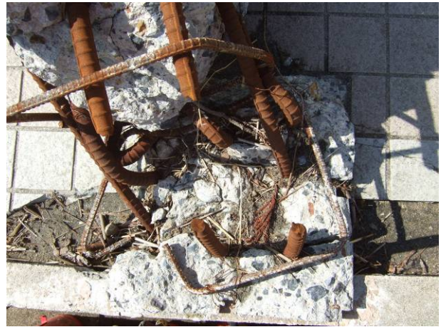
写真 3-30-16-2 崩壊した断面
