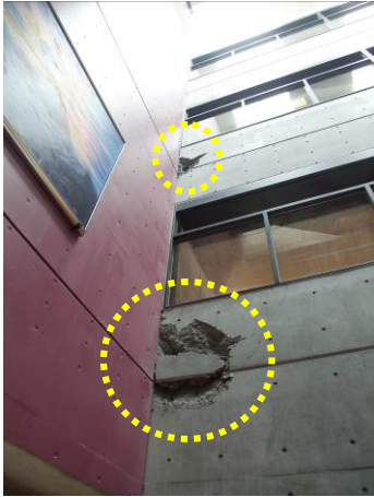
写真 3-13-23-3 非構造壁端部にひび割れ・剥落発生
