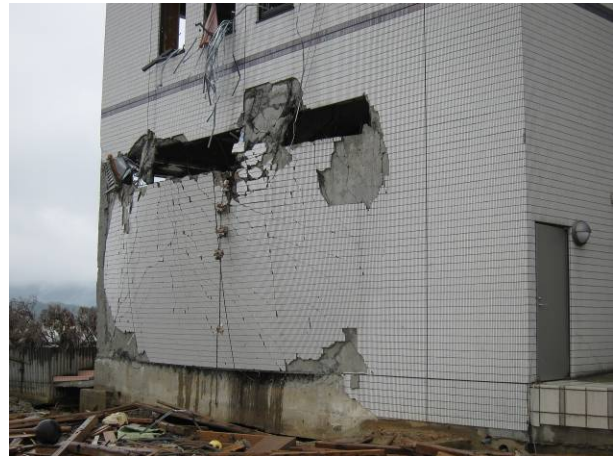
写真 3-15-8-2 曲げ破壊した RC 壁
