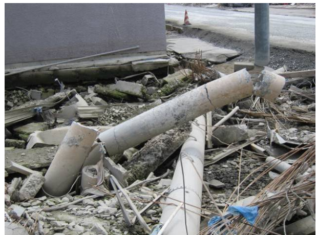
写真 3-18-4-6 引き抜けた杭の残骸
