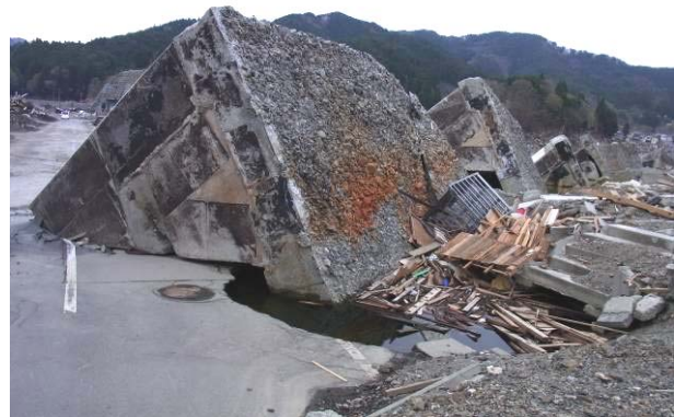
写真 3-12-4-2 転倒した防潮堤
