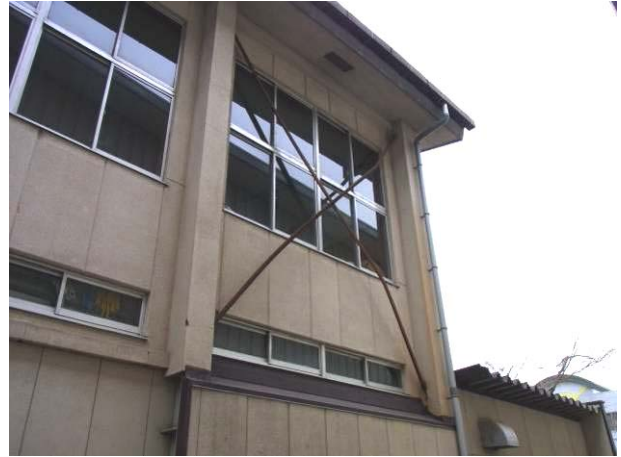
写真 3-32-3-4 壁面ブレースの座屈
