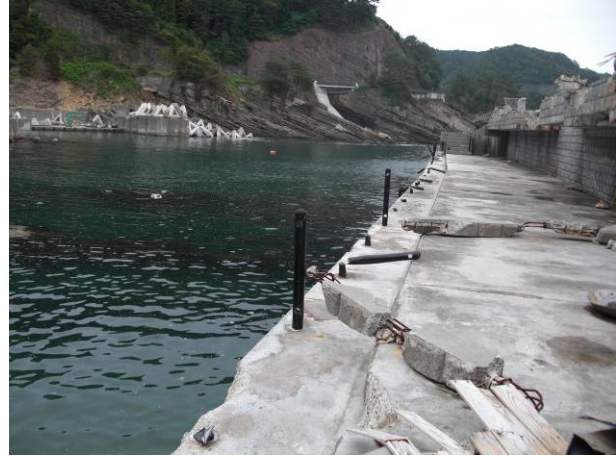
写真 3-7-3-2 崩壊した堤防手摺り
