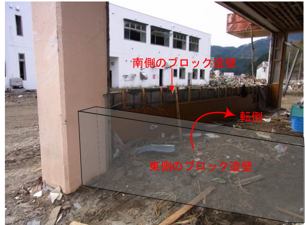
写真 3-13-5-3 ブロック造壁の被害
