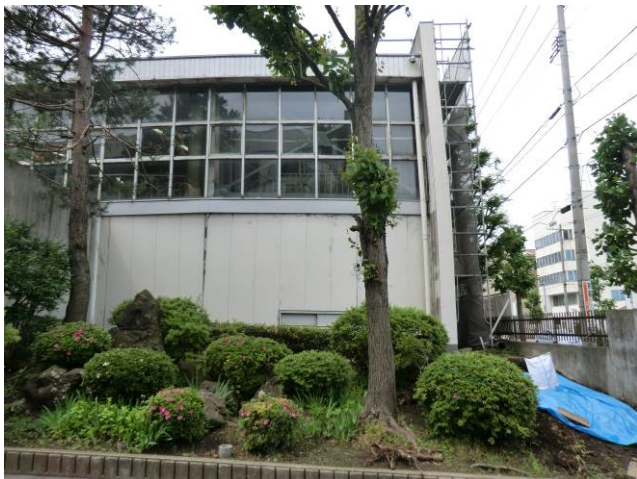
写真 3-2-17-1 地盤沈下と講堂の傾斜
