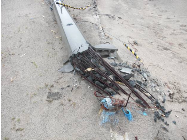
写真 3-30-7-1 転倒した電柱
