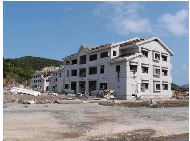
写真 3-17-5-2 建物の被害状況
