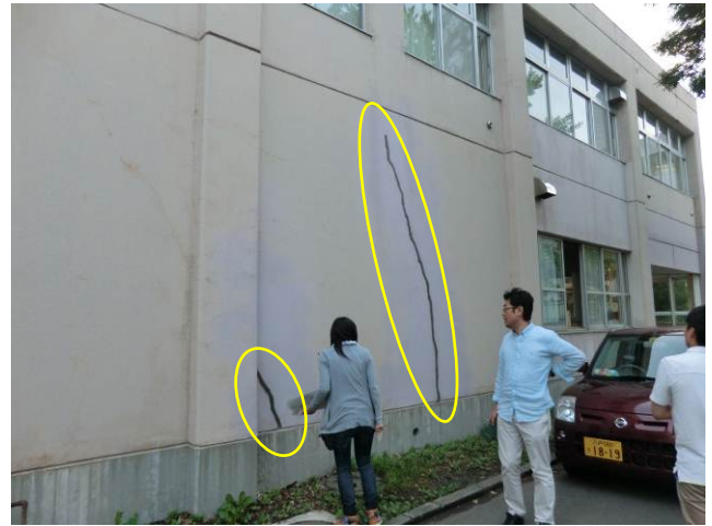
写真 3-2-11-4 外壁ひび割れ補修跡
