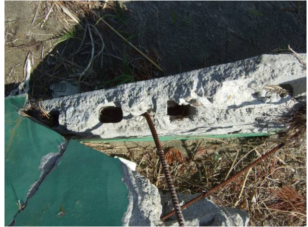
写真 3-30-15-2 崩壊した断面
