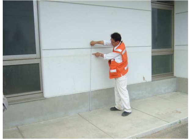
写真 3-29-9-2 亙理町立荒浜小学校の津波痕跡
