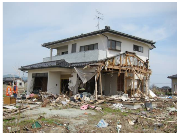
写真 3-30-20-6 受圧面の損傷
