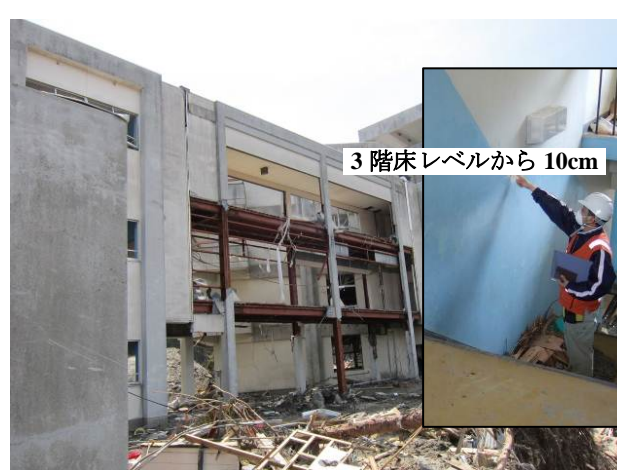
写真 3-13-6-7 普通教室棟と特別教室棟の渡り廊下外壁の流失
