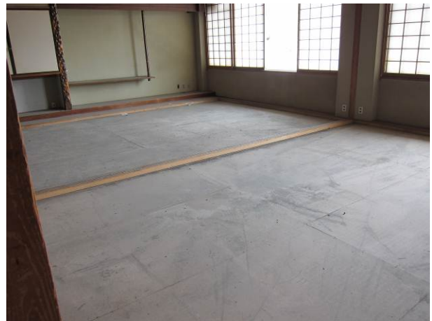
写真 3-14-16-2 3階の被害の様子
