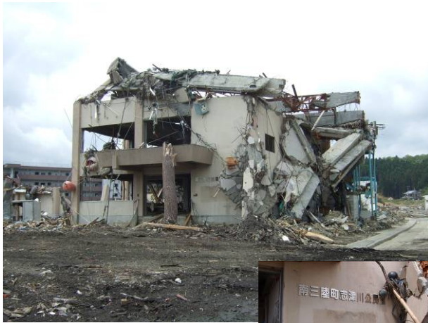
写真 3-17-2-1 志津川公民館の全景および被害状況
