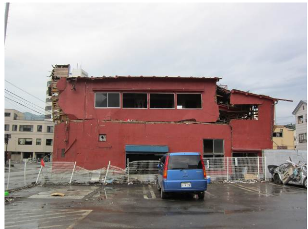
写真 3-13-13-2 受圧面と直交方向の建物の様子
