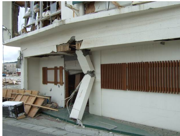
写真 3-14-8-1 CB柱の被害の様子
