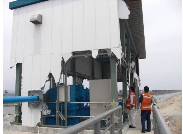
写真 3-30-23-2 受圧面，側面の ALC 板破損
