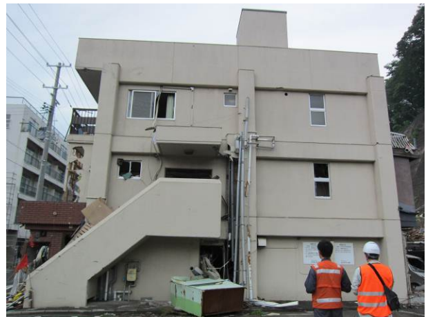
写真 3-13-15-2 受圧面と直交方向の建物の様子
