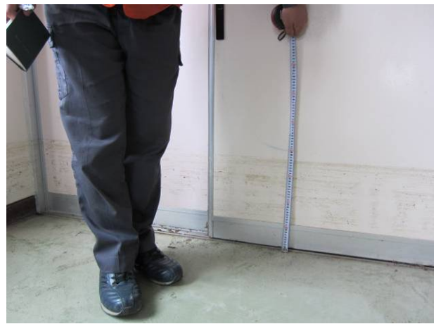
写真 3-26-2-2 校舎2階で浸水深の計測
