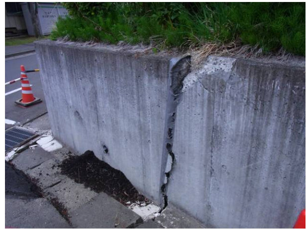
写真 3-33-3-6 コーキング材では補修しきれない
