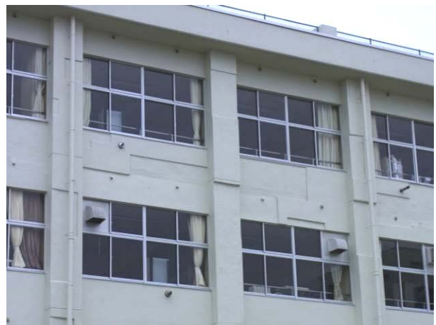
写真 3-33-2-2 柱・腰壁に多数の補修跡が見られる
