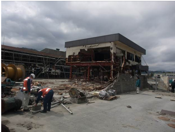
写真 3-14-6-1 CB 塀の被害の様子
