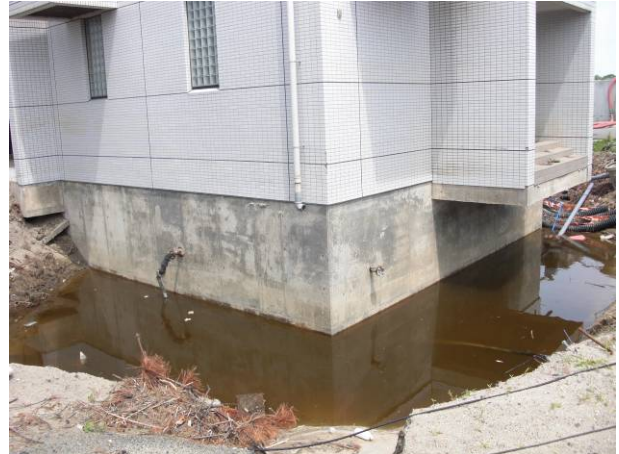
写真 3-30-22-2 海側隅角部の洗掘
