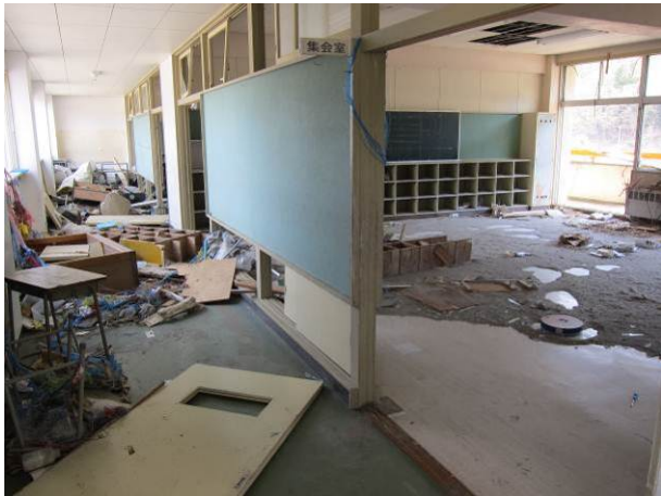
写真 3-13-7-3 3階の損傷状況
