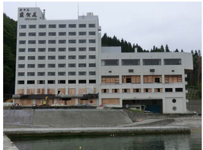
写真 3-7-1-2 窓の破損状況
