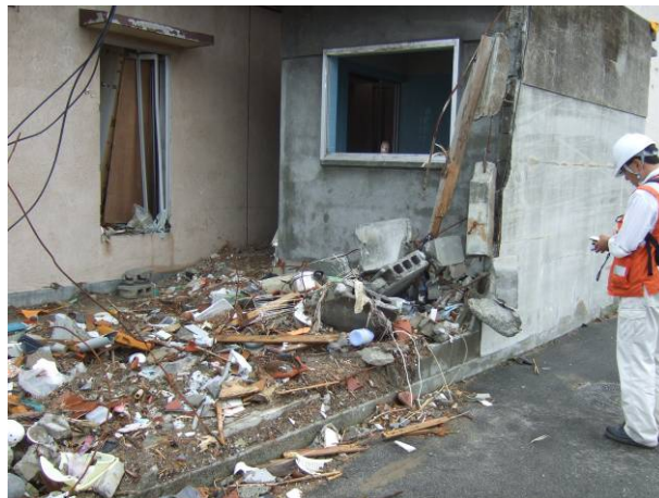
写真 3-30-10-1 転倒した CB 塀の跡
