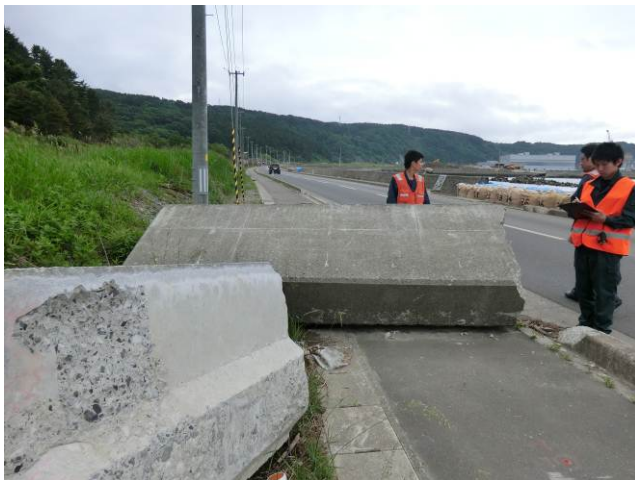
写真 3-3-4-1 転倒した堤防
