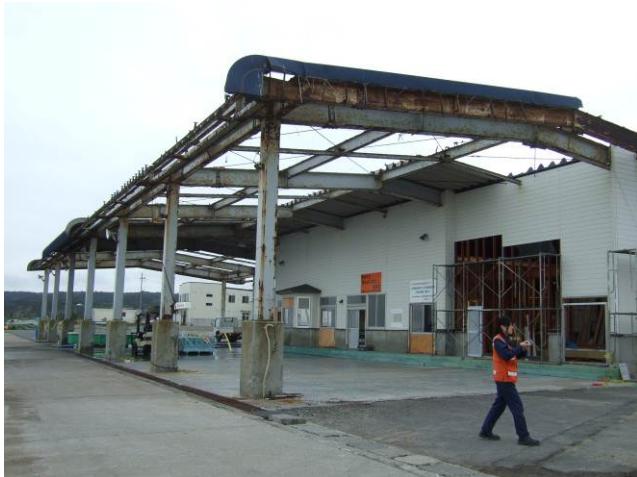
写真 3-5-1-1 屋根材の剥がれた建物
