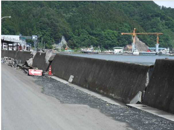
写真 3-13-17-1 堤防の損傷の様子
