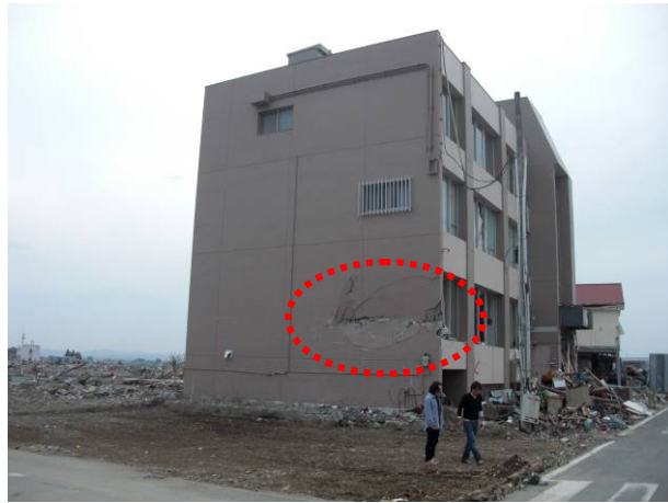
写真 3-27-6-1 衝突被害を受けた3層建物
