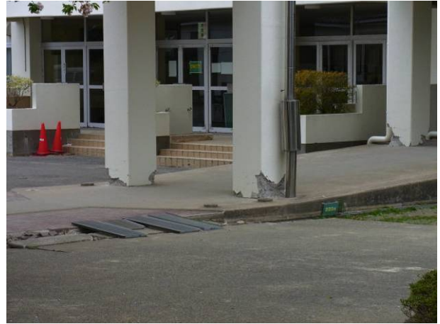
写真 3-33-2-4 柱脚部コンクリートの圧壊
