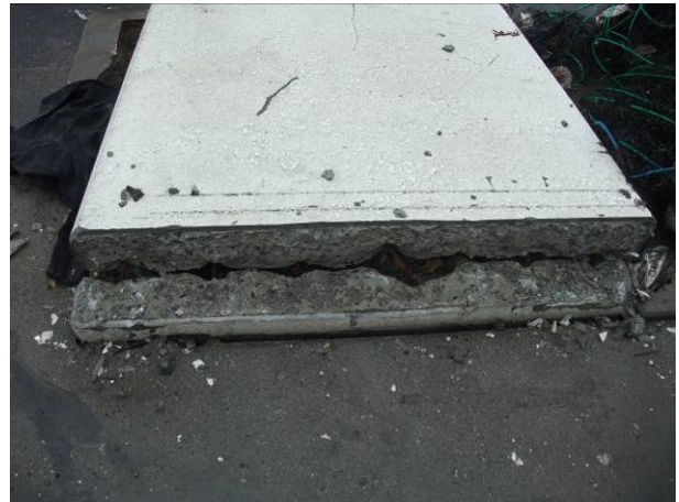
写真 3-16-2-2 転倒した RC 塀の断面
