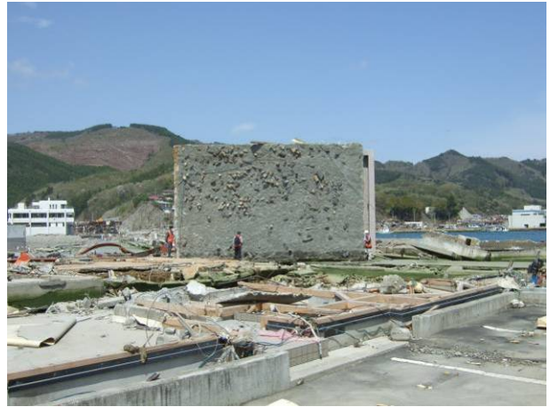
写真 3-18-5-4 海側に転倒している
