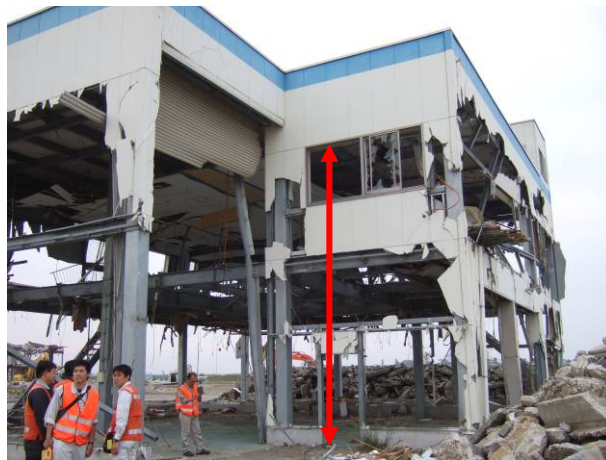
写真 3-27-4-1 浸水深を計測した S 造建物
