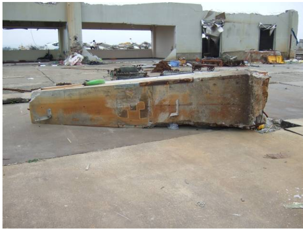
写真 3-27-1-1 転倒した RC 柱
